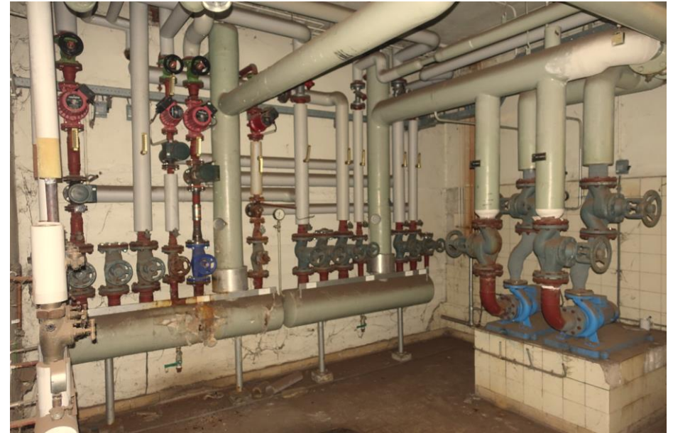
De kelderruimte onder het hoofgebouw met alle waterleidingen.
