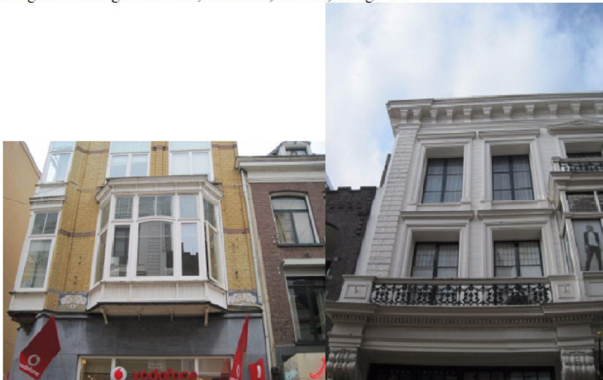
6. Ongesteunde geveldelen, balkons, erkers, dakgoten e.d.
