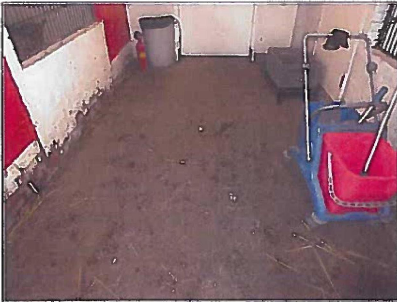
Schade 5, Scheurvorming in betonvloer. (IMG_1148)
