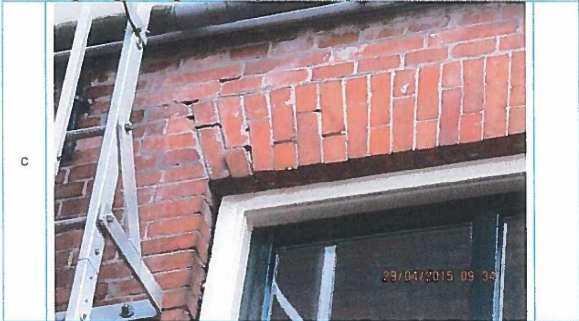
Foto 15. Detail foto 14. "Oude" getrapte scheurvorming in metselwerk, deels ontbreken van voegwerk en losse steen rollaag. Niet significant toegenomen. Geen gerelateerde bevestigingschade.
