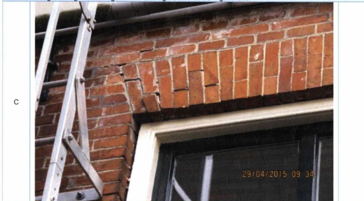
Foto 15. Detail foto 14. "Oude" getrapte scheurvorming in metselwerk, deels ontbreken van voegwerk en losse steen rollaag. Niet significant toegenomen. Geen gerelateerde bevestigingschade.
