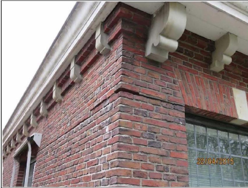
Schade 1, Horizontale scheur in de voeg. (57784 22-4 (48))
