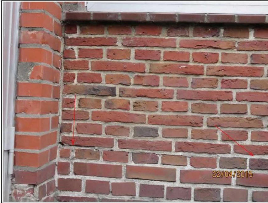
Schade 11, Diverse scheuren in voeg en stenen. (57784 22-4 (130))
