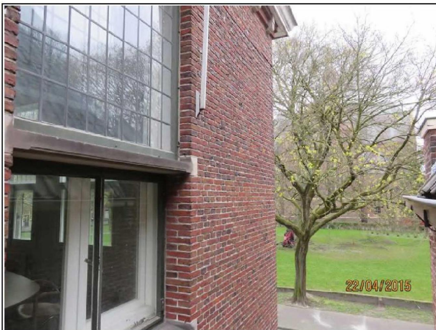
Schade 1, Horizontale scheur in de voeg. (57784 22-4 (62))
