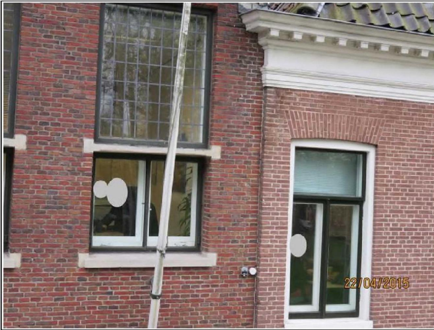
Schade 3, Verticale en horizontale scheuren (57784 22-4 (12))
