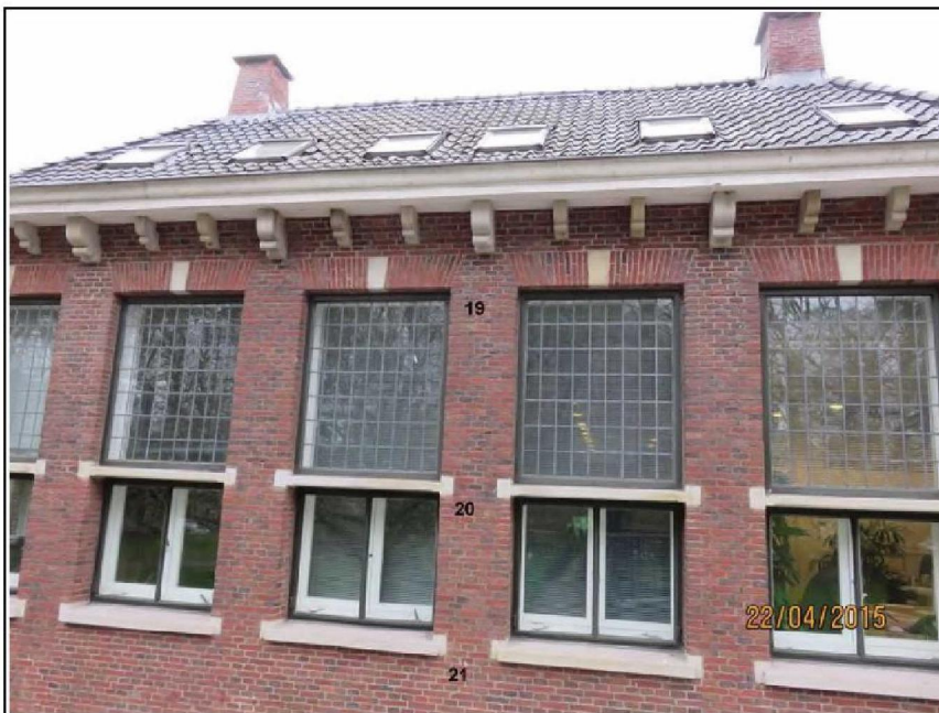
Schade 1, Horizontale scheur in de voeg. (57784 22-4 (17))
