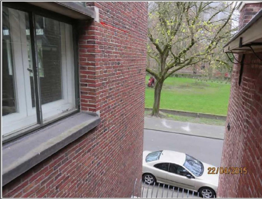
Schade 3, Verticale en horizontale scheuren (57784 22-4 (63))
