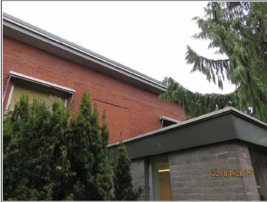
Schade 13, Verticale scheur door voegen en stenen (57784 22-4 (149))
