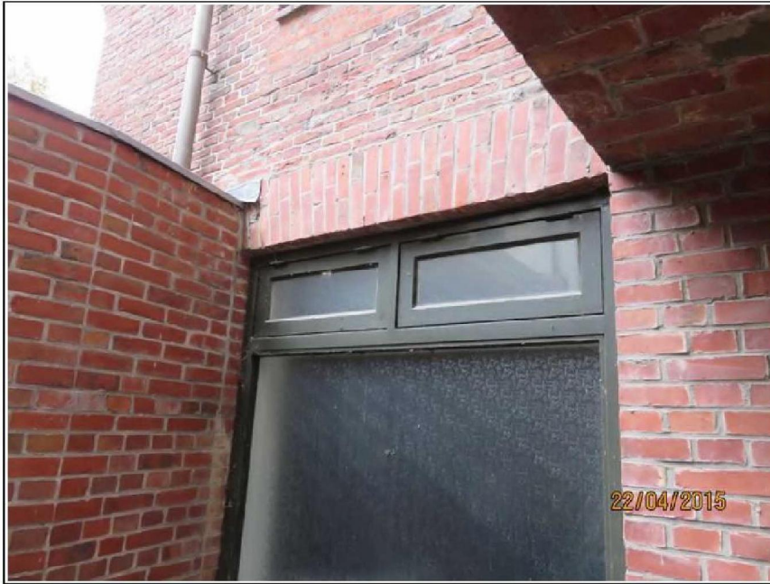
Schade 8, Scheurvorming in metselwerk (57784 22-4 (108))
