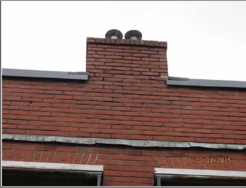
Schade 12, Horizontale scheuren en losse stenen (57784 22-4 (143))
