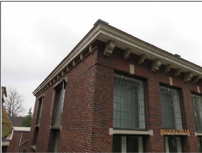
Schade 1, Horizontale scheur in de voeg. (57784 22-4 (45))
