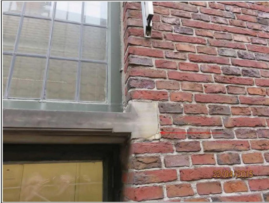
Schade 3, Verticale en horizontale scheuren (57784 22-4 (69))
