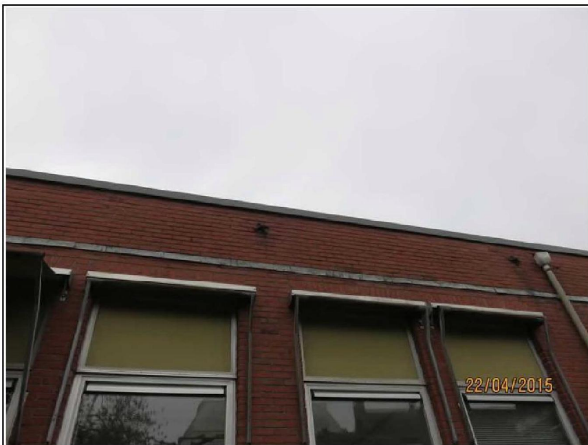
Schade 12, Horizontale scheuren en losse stenen (57784 22-4 (140))
