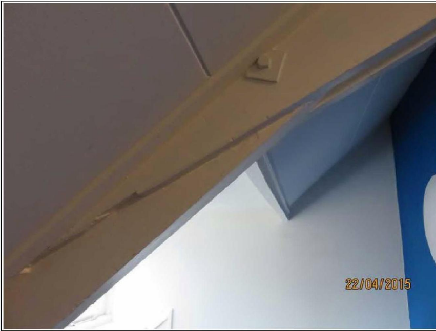
Schade 1, Horizontale scheur in de voeg. (57784 22-4 (205))
