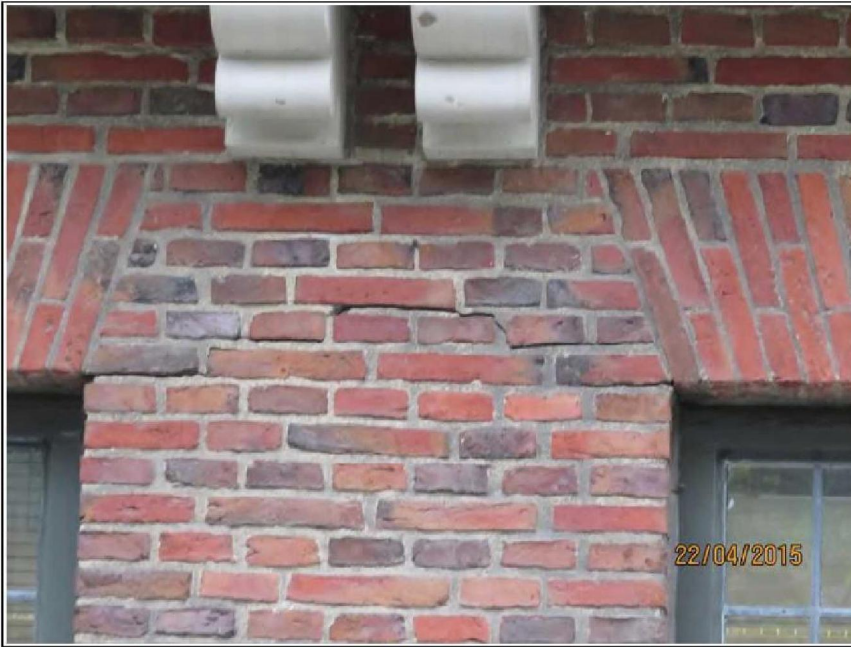
Schade 1, Horizontale scheur in de voeg. (57784 22-4 (11))
