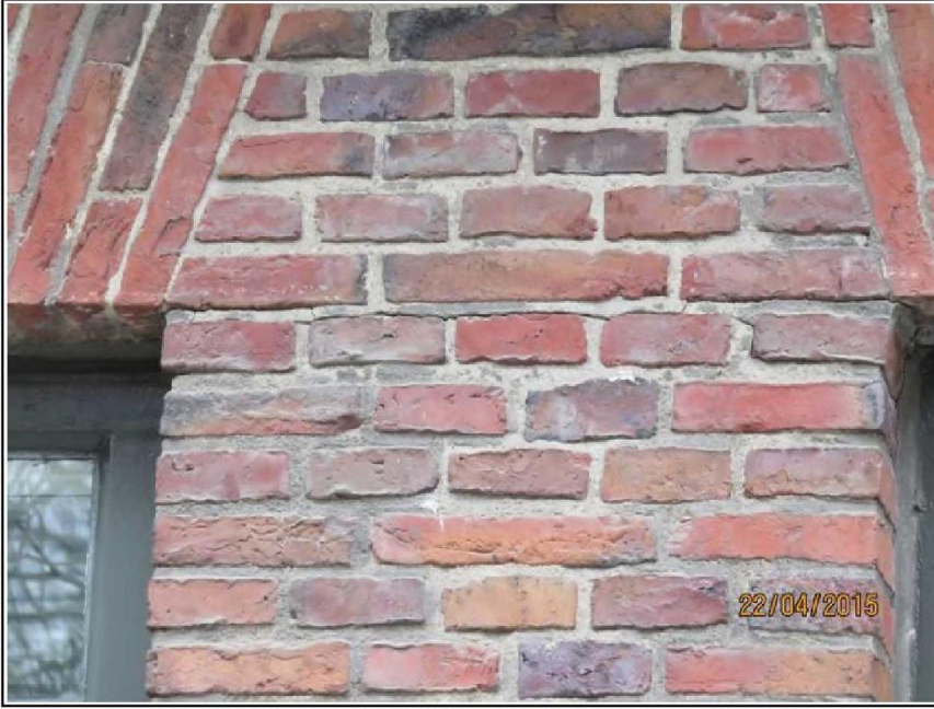
Schade 1, Horizontale scheur in de voeg. (57784 22-4 (19))
