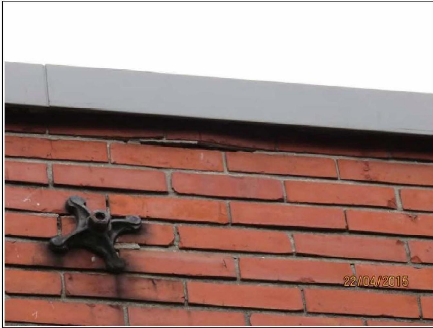
Schade 12, Horizontale scheuren en losse stenen (57784 22-4 (141))
