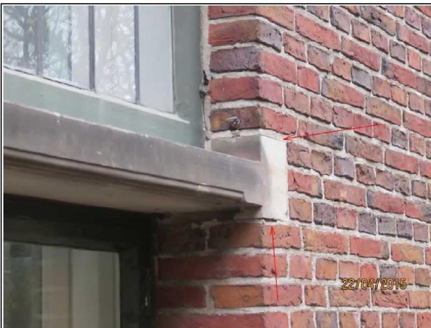
Schade 3, Verticale en horizontale scheuren (57784 22-4 (66))
