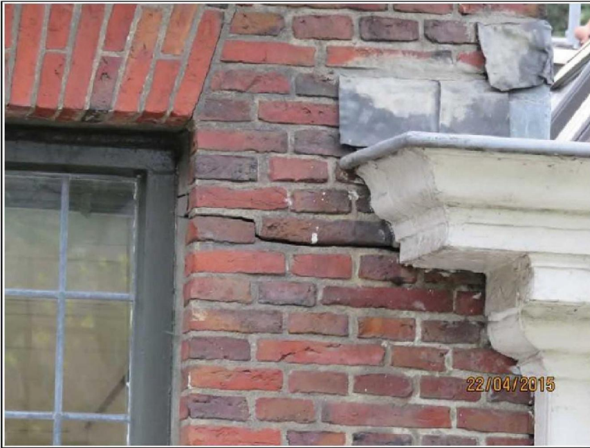
Schade 1, Horizontale scheur in de voeg. (57784 22-4 (7))
