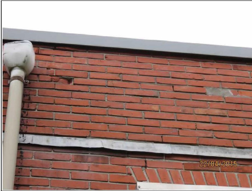
Schade 12, Horizontale scheuren en losse stenen (57784 22-4 (139))
