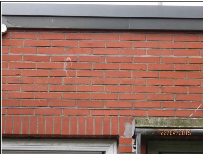
Schade 14, Horizontale scheuren en losse stenen (57784 22-4 (157))
