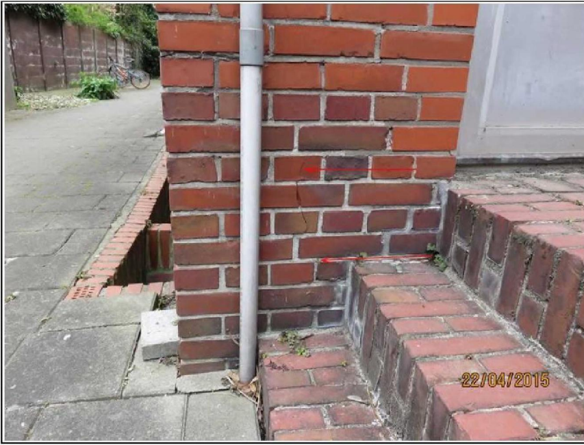
Schade 11, Diverse scheuren in voeg en stenen. (57784 22-4 (128))
