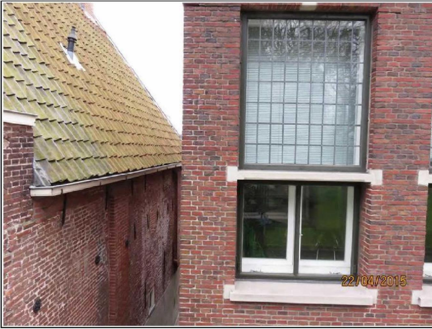
Schade 3, Verticale en horizontale scheuren (57784 22-4 (40))
