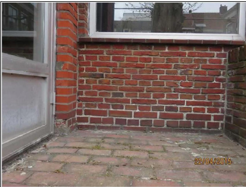
Schade 11, Diverse scheuren in voeg en stenen. (57784 22-4 (129))
