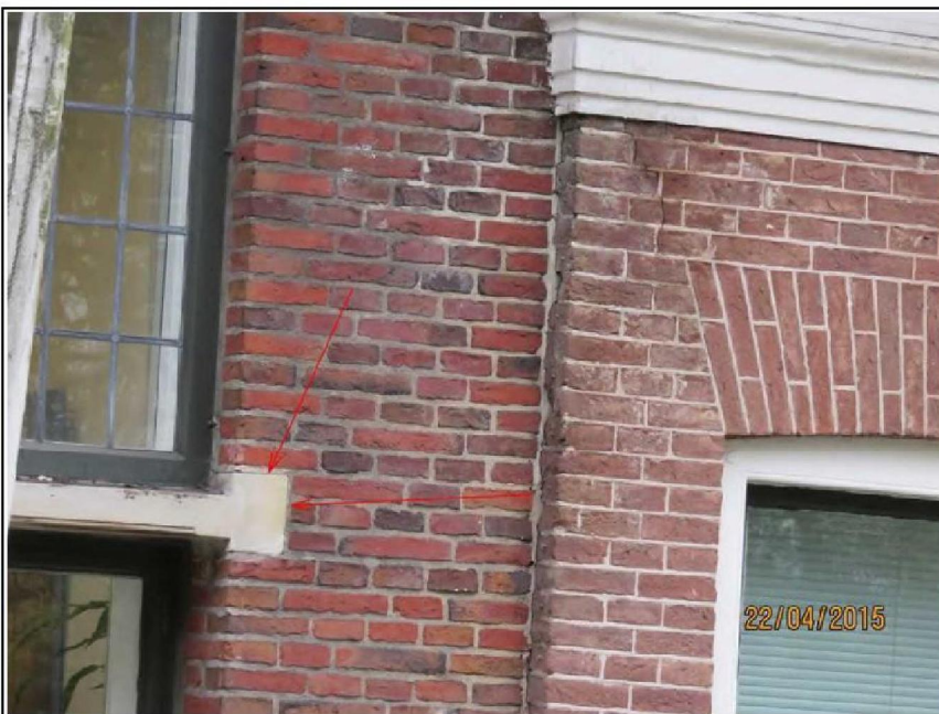
Schade 3, Verticale en horizontale scheuren (57784 22-4 (13))
