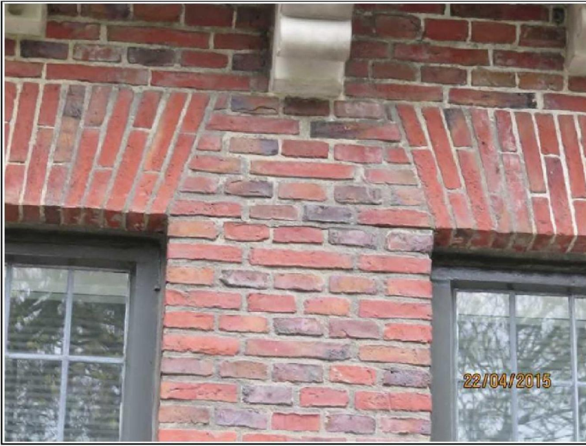
Schade 1, Horizontale scheur in de voeg. (57784 22-4 (31))
