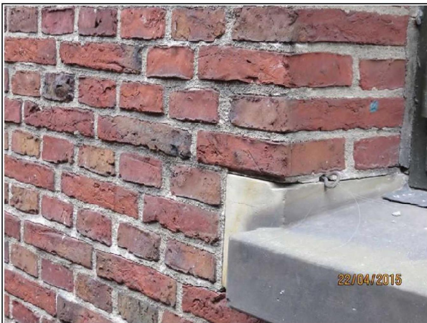
Schade 3, Verticale en horizontale scheuren (57784 22-4 (74))
