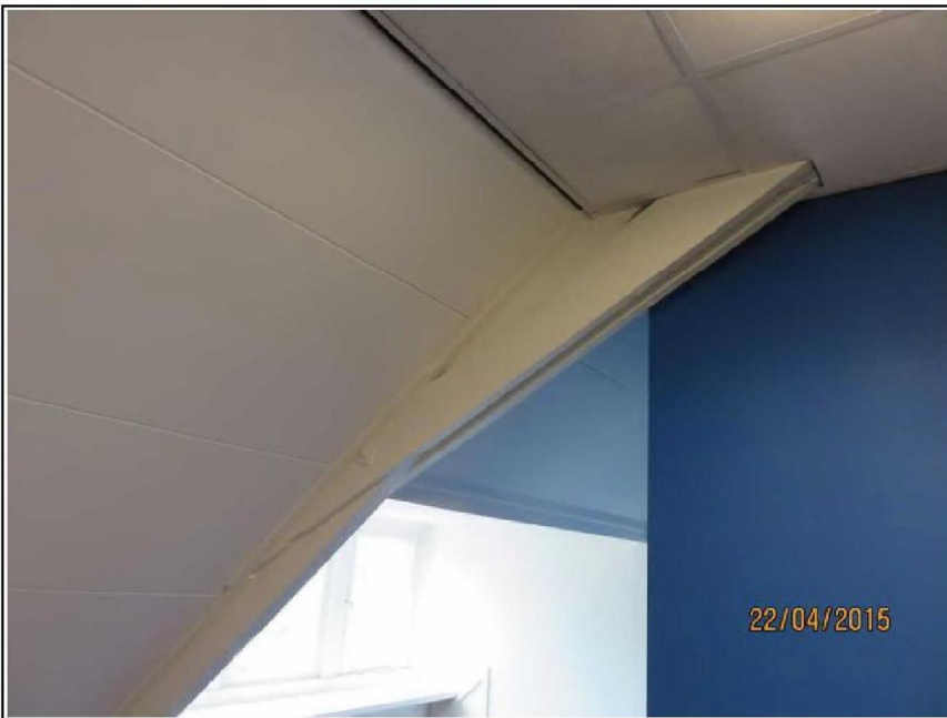
Schade 1, Horizontale scheur in de voeg. (57784 22-4 (204))
