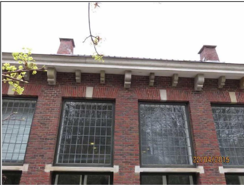
Schade 1, Horizontale scheur in de voeg. (57784 22-4 (30))
