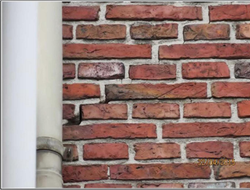
Schade 6, Getrapte scheur. (57784 22-4 (99))
