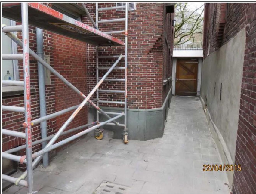
Schade 4, Verticale scheur in natuursteen plint (57784 22-4 (81))
