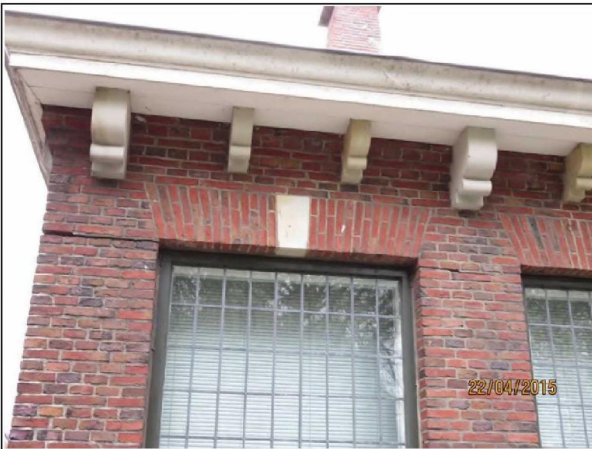
Schade 1, Horizontale scheur in de voeg. (57784 22-4 (37))
