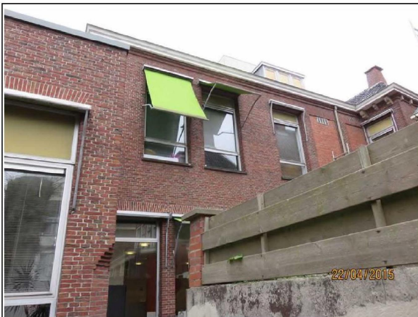
Schade 5, Horizontale scheur in de voeg. (57784 22-4 (89))
