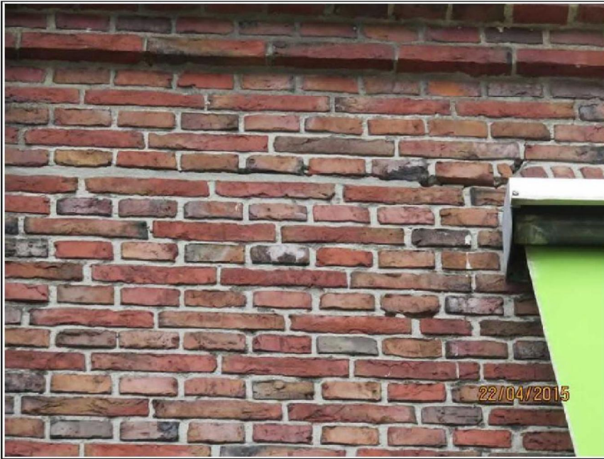
Schade 5, Horizontale scheur in de voeg. (57784 22-4 (92))
