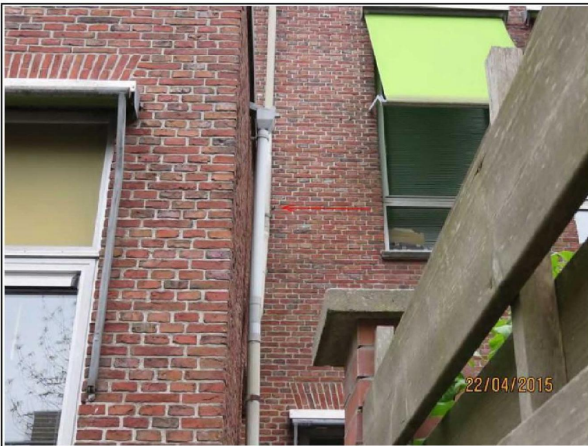
Schade 6, Getrapte scheur. (57784 22-4 (98))
