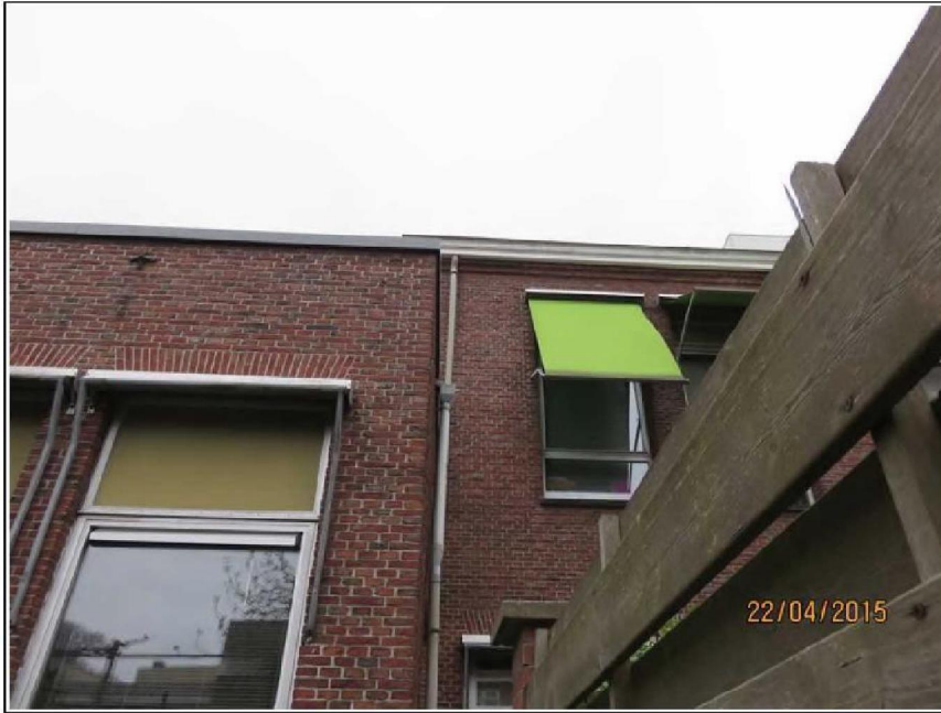
Schade 5, Horizontale scheur in de voeg. (57784 22-4 (90))
