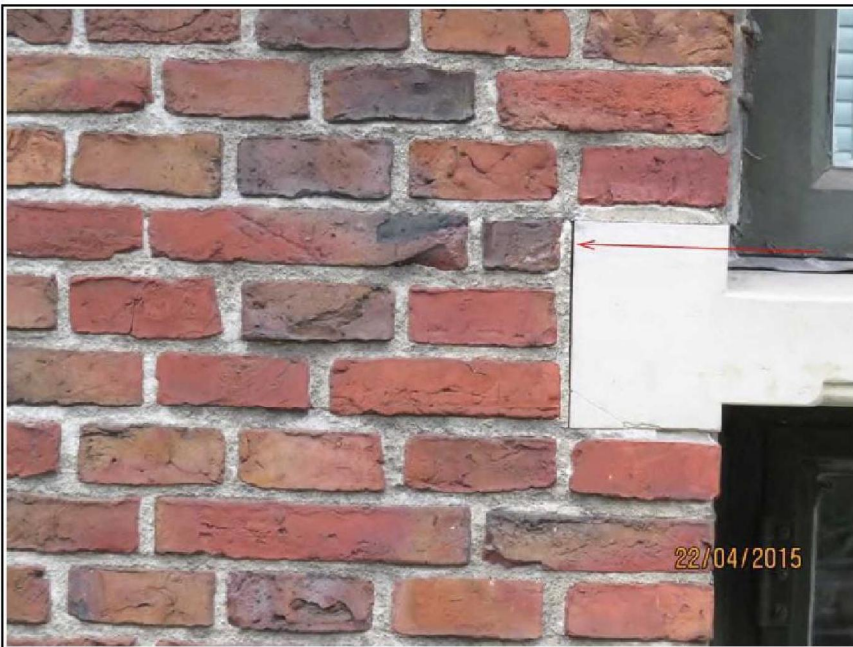
Schade 3, Verticale en horizontale scheuren (57784 22-4 (41))
