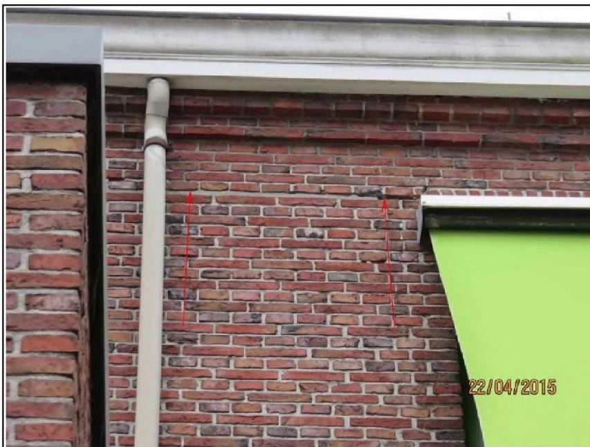
Schade 5, Horizontale scheur in de voeg. (57784 22-4 (91))
