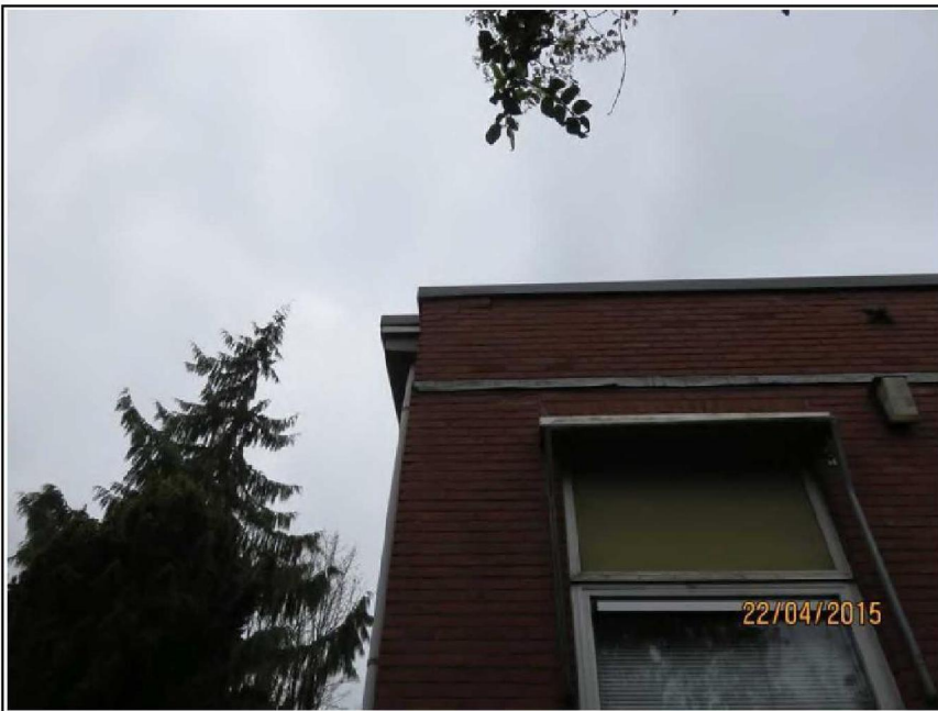
Schade 12, Horizontale scheuren en losse stenen (57784 22-4 (144))
