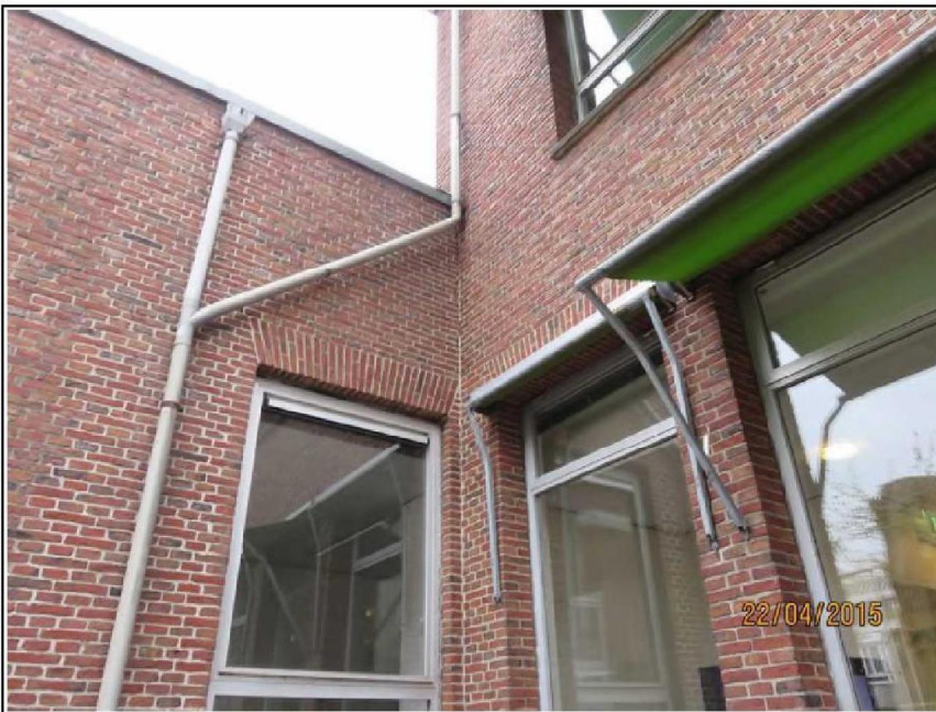
Schade 10, Verticale scheur in hoek aansluiting (57784 22-4 (119))
