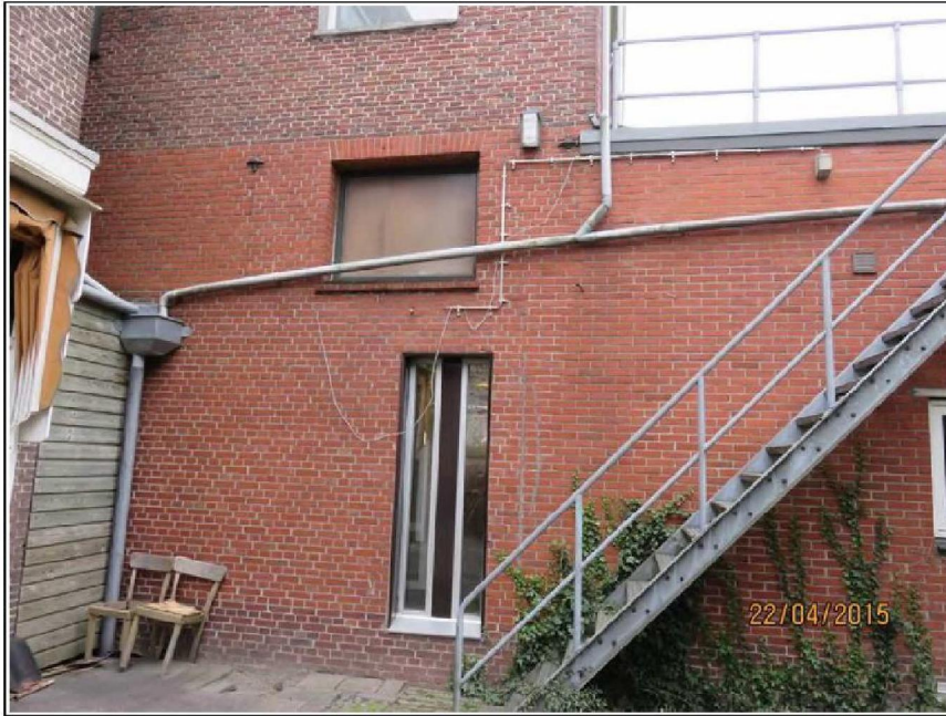
Schade 15, Verticale scheur door stenen en voegen (57784 22-4 (158))
