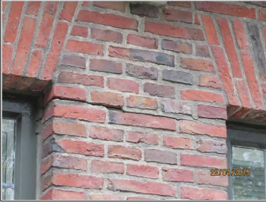
Schade 1, Horizontale scheur in de voeg. (57784 22-4 (39))
