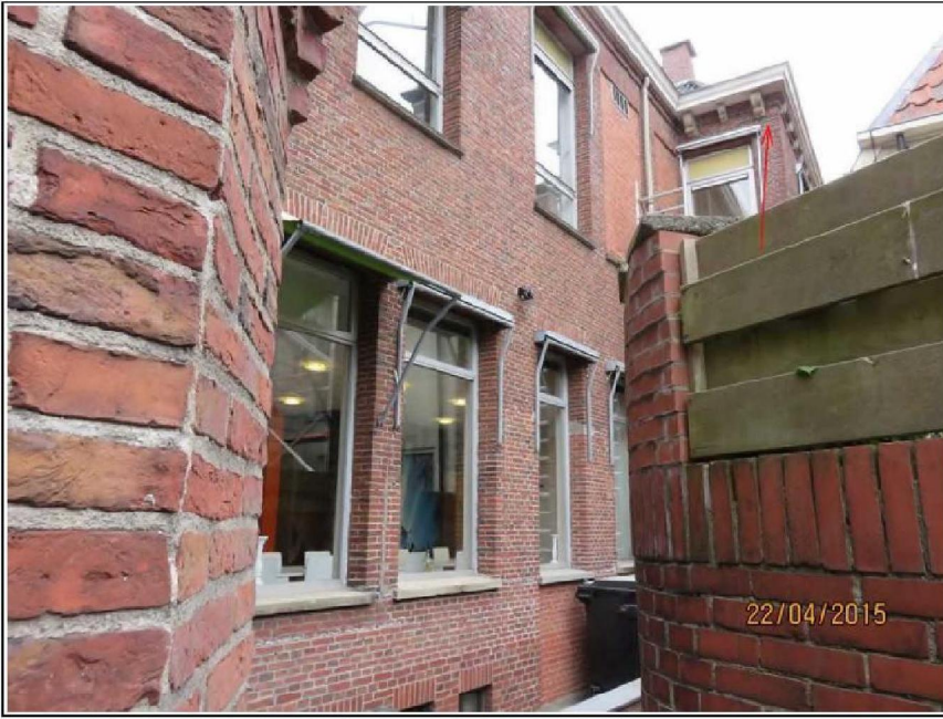
Schade 1, Horizontale scheur in de voeg. (57784 22-4 (88))
