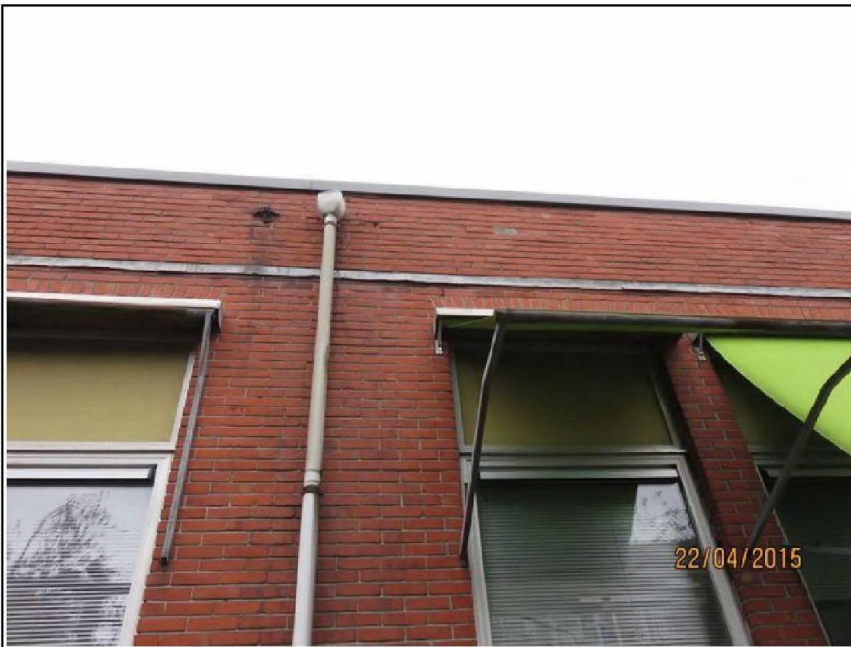
Schade 12, Horizontale scheuren en losse stenen (57784 22-4 (138))
