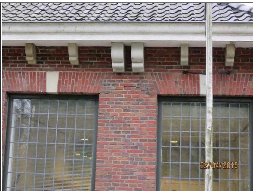
Schade 1, Horizontale scheur in de voeg. (57784 22-4 (10))
