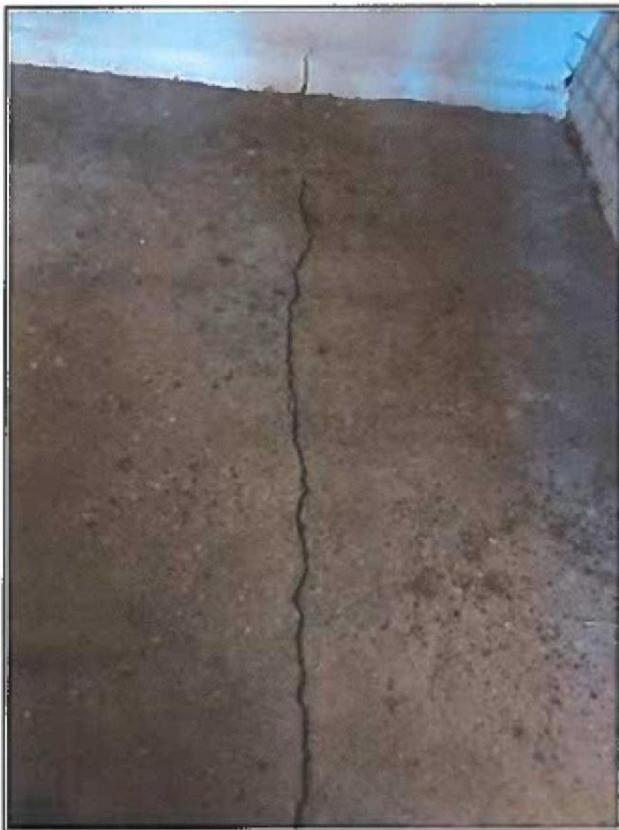
Schade 3, Scheurvorming in betonvloer. (IMG_8255)
