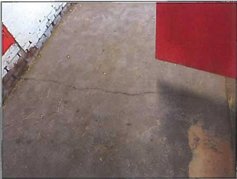
Schade 4, Bestaande scheurvorming in vloer. (IMG_8258)
