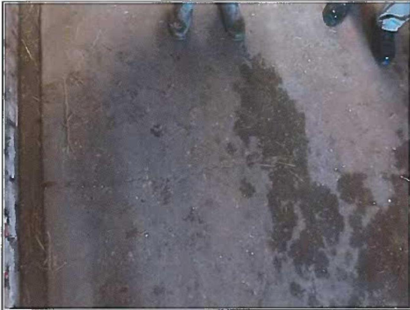
Schade 4, Bestaande scheurvorming in vloer. (IMG_8257)
