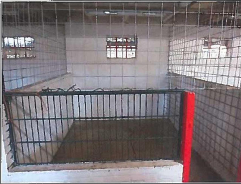
Schade 3, Scheurvorming in betonvloer. (IMG_8256)
