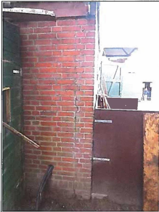
Schade 1, Bestaande scheurvorming in gevel metselwerk (IMG_8251)
