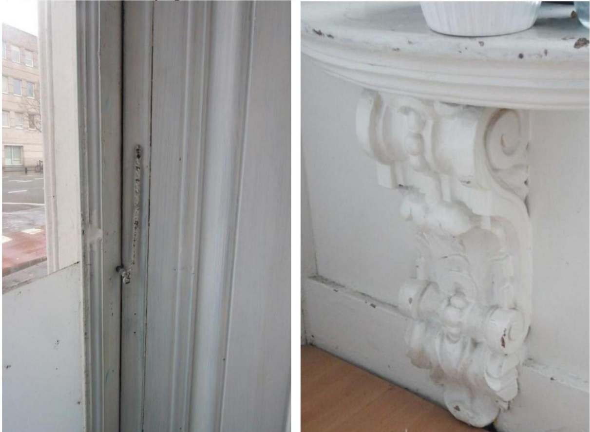
Afb. 33: Sluitwerk schuiframen met borgpennen aan kettingen. Net boven de sluitpen is de onderbreking van het raamprofiel zichtbaar van de ontbrekende roede (links). Onder de vensterbank een weelderig gesneden console (rechts).
