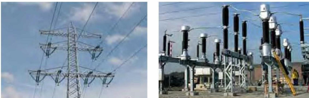
Figuur 3.26 Hoogspanningsmast en verdeelstation (voorbeelden)
