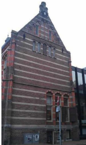
Figuur 13: Niet of weinig gesteunde metselwerk topgevels
