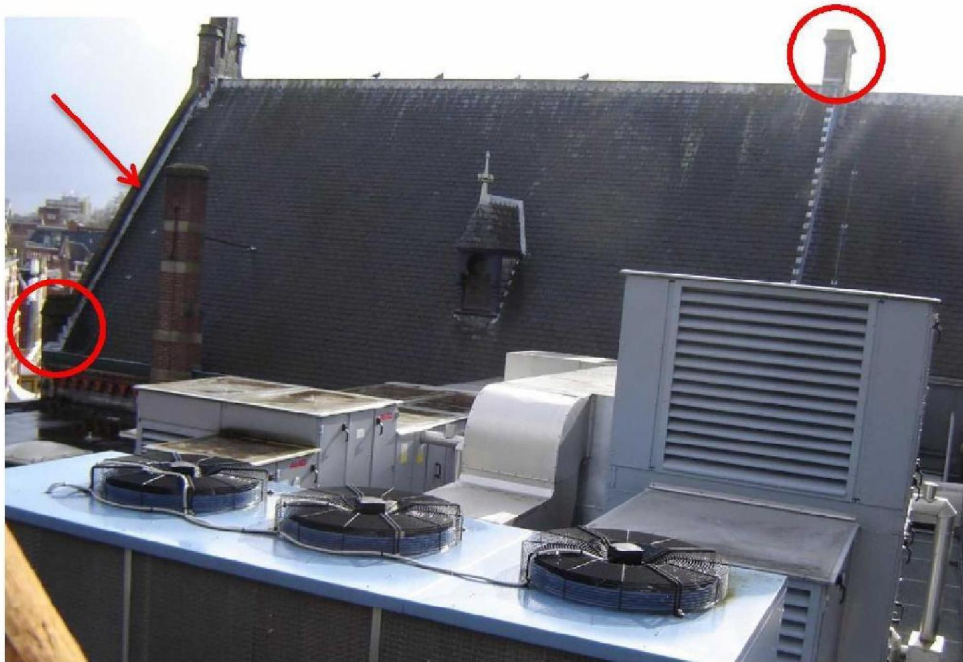
Figuur 16: Niet gesteunde metselwerk geveldelen en muurafdekker
