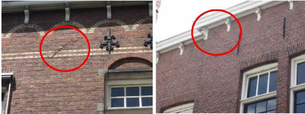
Figuur 10: Scheuren en weggedrukte bakstenen
