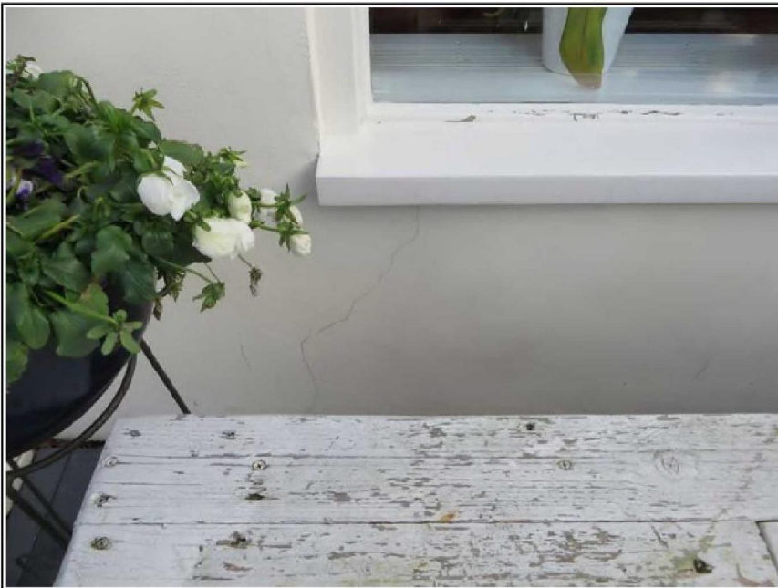
Schade 5, Lichte scheuren in het gevelstucwerk. (26707_0067)
