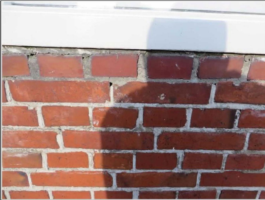
Schade 3, Lichte scheuren in het metselwerk. (26707_0054)
