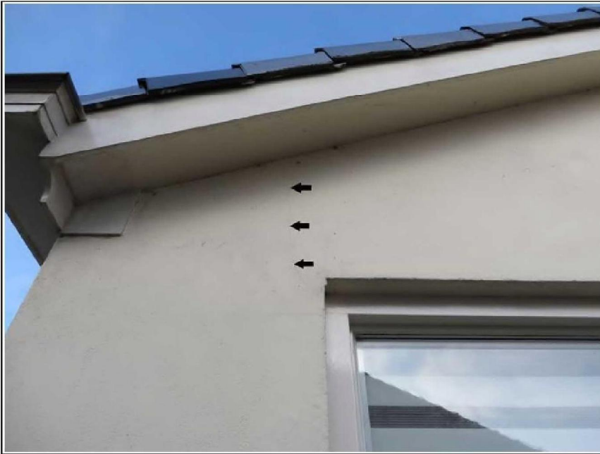
Schade 4, Lichte scheuren in het gevelstucwerk. (26707_0062)
