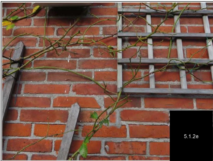
Schade 6, Lichte scheuren in het metselwerk. (26707_0069)
