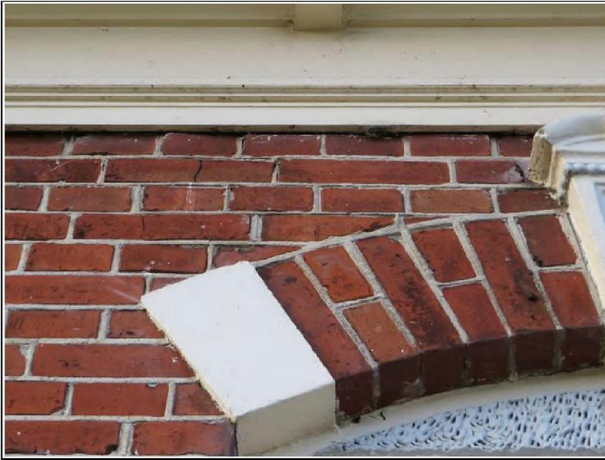
Schade 1, Lichte scheuren in het metselwerk. (26707_0014)
