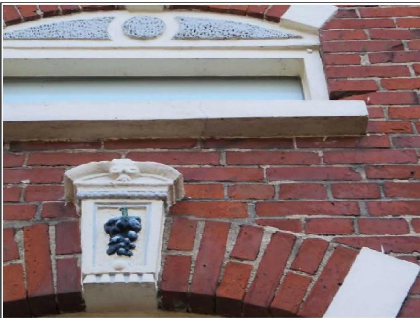
Schade 2, Lichte scheuren in het metselwerk. (26707_0047)
