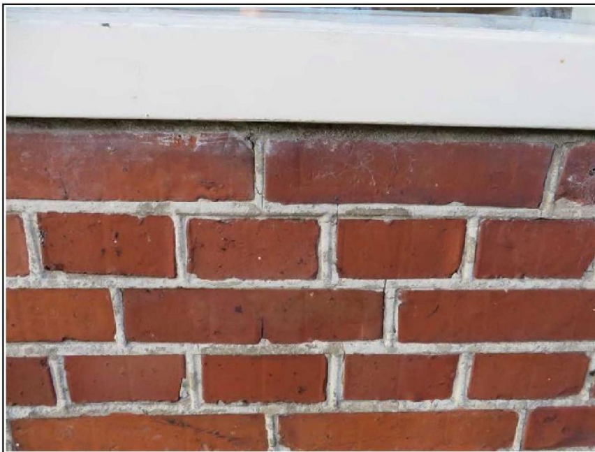
Schade 1, Lichte scheuren in het metselwerk. (26707_0011)
