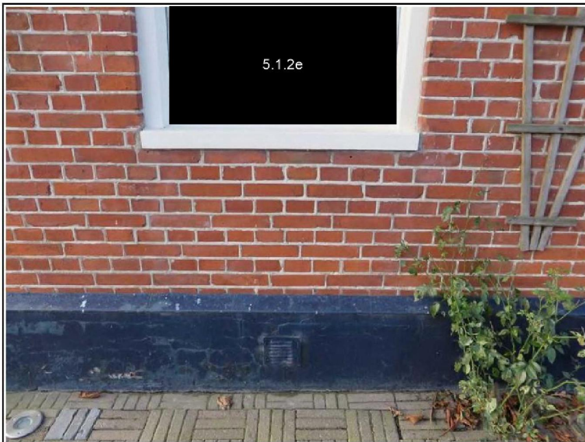
Schade 1, Lichte scheuren in het metselwerk. (26707_0004)
