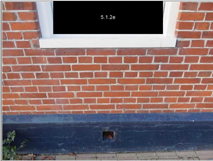
Schade 1, Lichte scheuren in het metselwerk. (26707_0010)
