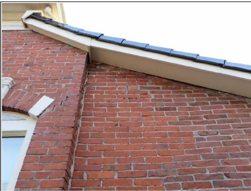
Schade 2, Lichte scheuren in het metselwerk. (26707_0051)
