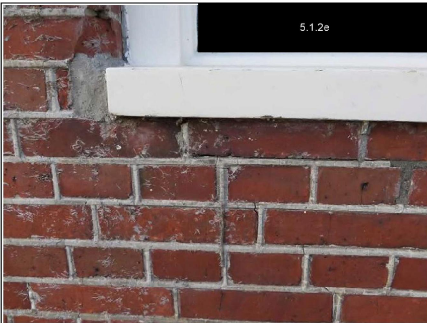
Schade 1, Lichte scheuren in het metselwerk. (26707_0029)
