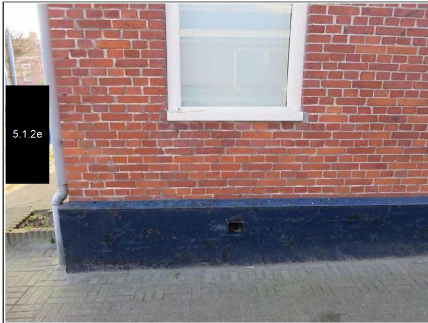
Schade 2, Lichte scheuren in het metselwerk. (26707_0036)
