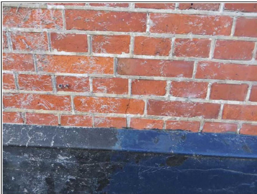
Schade 1, Lichte scheuren in het metselwerk. (26707_0027)
