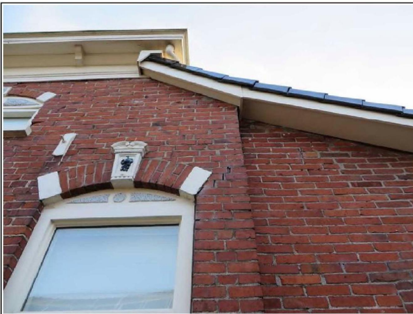
Schade 2, Lichte scheuren in het metselwerk. (26707_0049)
