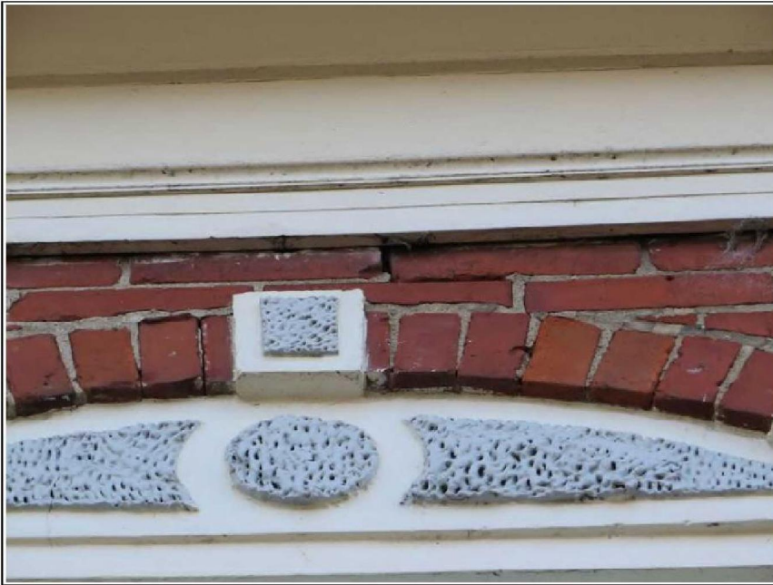
Schade 2, Lichte scheuren in het metselwerk. (26707_0048)
