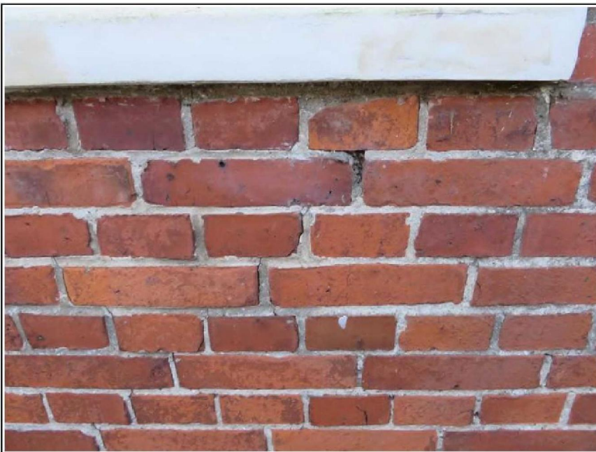
Schade 2, Lichte scheuren in het metselwerk. (26707_0045)
