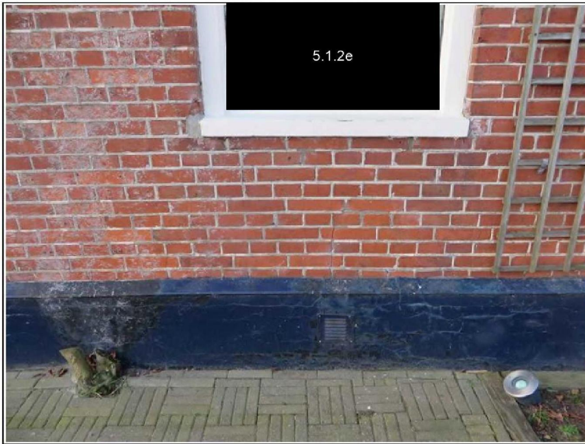
Schade 1, Lichte scheuren in het metselwerk. (26707_0026)
