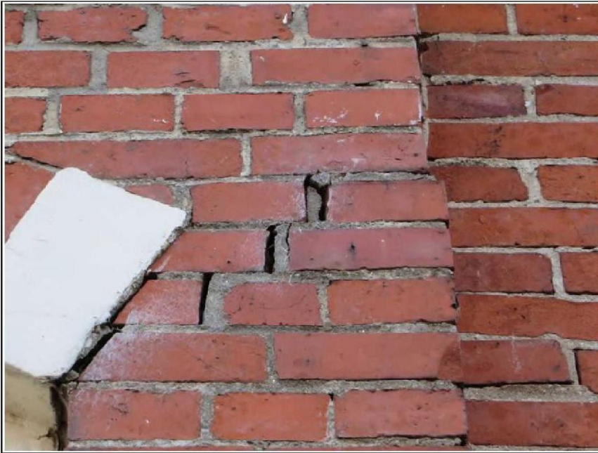
Schade 2, Lichte scheuren in het metselwerk. (26707_0050)
