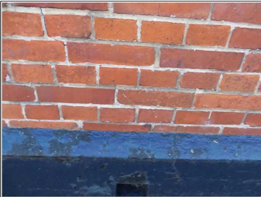
Schade 2, Lichte scheuren in het metselwerk. (26707_0039)
