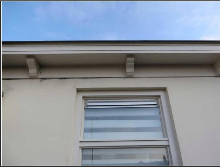
Schade 5, Lichte scheuren in het gevelstucwerk. (26707_0066)
