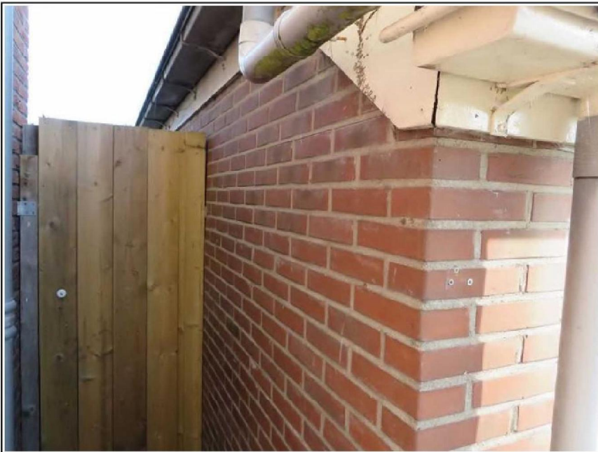
Schade 8, Lichte scheuren in het metselwerk. (26707_0073)
