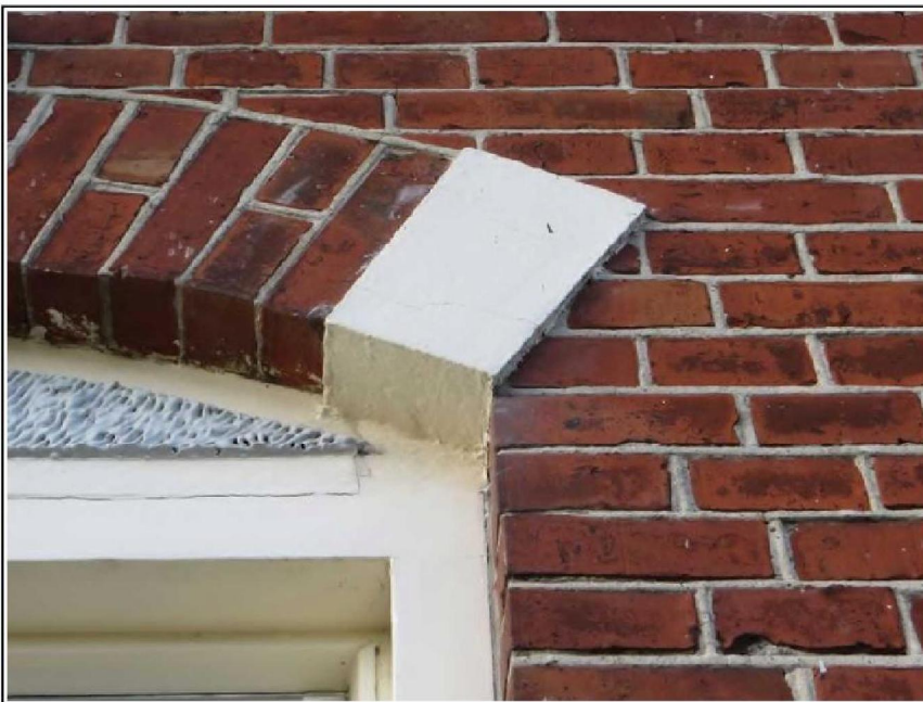
Schade 1, Lichte scheuren in het metselwerk. (26707_0015)
