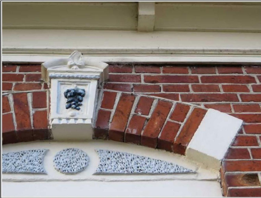
Schade 1, Lichte scheuren in het metselwerk. (26707_0032)
