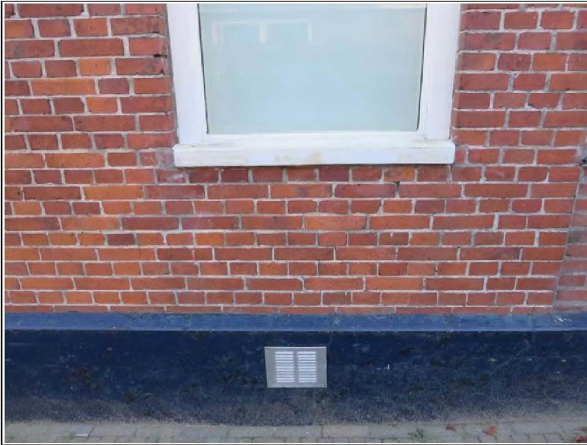
Schade 2, Lichte scheuren in het metselwerk. (26707_0042)
