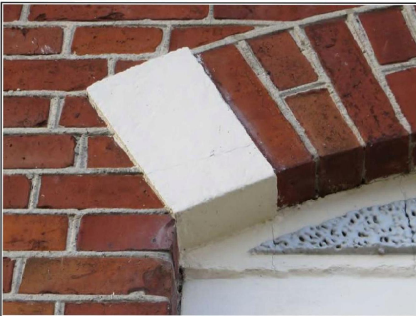
Schade 1, Lichte scheuren in het metselwerk. (26707_0025)
