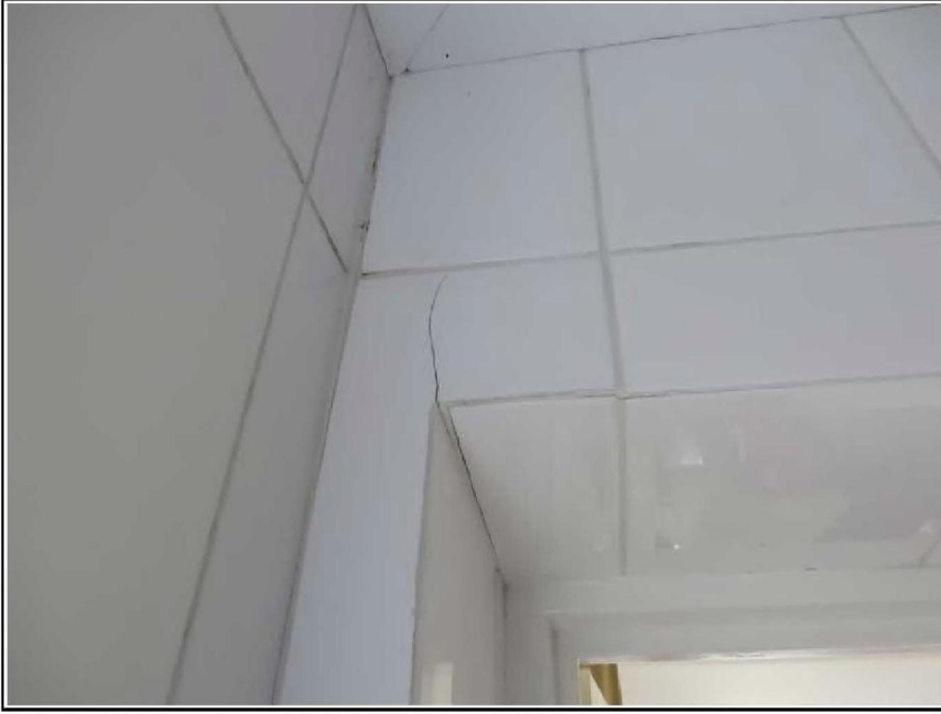
Schade 10, Lichte scheuren in het tegelwerk. (26707_0078)
