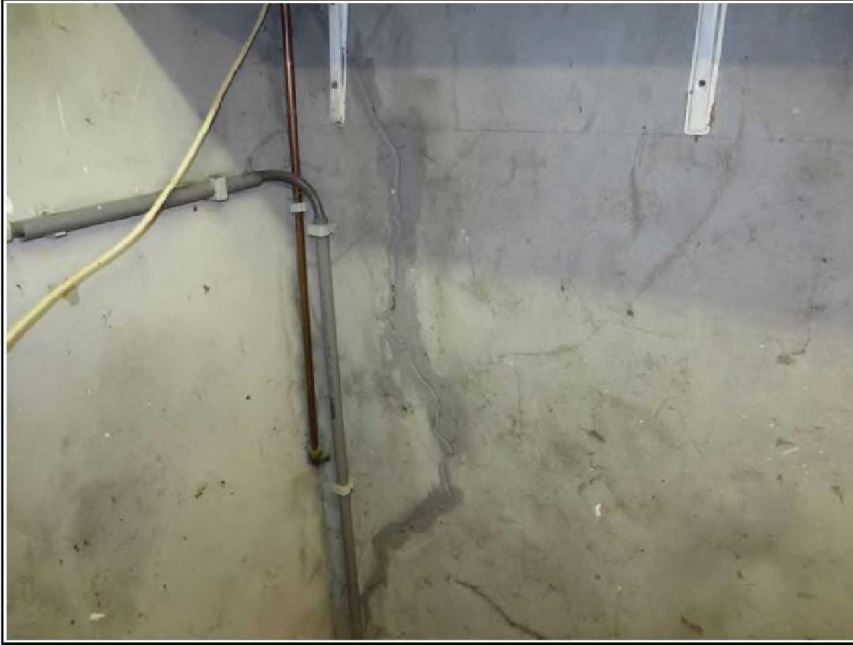
Schade 9, Lichte scheuren in de raaplaag. (26707_0076)
