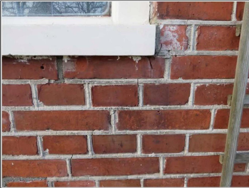
Schade 1, Lichte scheuren in het metselwerk. (26707_0030)
