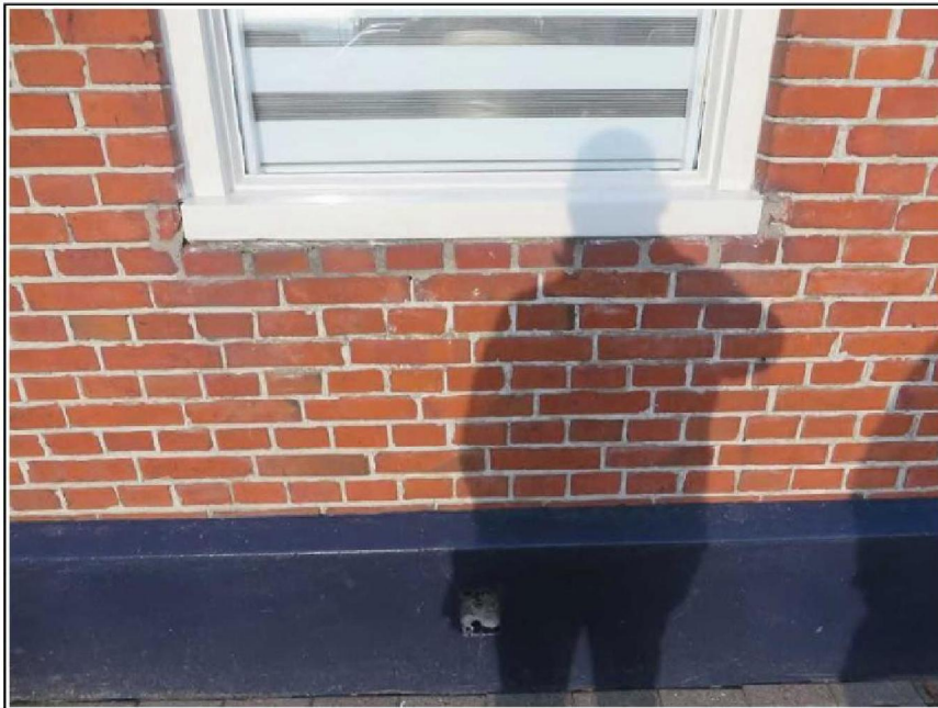
Schade 3, Lichte scheuren in het metselwerk. (26707_0053)
