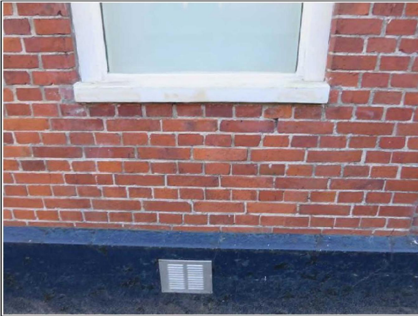
Schade 2, Lichte scheuren in het metselwerk. (26707_0044)
