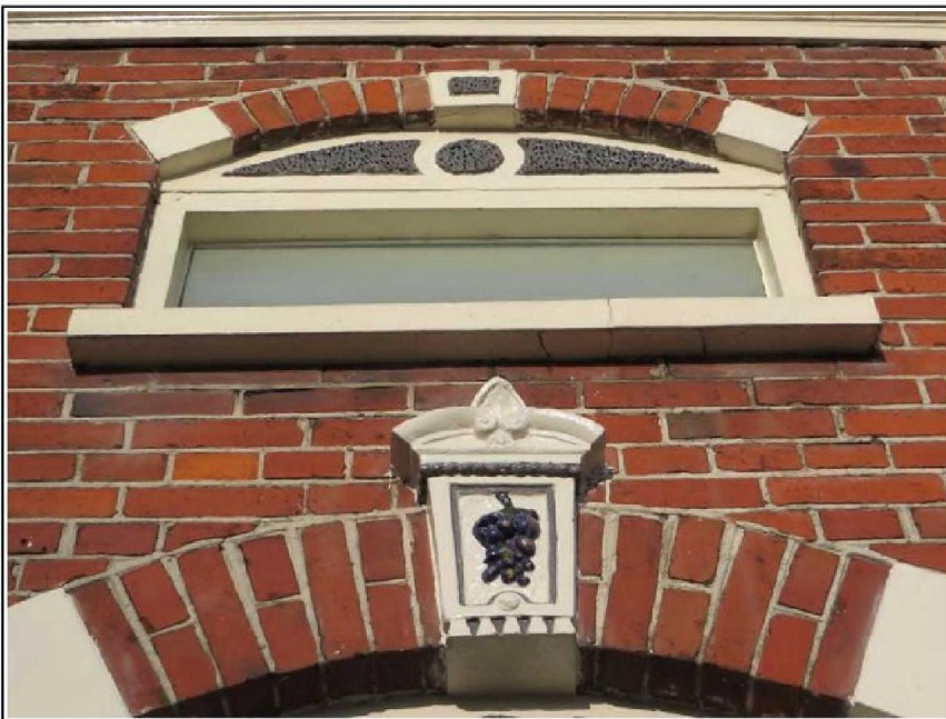
Schade 3, Lichte scheuren in het metselwerk. (26707_0059)
