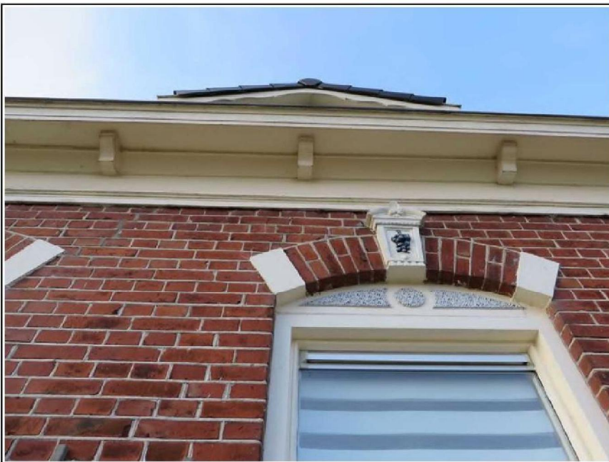
Schade 1, Lichte scheuren in het metselwerk. (26707_0013)
