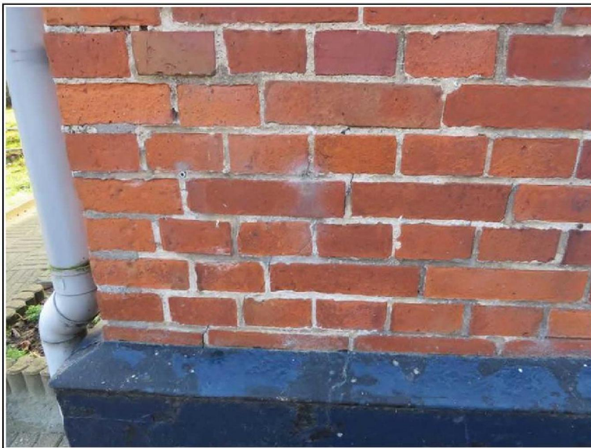
Schade 2, Lichte scheuren in het metselwerk. (26707_0037)
