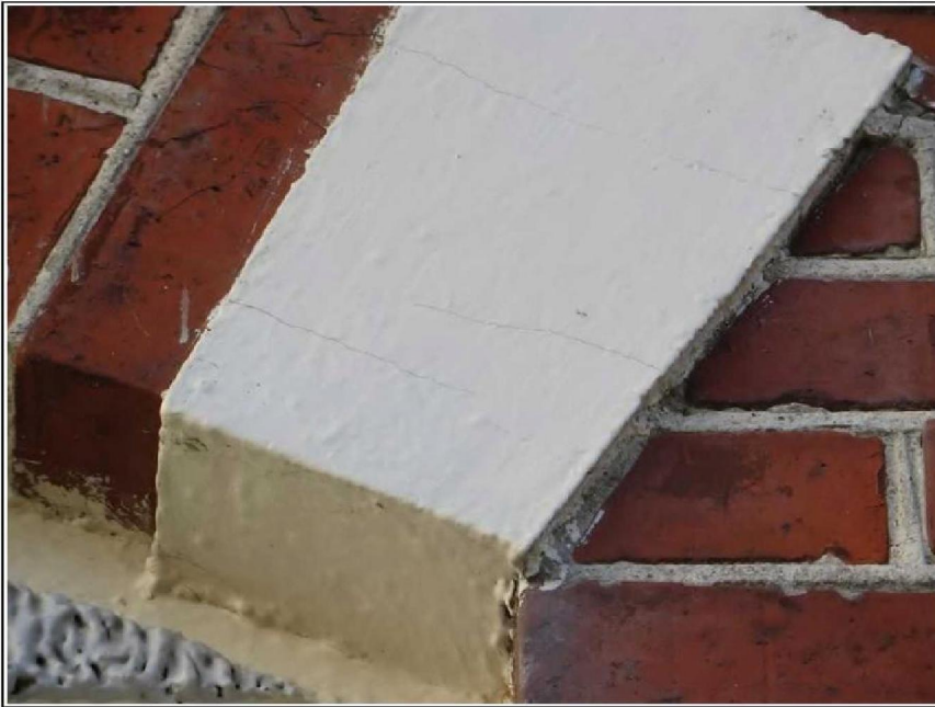
Schade 1, Lichte scheuren in het metselwerk. (26707_0016)
