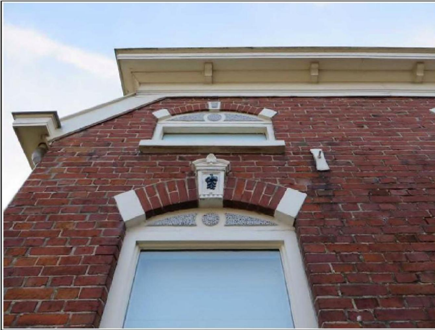
Schade 2, Lichte scheuren in het metselwerk. (26707_0040)
