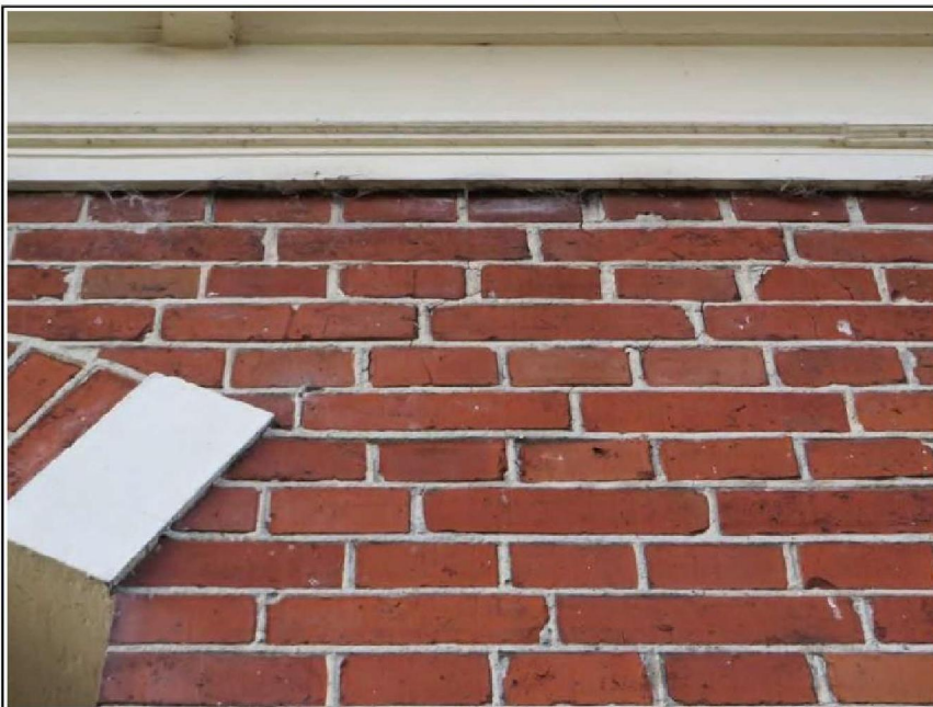
Schade 1, Lichte scheuren in het metselwerk. (26707_0019)
