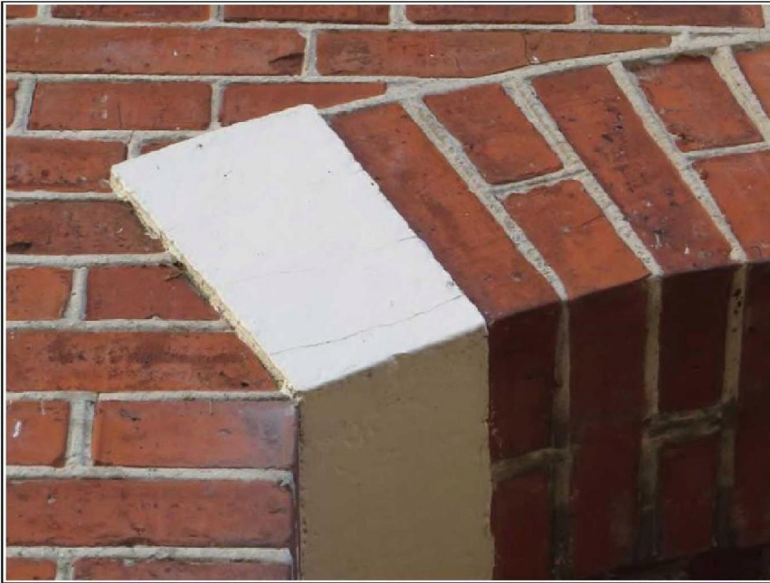
Schade 1, Lichte scheuren in het metselwerk. (26707_0018)
