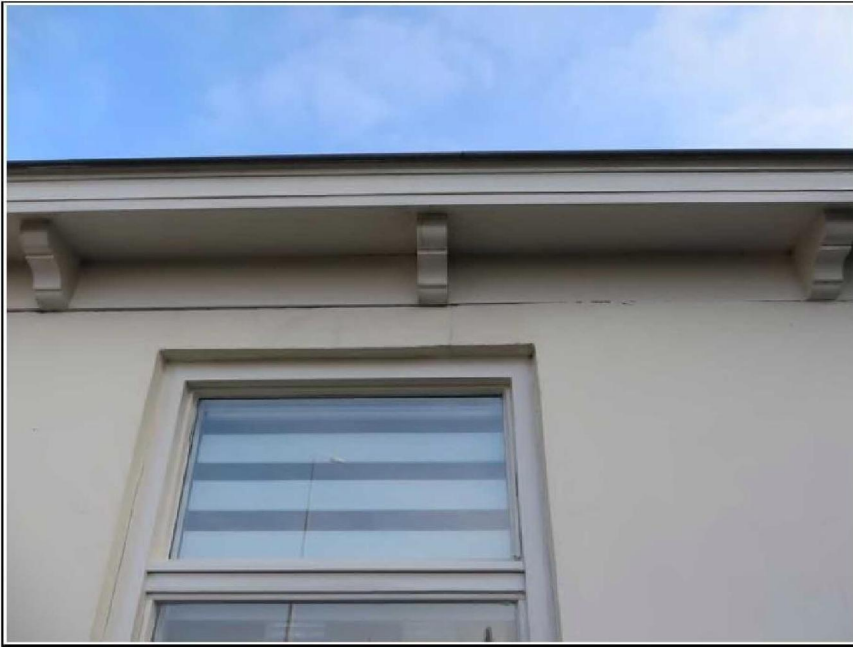
Schade 5, Lichte scheuren in het gevelstucwerk. (26707_0064)
