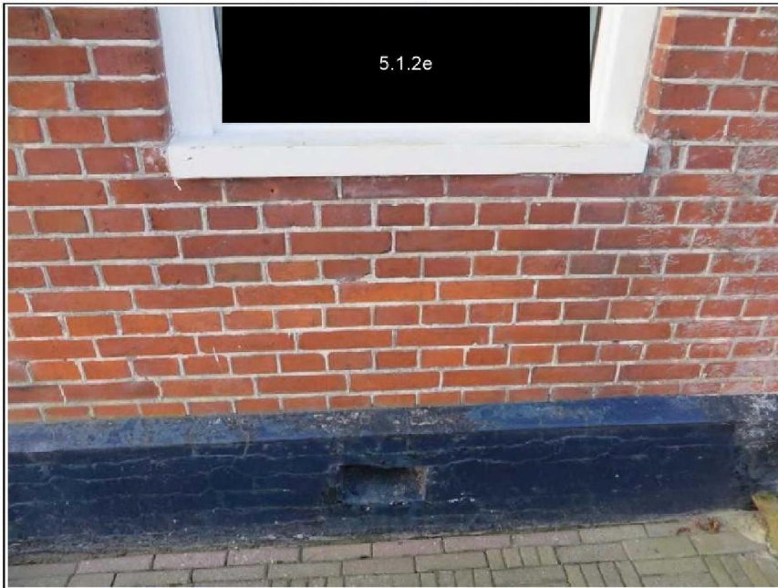
Schade 1, Lichte scheuren in het metselwerk. (26707_0020)
