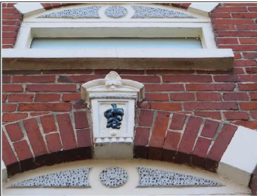
Schade 2, Lichte scheuren in het metselwerk. (26707_0041)
