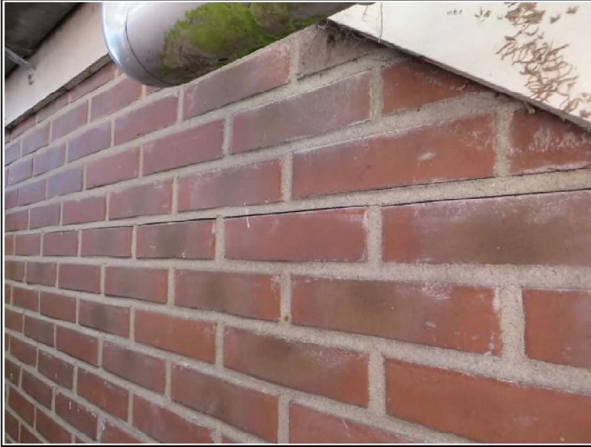
Schade 8, Lichte scheuren in het metselwerk. (26707_0074)
