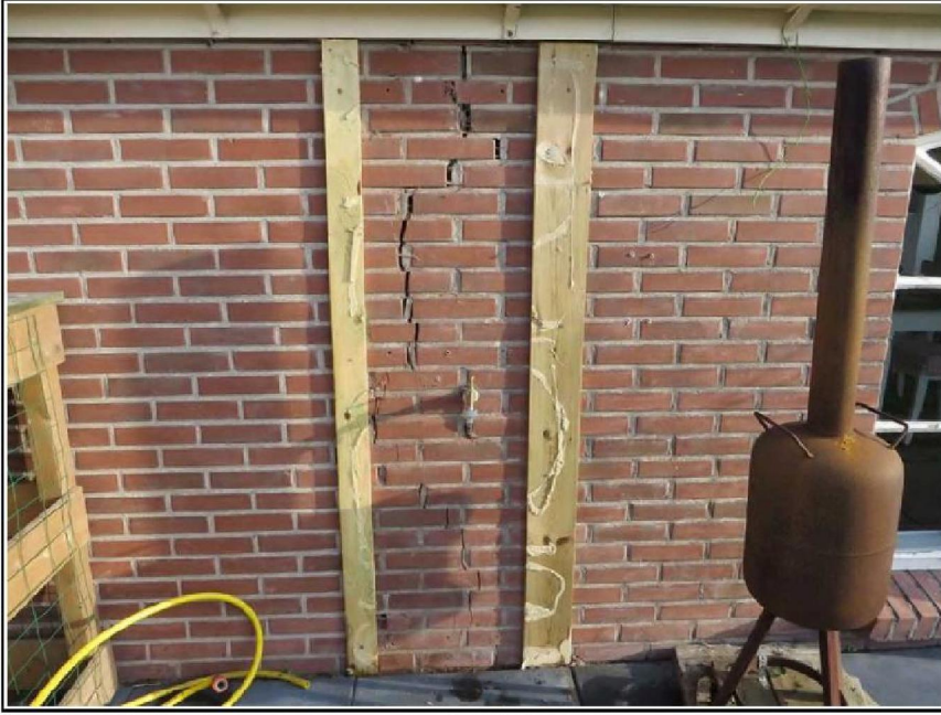
Schade 7, Lichte scheuren in het metselwerk. (26707_0072)
