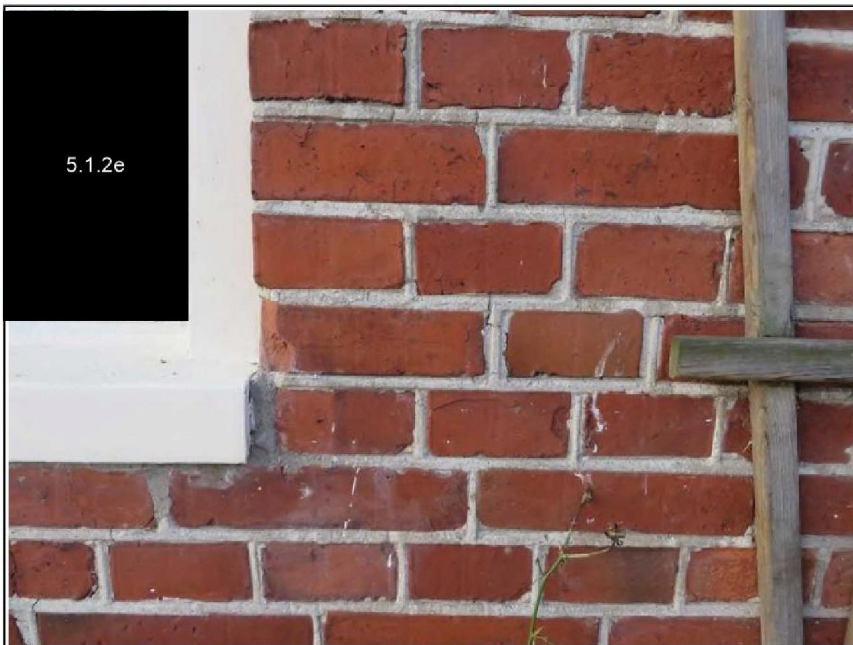
Schade 1, Lichte scheuren in het metselwerk. (26707_0009)
