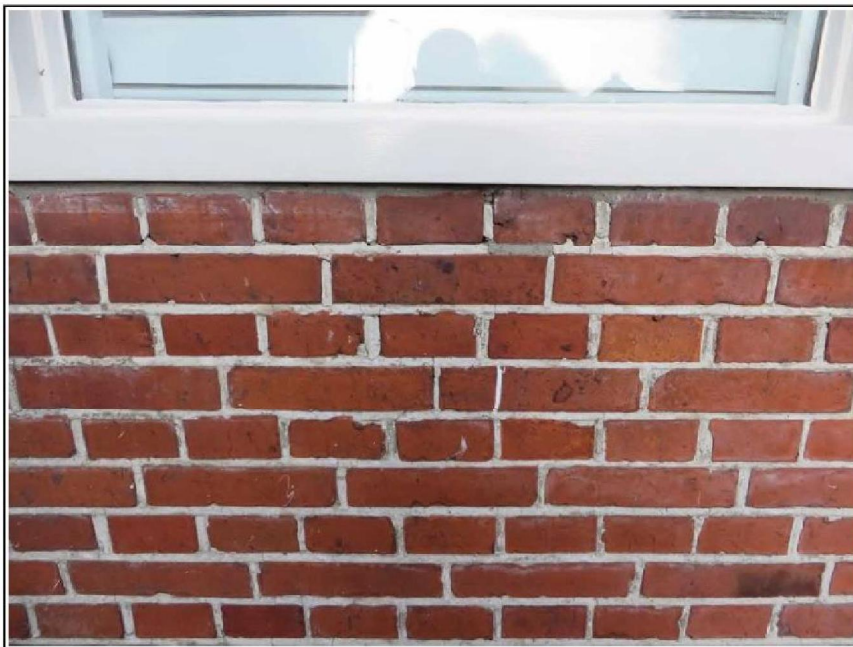
Schade 3, Lichte scheuren in het metselwerk. (26707_0057)
