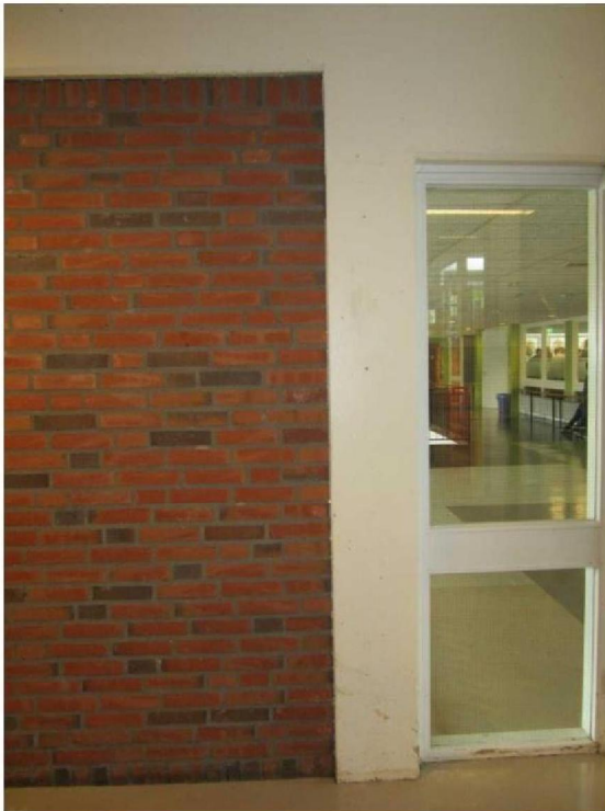
Foto C5: Steens metselwerkwand 'opgesloten' tegen betonnen kolom.
