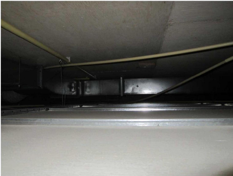
Foto B14: Ventilatiekanaal boven systeemplafond.
