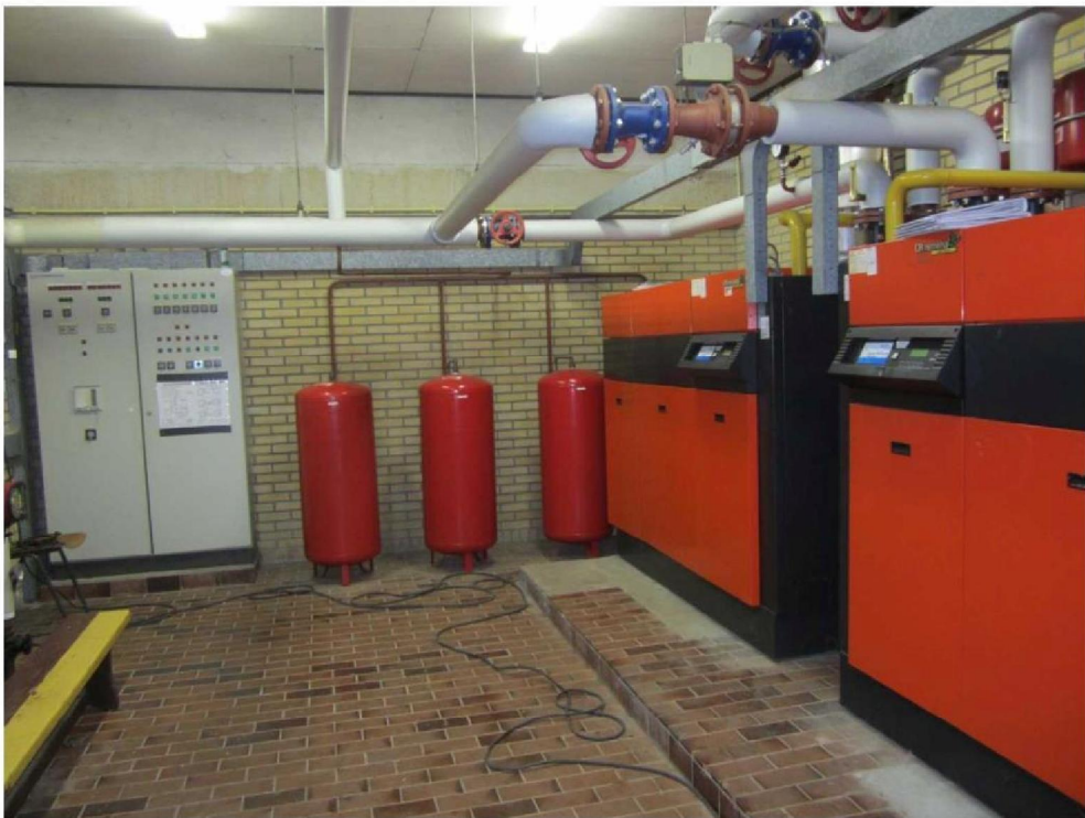
Foto B12: Onlangs vernieuwde verwarmingsinstallatie en regelkast.
