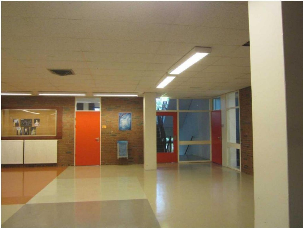
Foto B11: Overzicht systeemplafond met verlichting.
