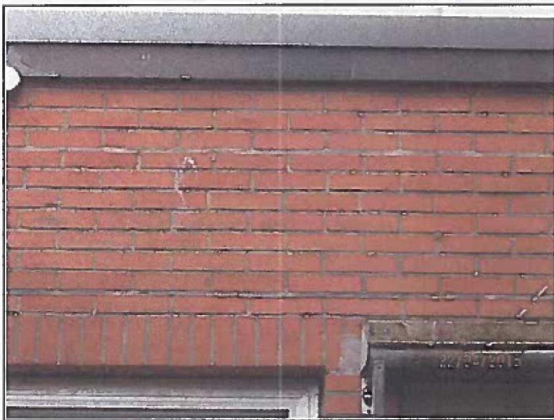
Schade 14, Horizontale scheuren en losse stenen (57784 22-4 (157))
