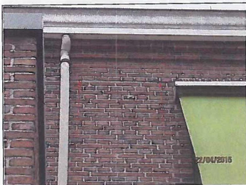
Schade 5, Horizontale scheur in de voeg. (57784 22-4 (91))
