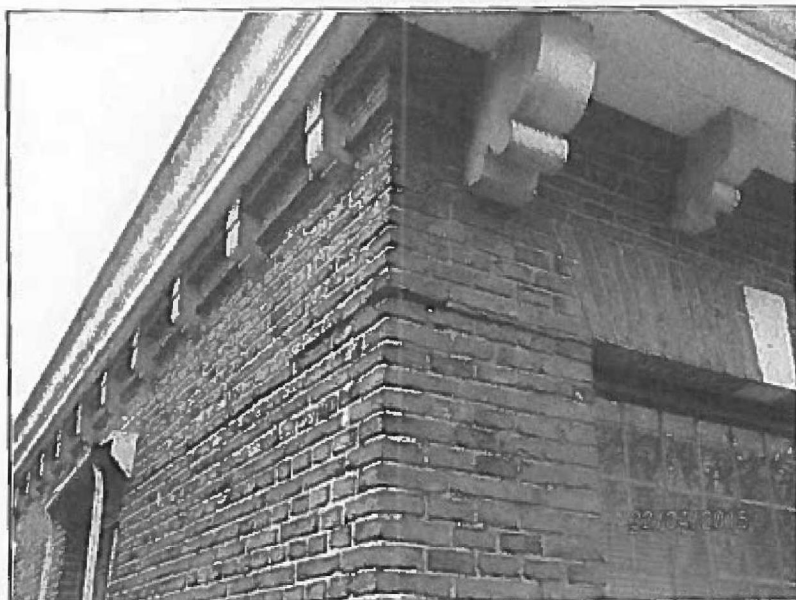
Schade 1, Horizontale scheur in de voeg. (57784 22-4 (48))
