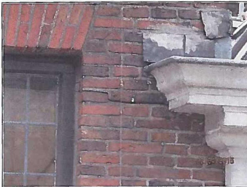
Schade 1, Horizontale scheur in de voeg. (57784 22-4 (7))
