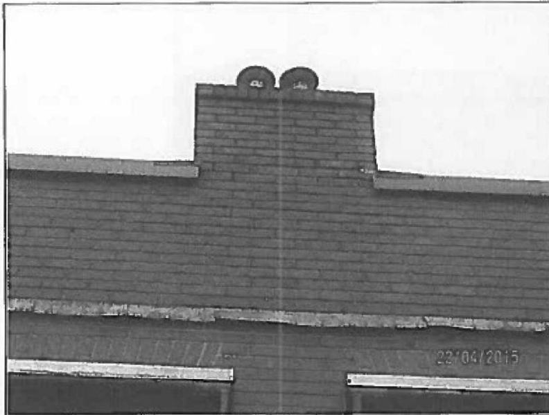
Schade 12, Horizontale scheuren en losse stenen (57784 22-4 (143))
