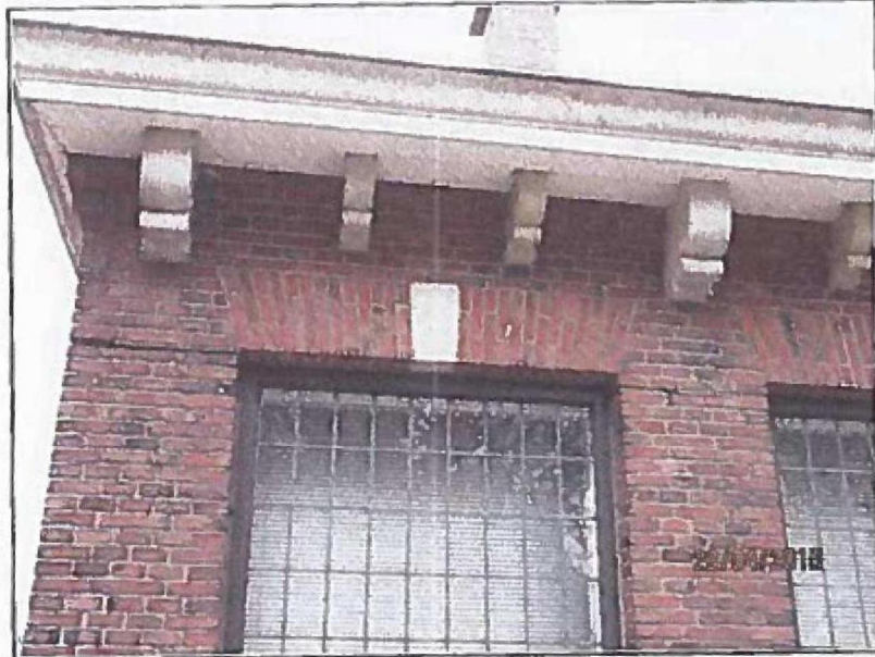
Schade 1, Horizontale scheur in de voeg. (57784 22-4 (37))
