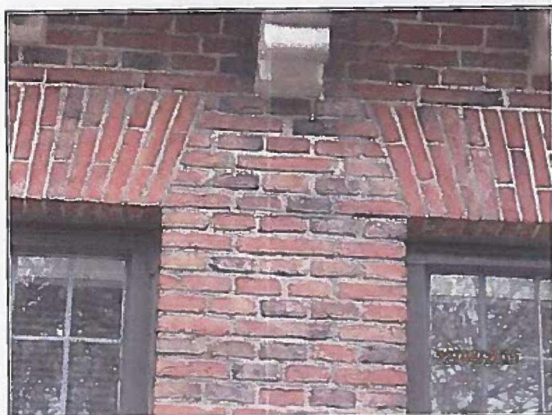
Schade 1, Horizontale scheur in de voeg. (57784 22-4 (31))
