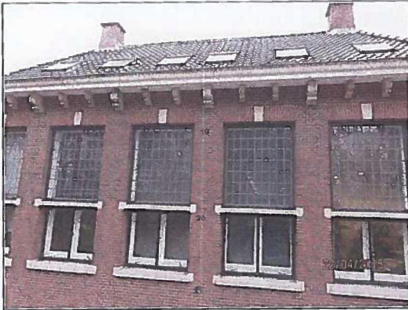
Schade 1, Horizontale scheur in de voeg. (57784 22-4 (17))
