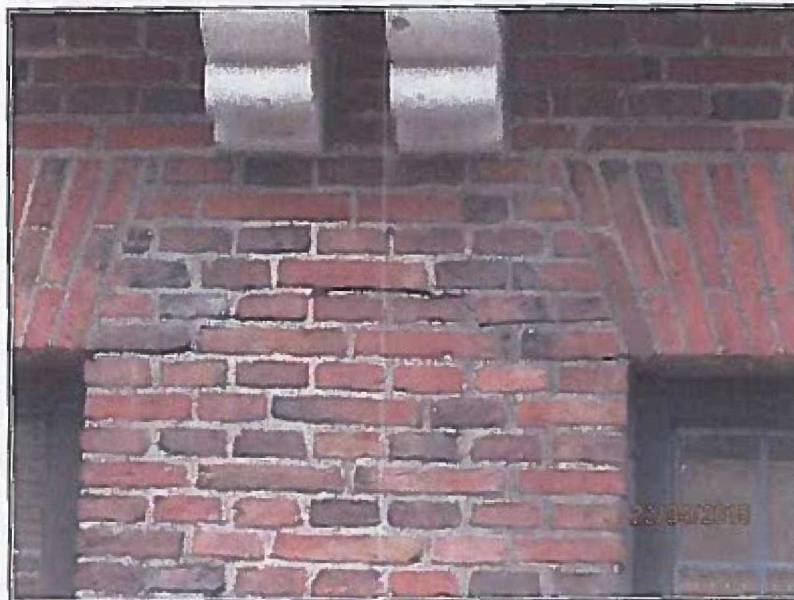
Schade 1, Horizontale scheur in de voeg. (57784 22-4 (11))
