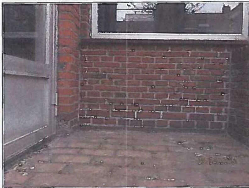
Schade 11, Diverse scheuren in voeg en stenen. (57784 22-4 (129))
