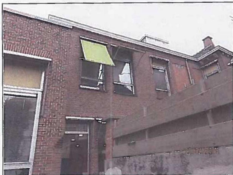
Schade 5, Horizontale scheur in de voeg (57784 22-4 (89))
