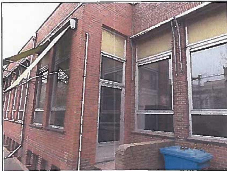
Schade 11, Diverse scheuren in voeg en stenen. (57784 22-4 (127))
