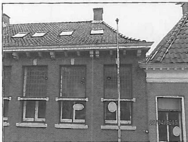
Schade 1, Horizontale scheur in de voeg. (57784 22-4 (5))
