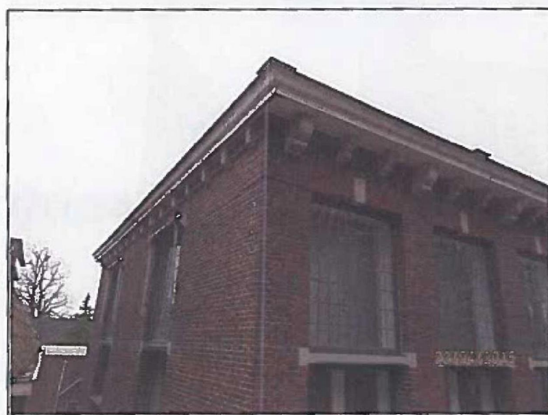
Schade 1, Horizontale scheur in de voeg. (57784 22-4 (45))
