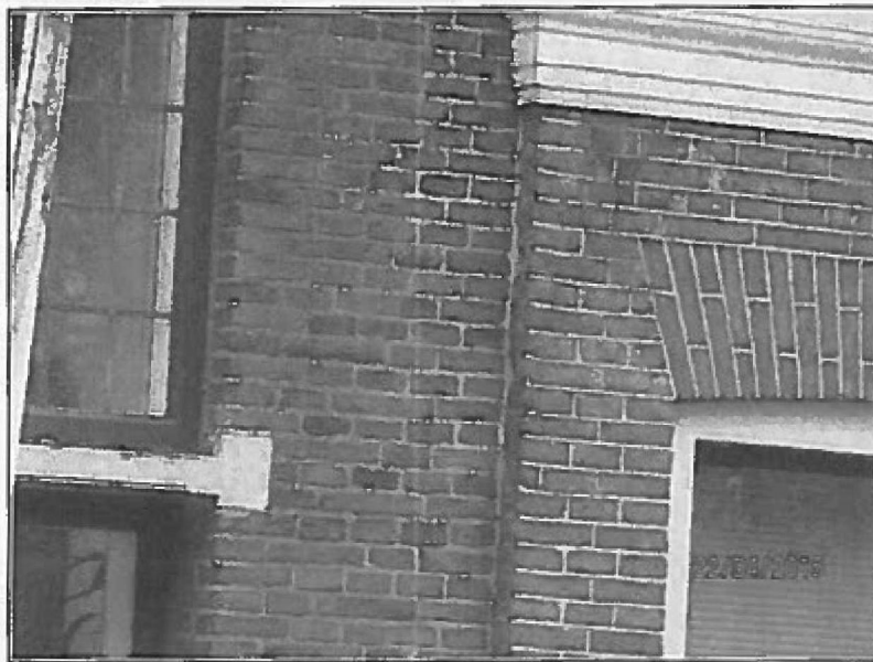
Schade 3, Verticale en horizontale scheuren (57784 22-4 (13))
