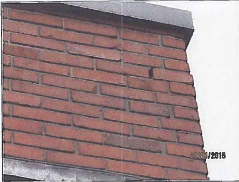
Schade 12, Horizontale scheuren en losse stenen (57784 22-4 (137))
