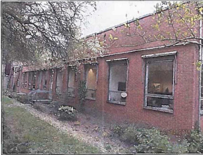
Schade 14, Horizontale scheuren en losse stenen (57784 22-4 (152))
