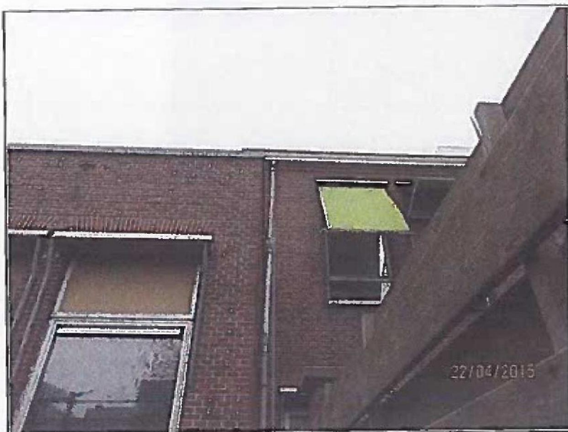
Schade 5, Horizontale scheur in de voeg. (57784 22-4 (90))
