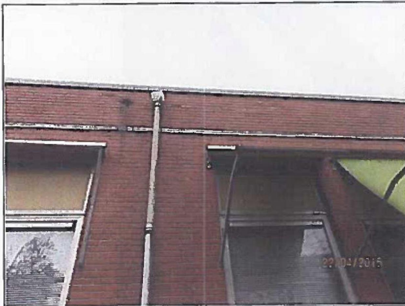
Schade 12, Horizontale scheuren en losse stenen (57784 22-4 (138))
