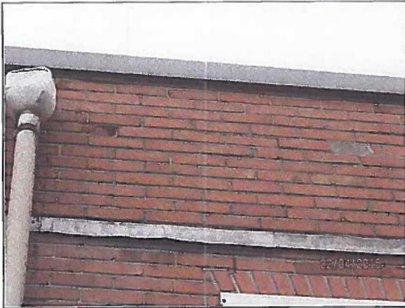
Schade 12, Horizontale scheuren en losse stenen (57784 22-4 (139))
