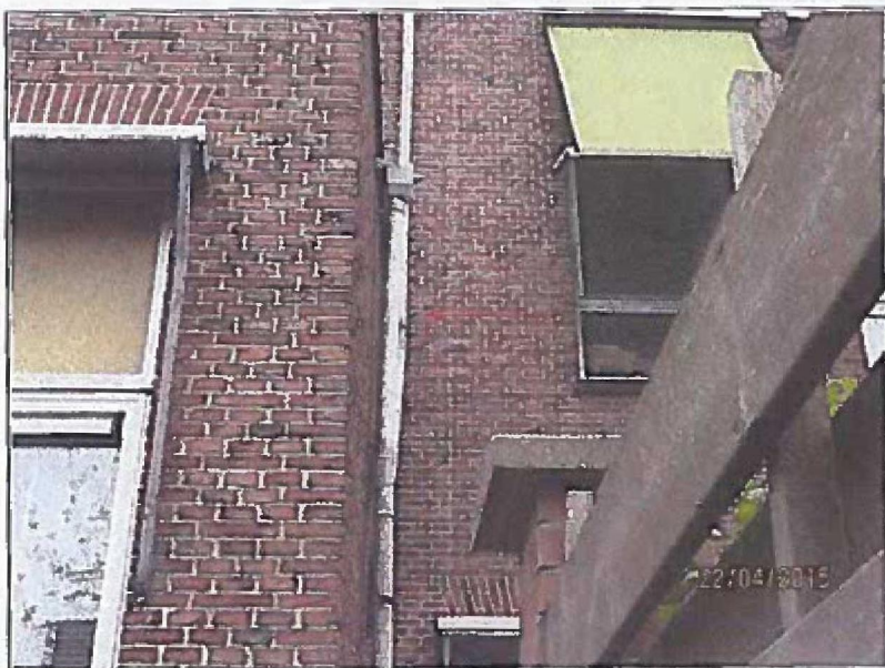
Schade 6, Getrapte scheur. (57784 22-4 (98))
