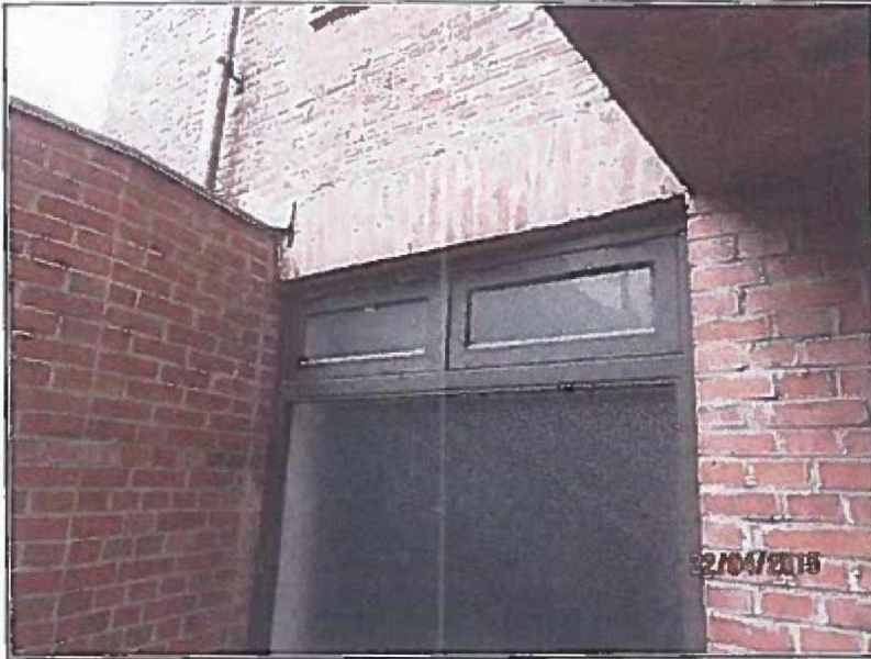
Schade 8, Scheurvorming in metselwerk (57784 22-4 (108))
