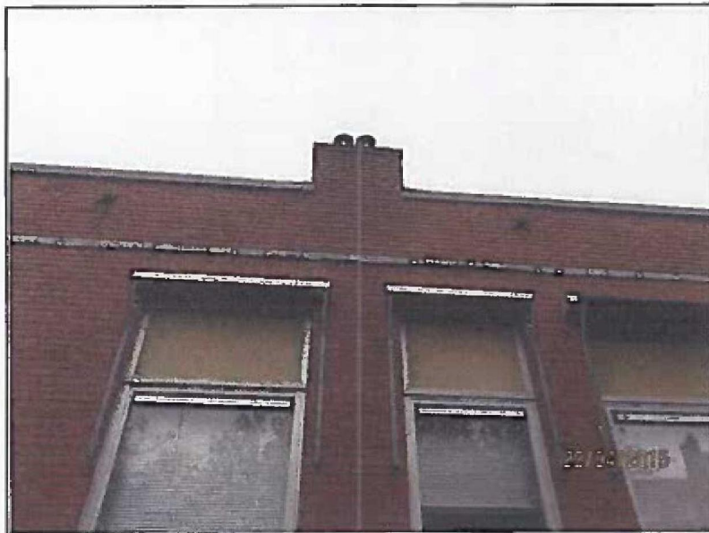
Schade 12, Horizontale scheuren en losse stenen (57784 22-4 (142))
