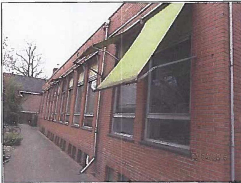
Schade 12, Horizontale scheuren en losse stenen (57784 22-4 (135))
