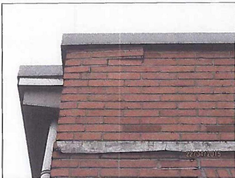
Schade 12, Horizontale scheuren en losse stenen (57784 22-4 (145))
