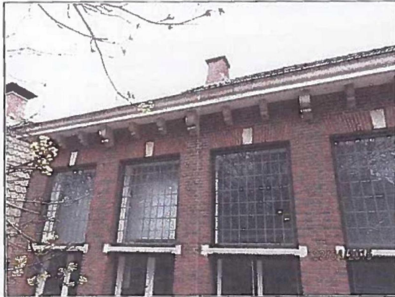
Schade 1, Horizontale scheur in de voeg. (57784 22-4 (34))
