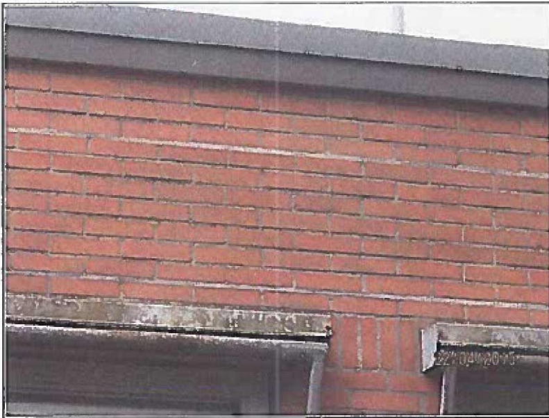
Schade 14, Horizontale scheuren en losse stenen (57784 22-4 (156))
