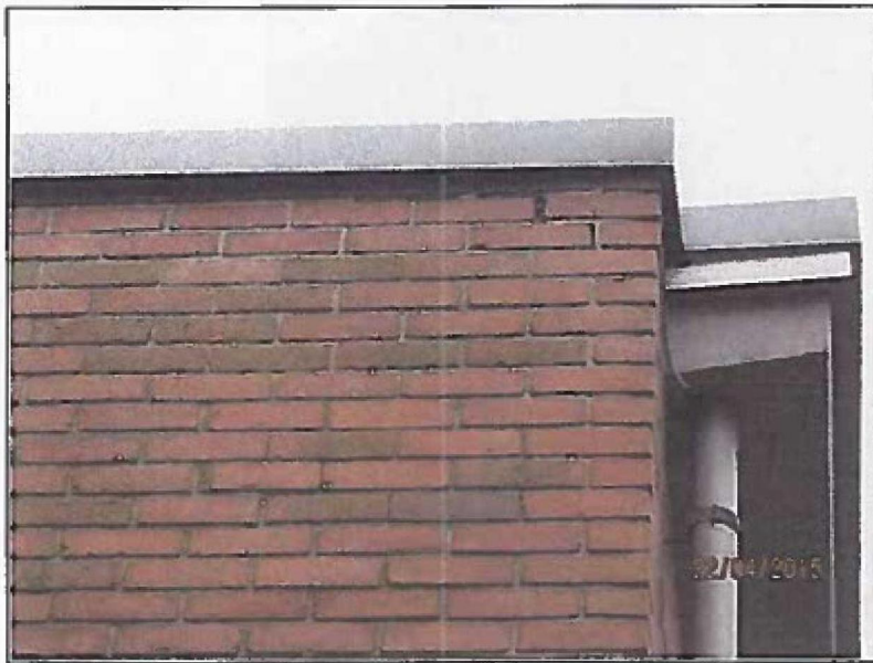
Schade 14, Horizontale scheuren en losse stenen (57784 22-4 (154))
