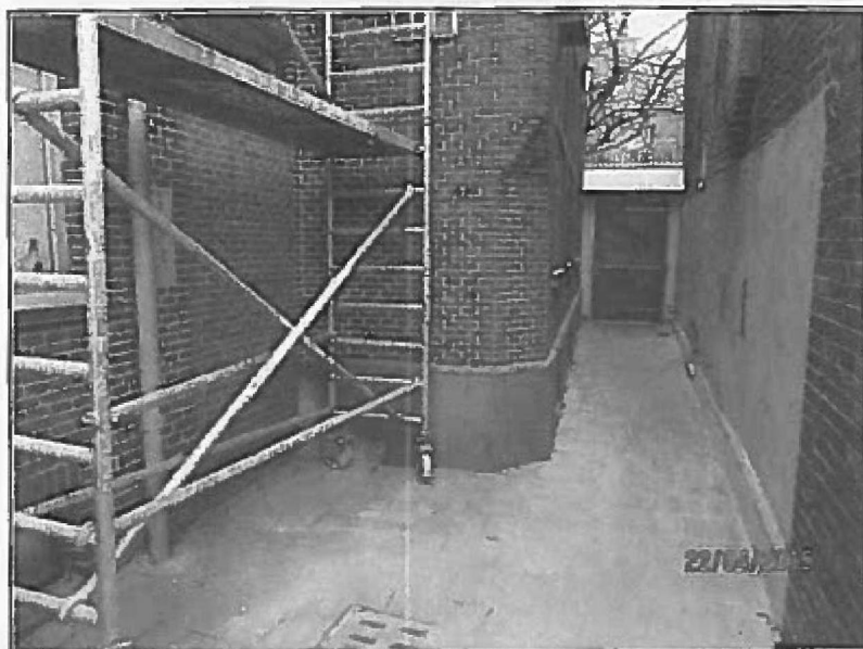
Schade 4, Verticale scheur in natuursteen plint (57784 22-4 (81))
