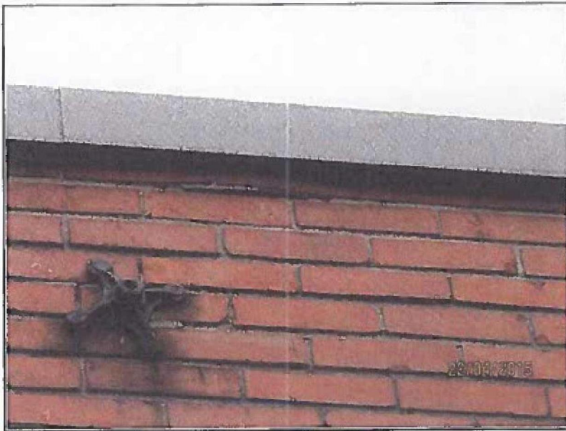
Schade 12, Horizontale scheuren en losse stenen (57784 22-4 (141))
