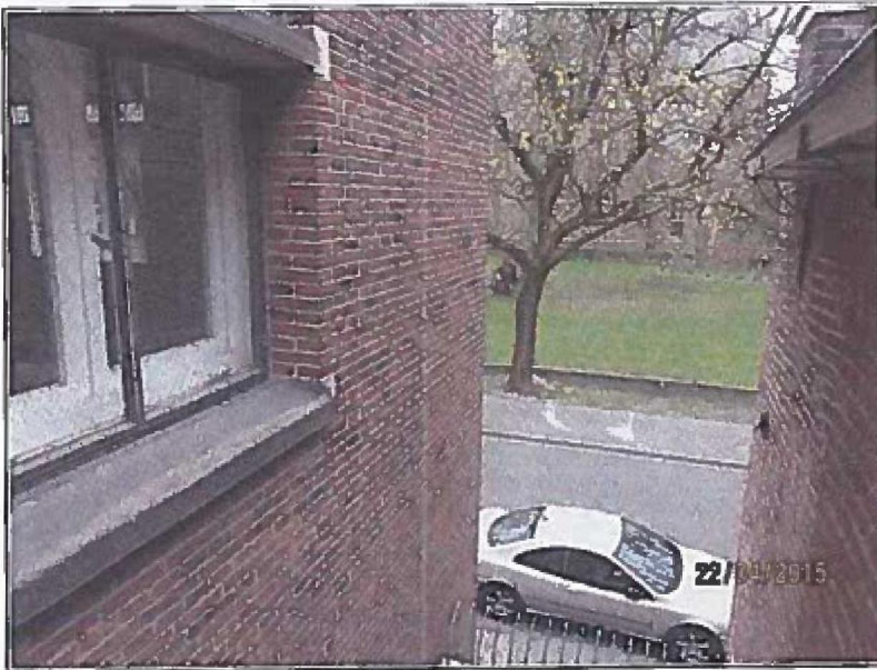
Schade 3, Verticale en horizontale scheuren (57784 22-4 (63))
