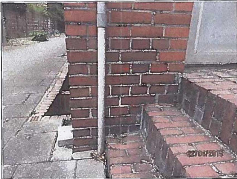
Schade 11, Diverse scheuren in voeg en stenen. (57784 22-4 (128))
