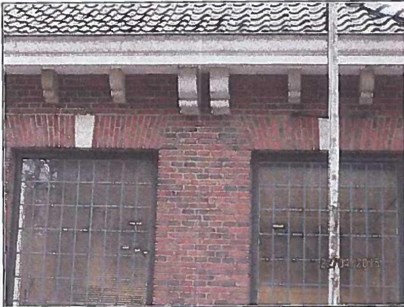
Schade 1, Horizontale scheur in de voeg. (57784 22-4 (10))
