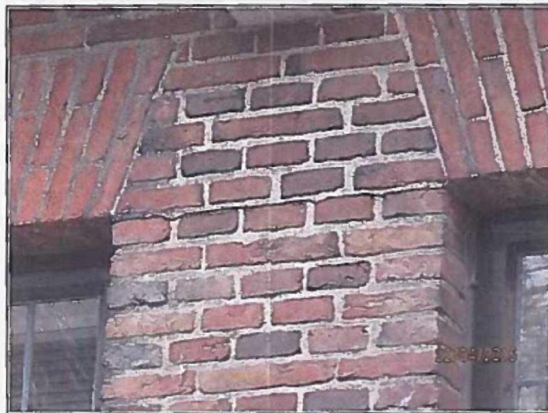
Schade 1, Horizontale scheur in de voeg. (57784 22-4 (35))
