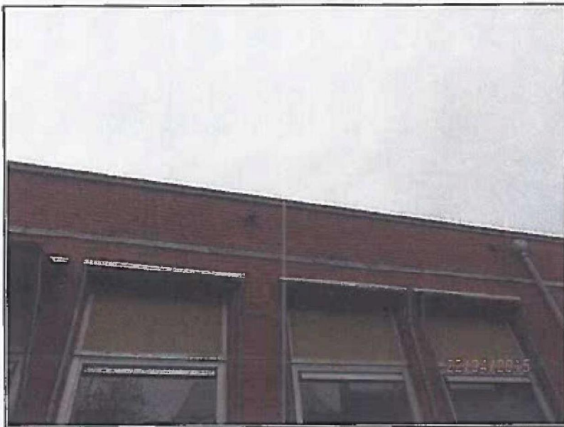
Schade 12, Horizontale scheuren en losse stenen (57784 22-4 (140))
