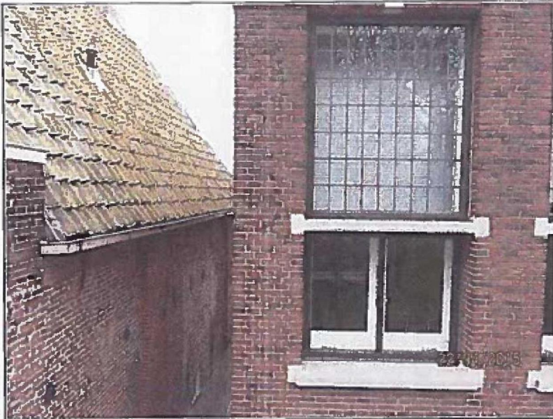
Schade 3, Verticale en horizontale scheuren (57784 22-4 (40))
