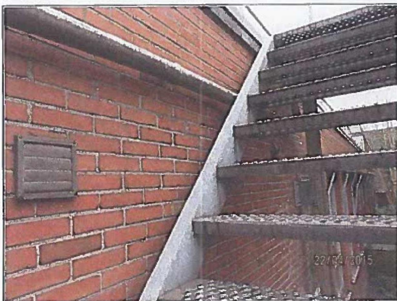
Schade 14, Horizontale scheuren en losse stenen (57784 22-4 (162))
