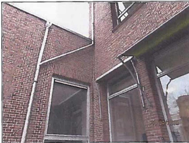
Schade 10, Verticale scheur in hoek aansluiting (57784 22-4 (119))
