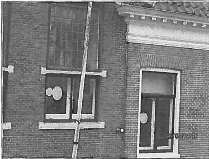
Schade 3, Verticale en horizontale scheuren (57784 22-4 (12))
