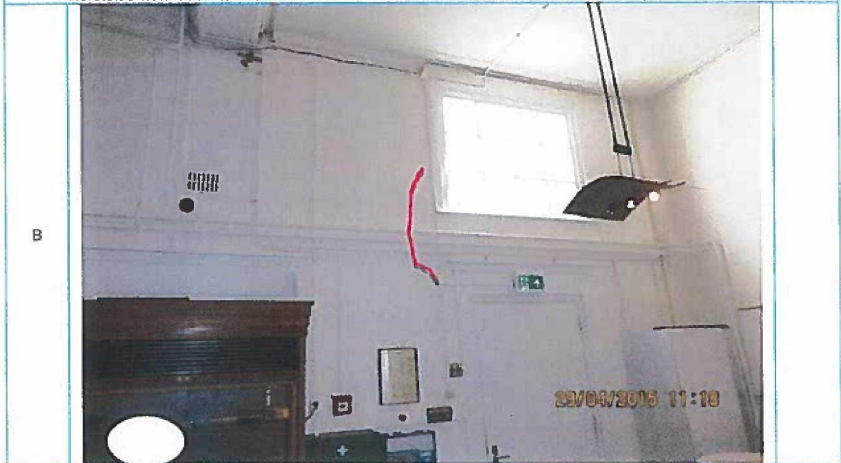
Foto 66. Gang, begane grond (achterzijde). Scheurvorming in stucwerk. Lengte ca. 1,25 meter. Stucwerk t.p.v. scheur verwijderen. Achterliggende scheur diep uitkrabben en herstellen met plastisch blijvend epoxy vulmateriaal. Herstelde wanddeel uitvlakken/aanhelen aan bestaand stucwerk. Sauswerk ca. 15,0 m 2 .
