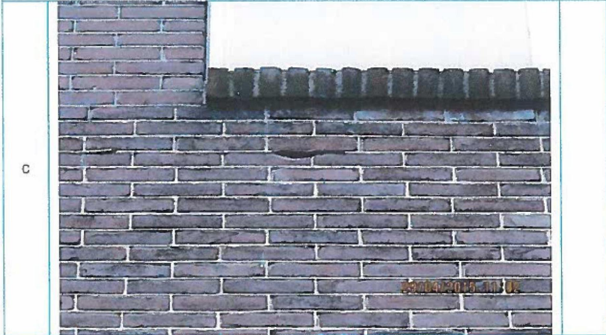
Foto 50. Detail foto 50. Deels ontbreken van metselwerk. Geen gerelateerde bevestigsschade.
