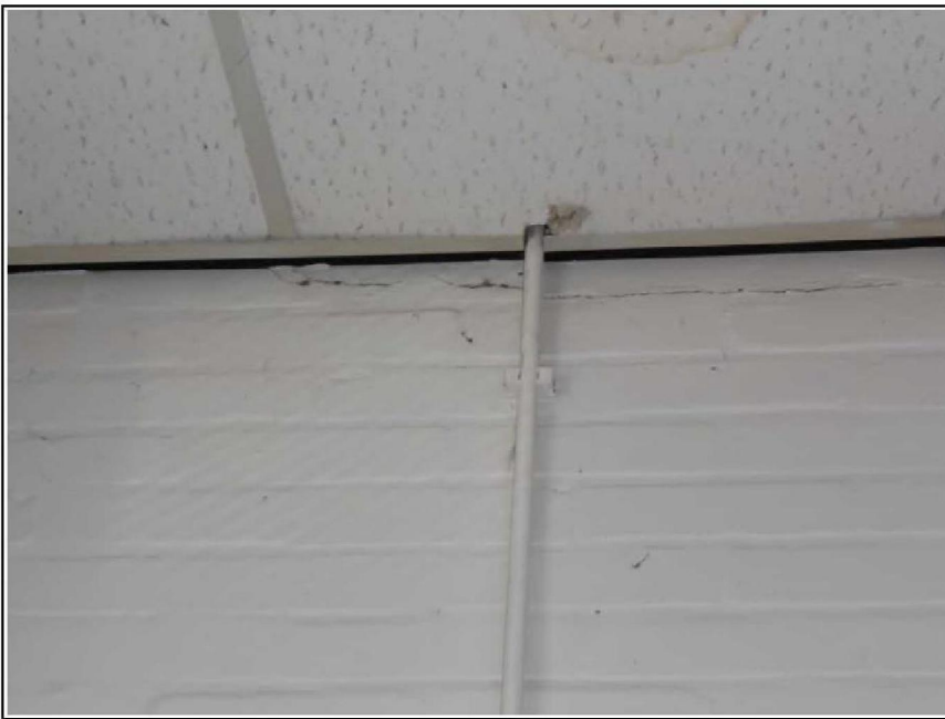
Schade 9, Scheurvorming in metselwerk. (42)
