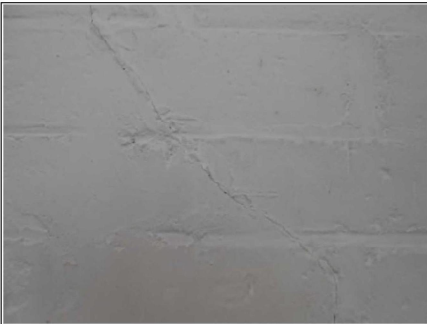
Schade 8, Scheurvorming in metselwerk. (36)
