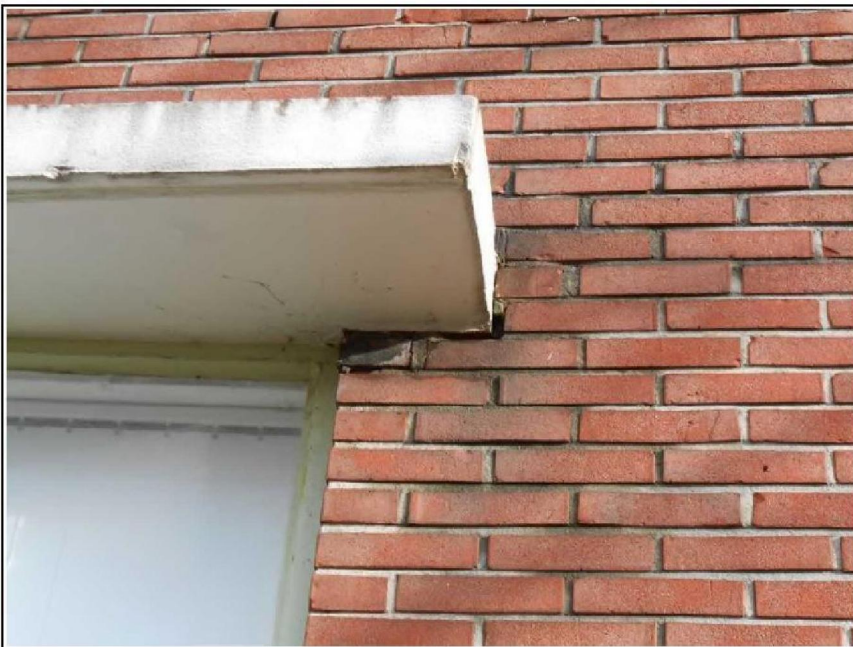
Schade 3, Scheurvorming in metselwerk. (18)
