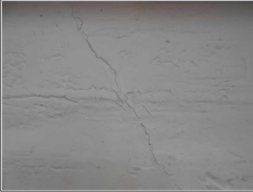
Schade 8, Scheurvorming in metselwerk. (35)
