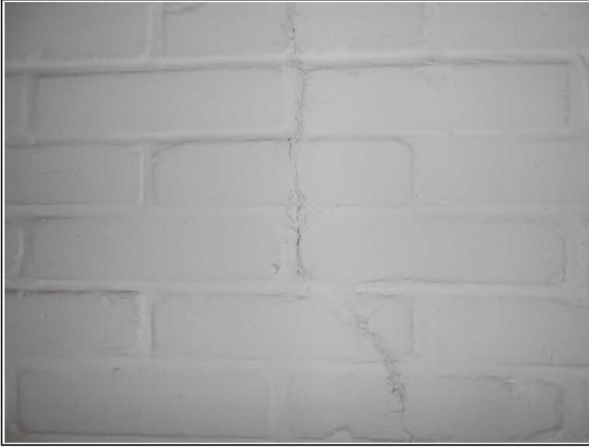
Schade 10, Scheurvorming in metselwerk. (55)
