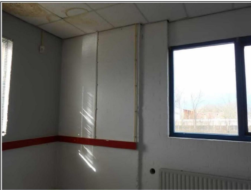
Schade 9, Scheurvorming in metselwerk. (40)
