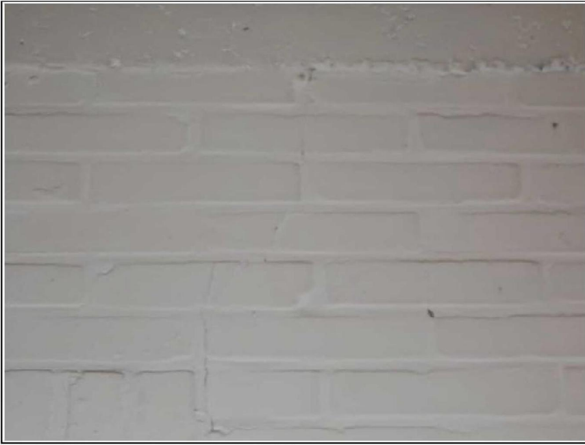
Schade 10, Scheurvorming in metselwerk. (63)
