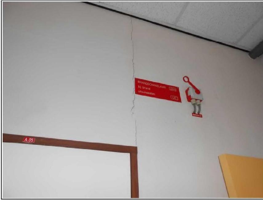
Schade 13, Scheurvorming tussen plaatmateriaal. (81)
