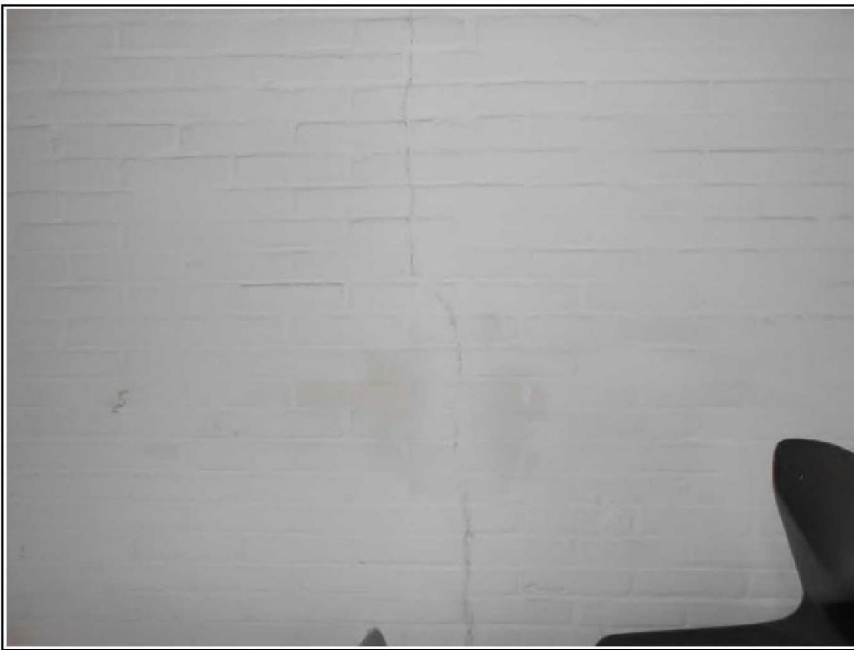
Schade 10, Scheurvorming in metselwerk. (54)
