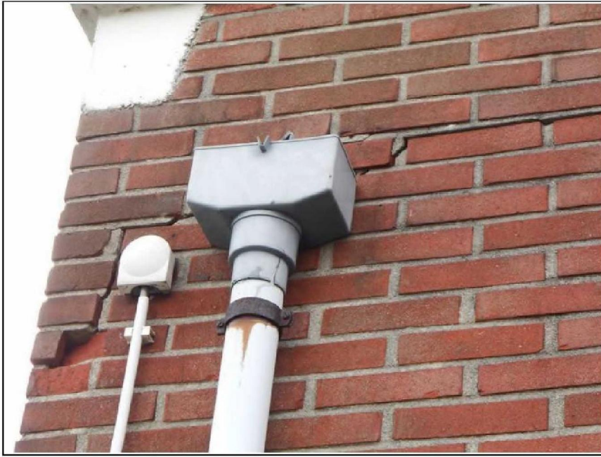
Schade 1, Scheurvorming in metselwerk. (11)
