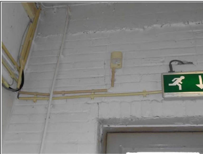
Schade 8, Scheurvorming in metselwerk. (38)
