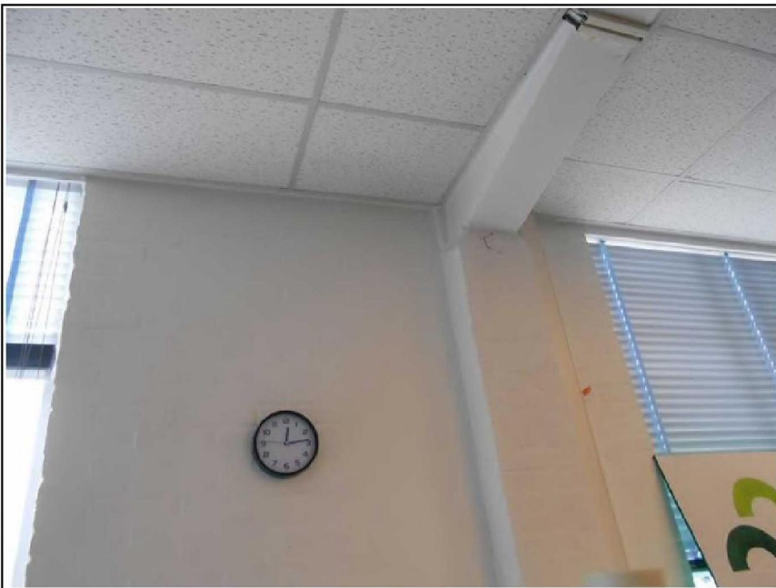
Schade 12, Scheurvorming in metselwerk. (72)
