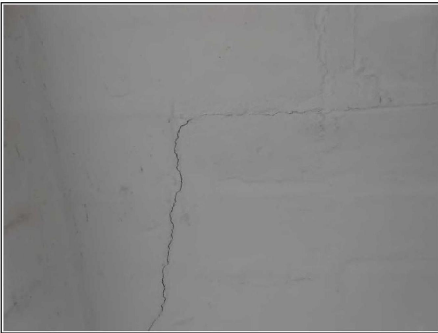
Schade 8, Scheurvorming in metselwerk. (32)
