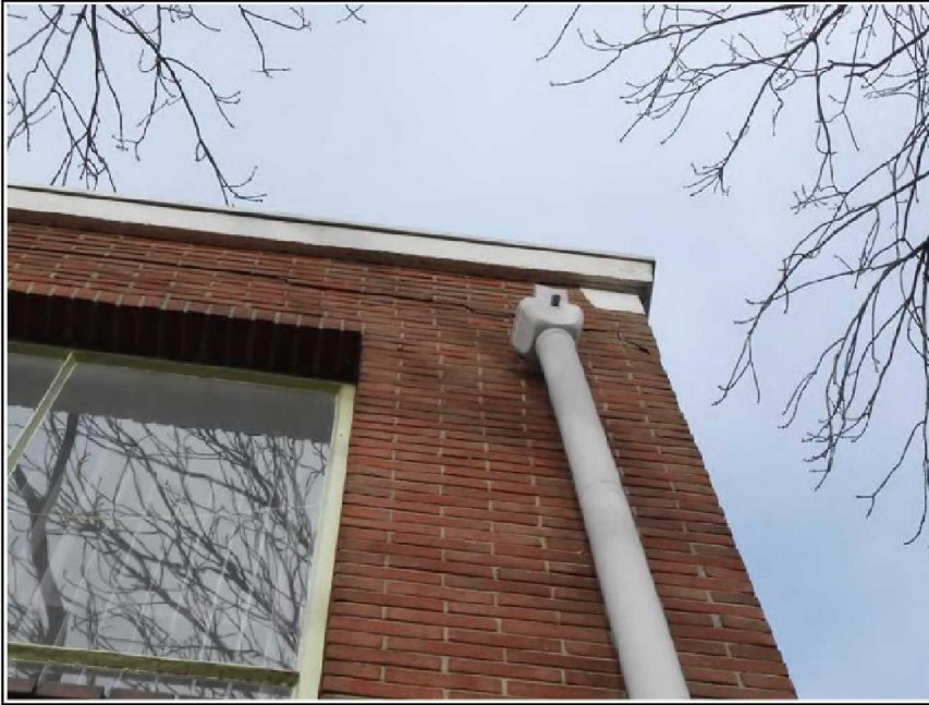
Schade 1, Scheurvorming in metselwerk. (05)
