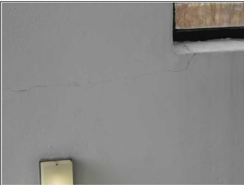
Schade 11, Scheurvorming in pleisterwerk. (68)
