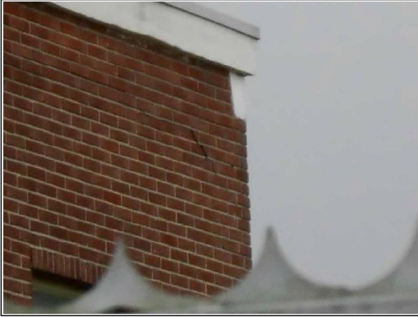
Schade 1, Scheurvorming in metselwerk. (15)
