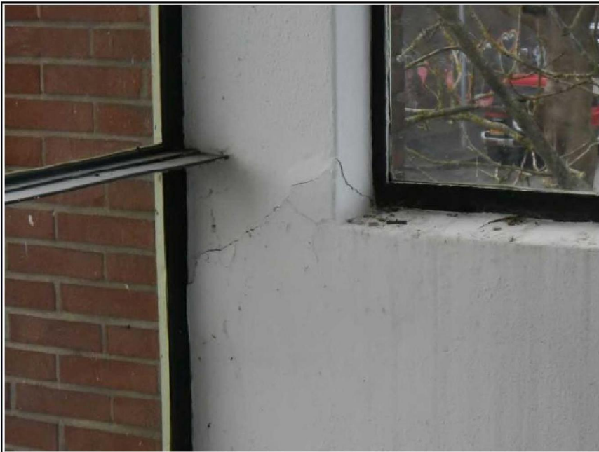
Schade 11, Scheurvorming in pleisterwerk. (66)
