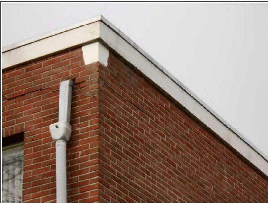
Schade 1, Scheurvorming in metselwerk. (08)
