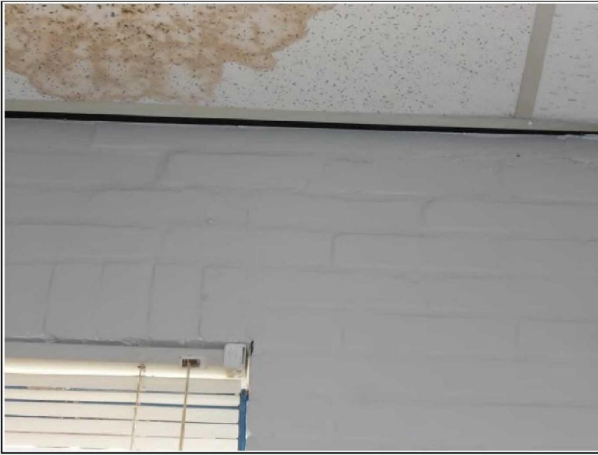
Schade 9, Scheurvorming in metselwerk. (43)
