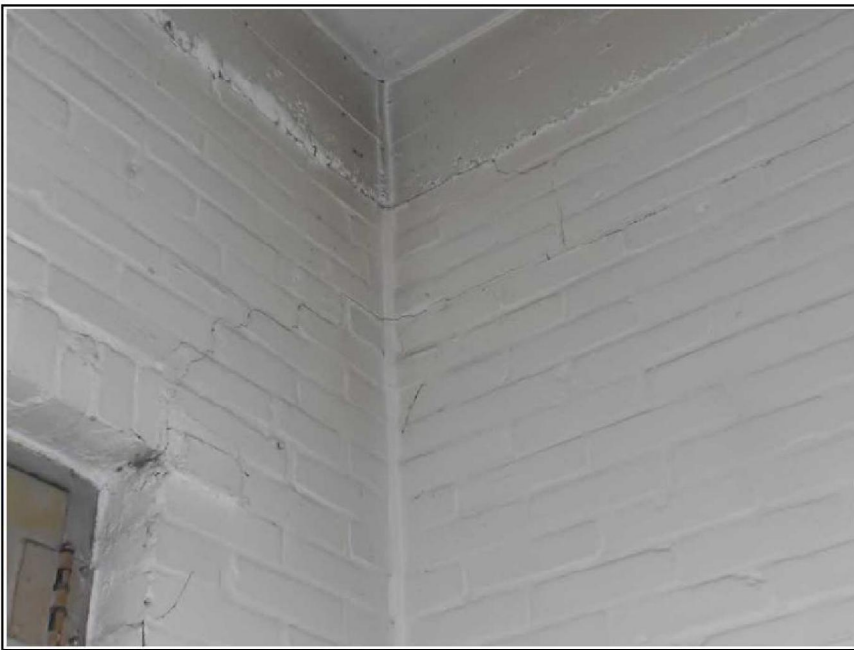
Schade 10, Scheurvorming in metselwerk. (44)
