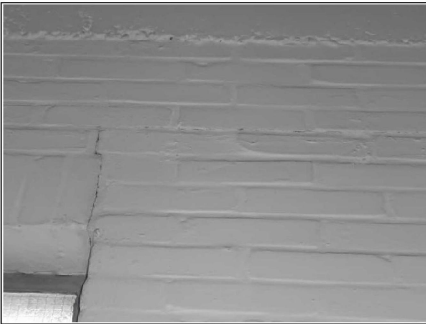
Schade 10, Scheurvorming in metselwerk. (60)
