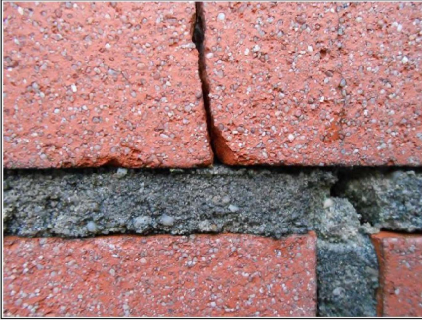
Schade 6, Scheurvorming in metselwerk. (27)
