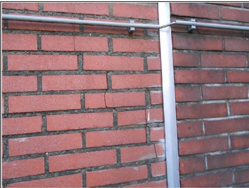
Schade 6, Scheurvorming in metselwerk. (26)
