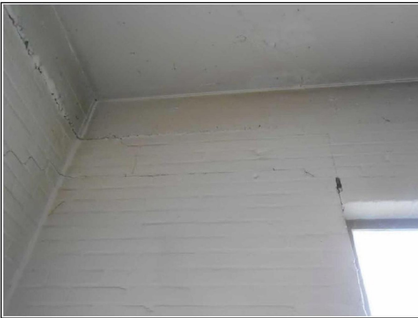
Schade 10, Scheurvorming in metselwerk. (46)
