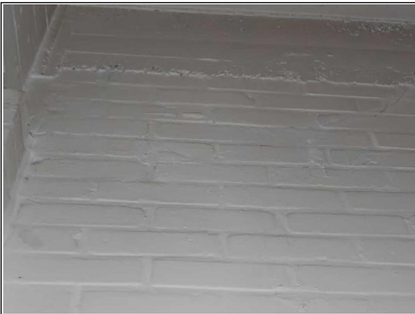
Schade 10, Scheurvorming in metselwerk. (52)
