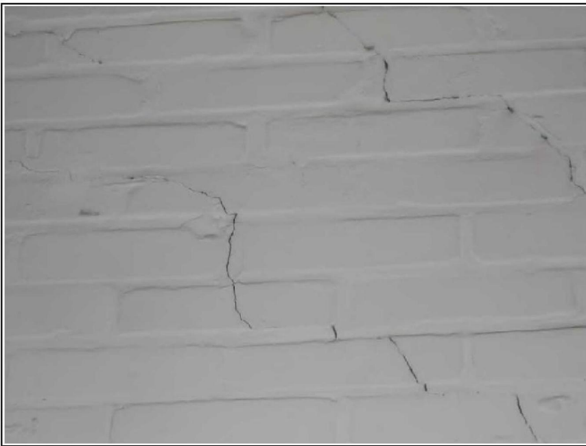
Schade 10, Scheurvorming in metselwerk. (64)
