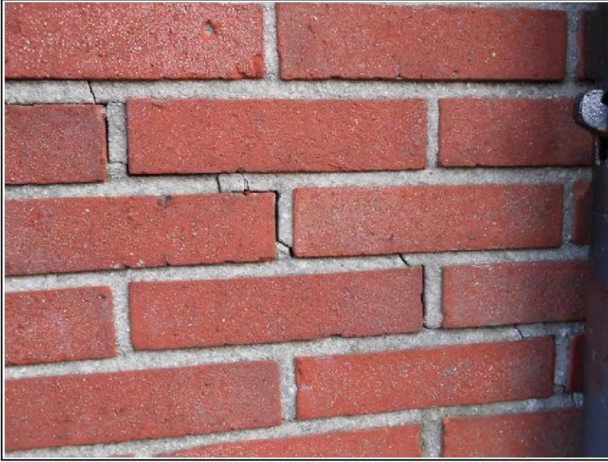
Schade 2, Scheurvorming in metselwerk. (17)
