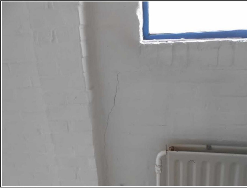
Schade 8, Scheurvorming in metselwerk. (31)
