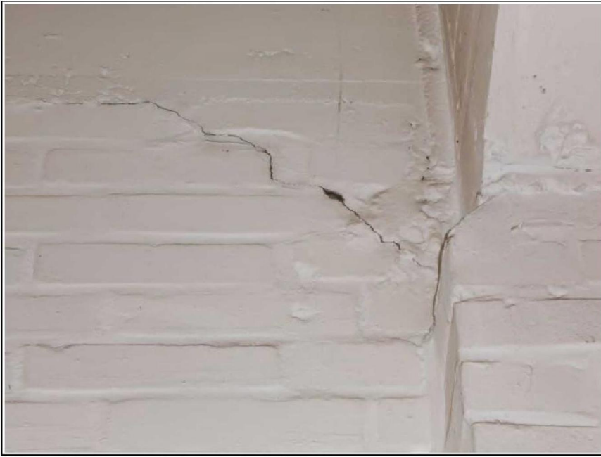
Schade 10, Scheurvorming in metselwerk. (61)
