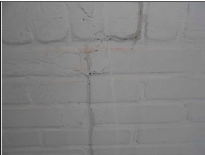
Schade 10, Scheurvorming in metselwerk. (56)
