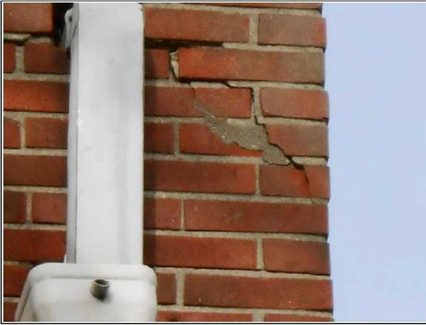
Schade 1, Scheurvorming in metselwerk. (07)
