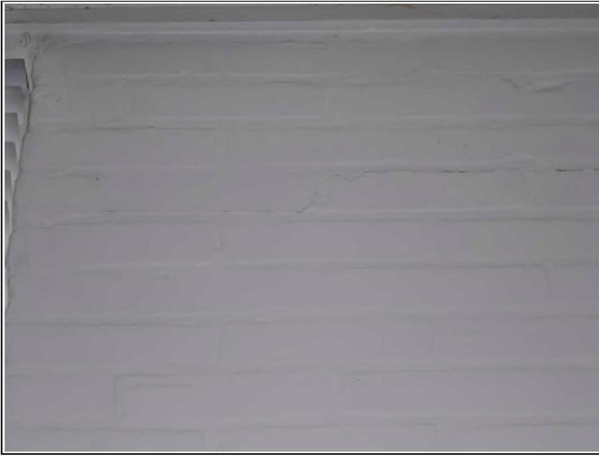
Schade 12, Scheurvorming in metselwerk. (73)
