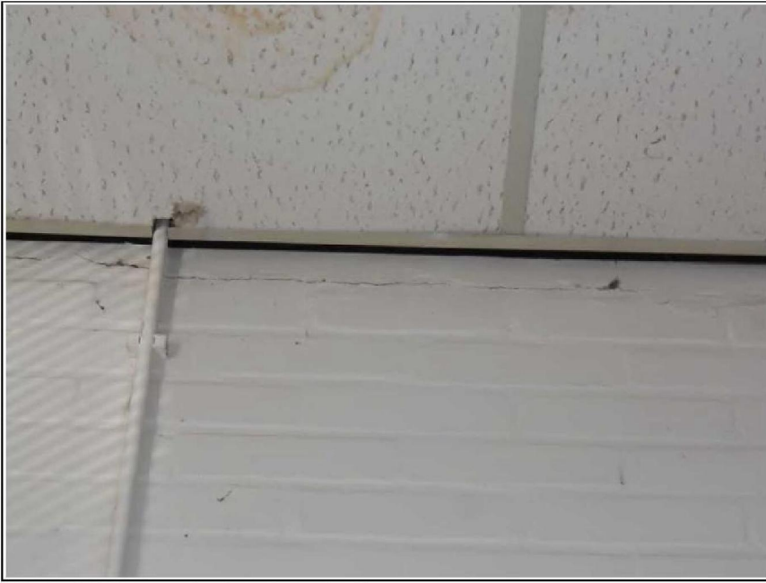
Schade 9, Scheurvorming in metselwerk. (41)
