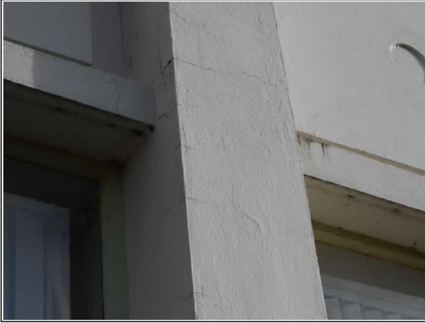
Schade 4, Scheurvorming in beton elementen. (19)
