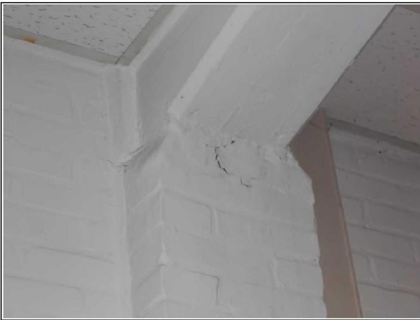
Schade 12, Scheurvorming in metselwerk. (74)
