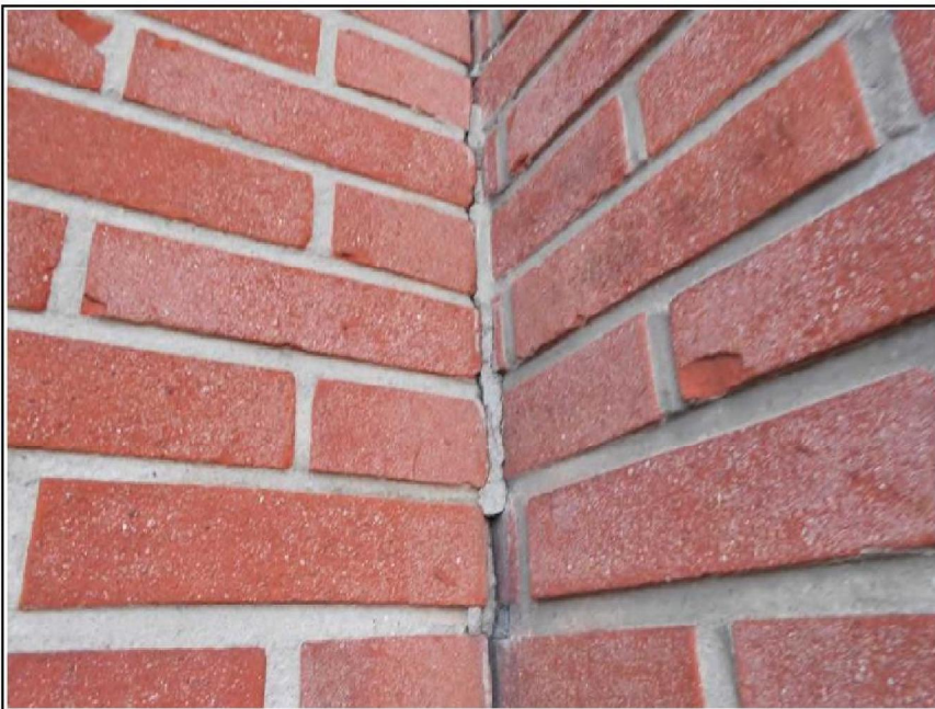
Schade 7, Scheurvorming tussen geveldelen. (30)
