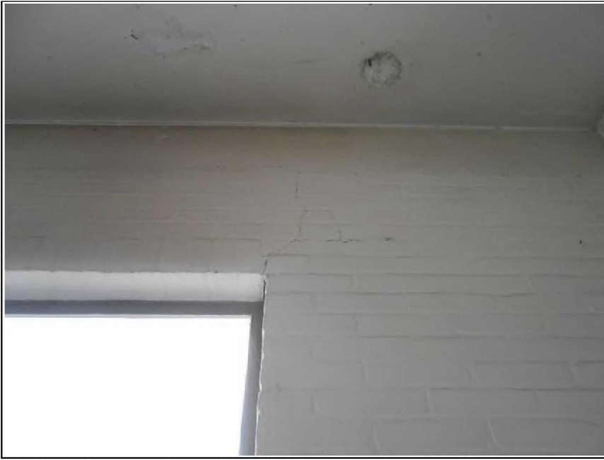
Schade 10, Scheurvorming in metselwerk. (49)
