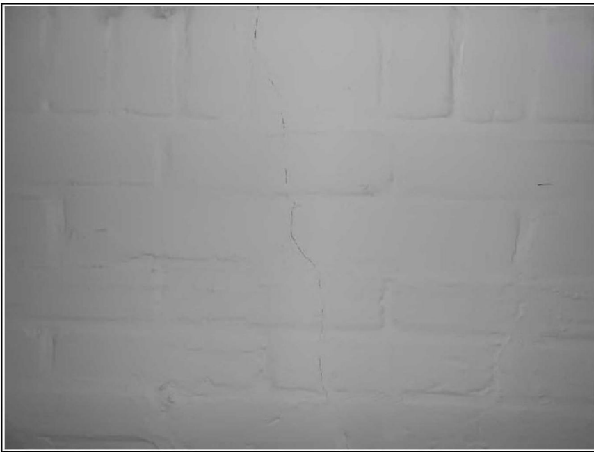
Schade 12, Scheurvorming in metselwerk. (78)
