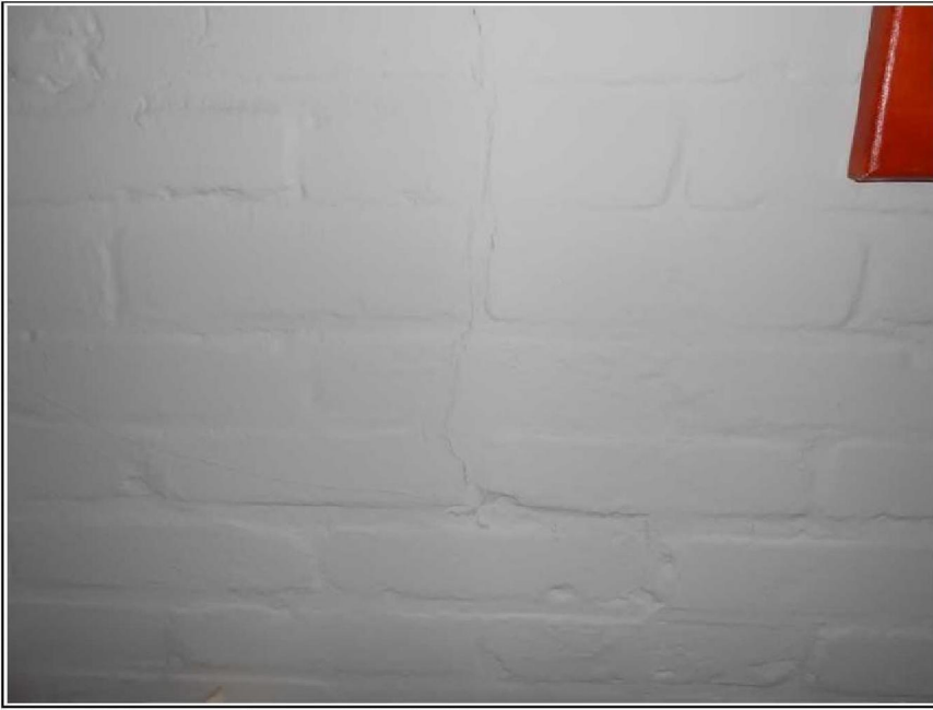
Schade 12, Scheurvorming in metselwerk. (77)
