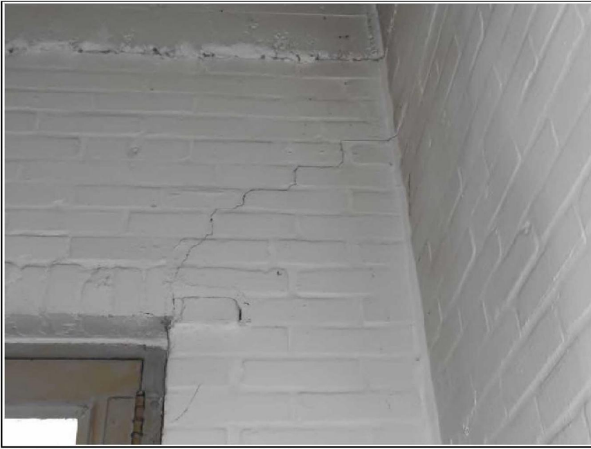
Schade 10, Scheurvorming in metselwerk. (45)
