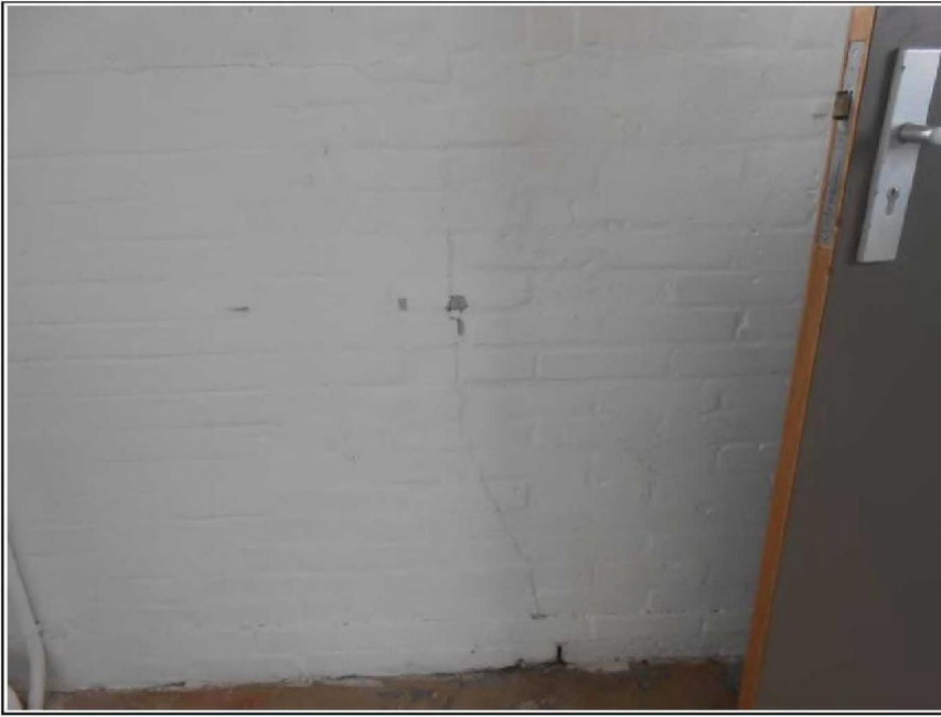
Schade 8, Scheurvorming in metselwerk. (33)
