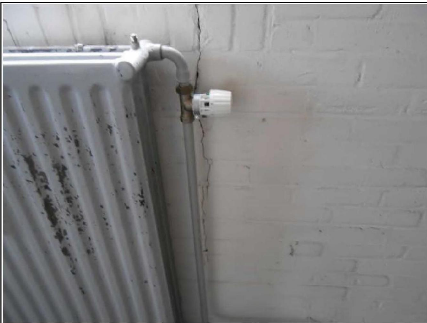
Schade 10, Scheurvorming in metselwerk. (48)
