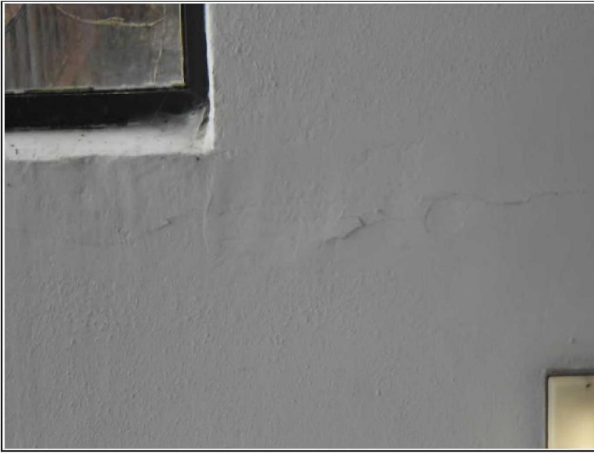
Schade 11, Scheurvorming in pleisterwerk. (67)
