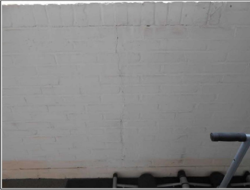
Schade 10, Scheurvorming in metselwerk. (59)
