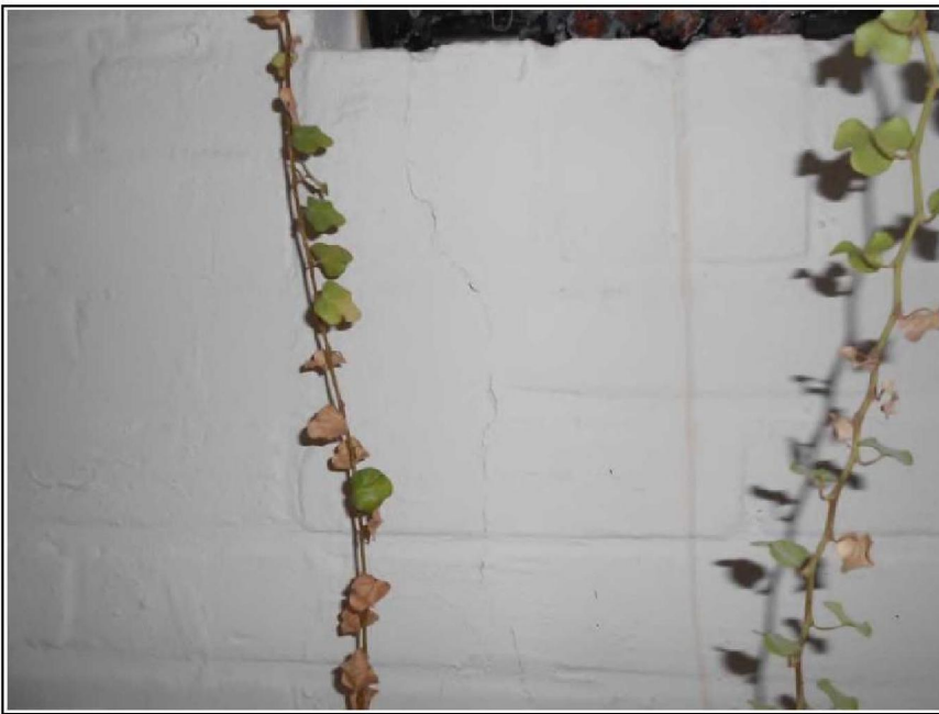
Schade 12, Scheurvorming in metselwerk. (76)
