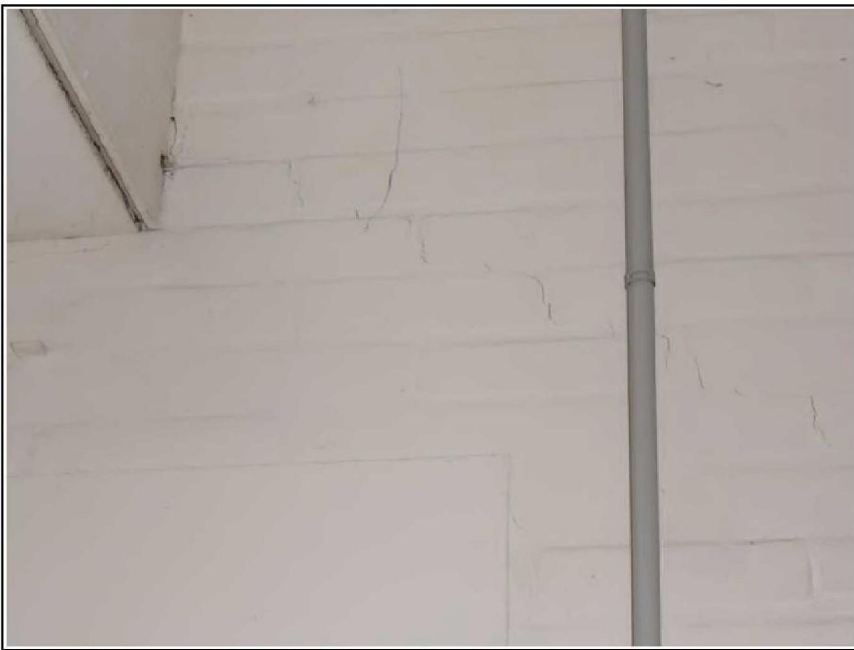
Schade 12, Scheurvorming in metselwerk. (80)
