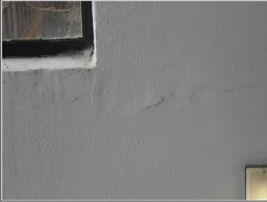
Schade 11, Scheurvorming in pleisterwerk. (67)
