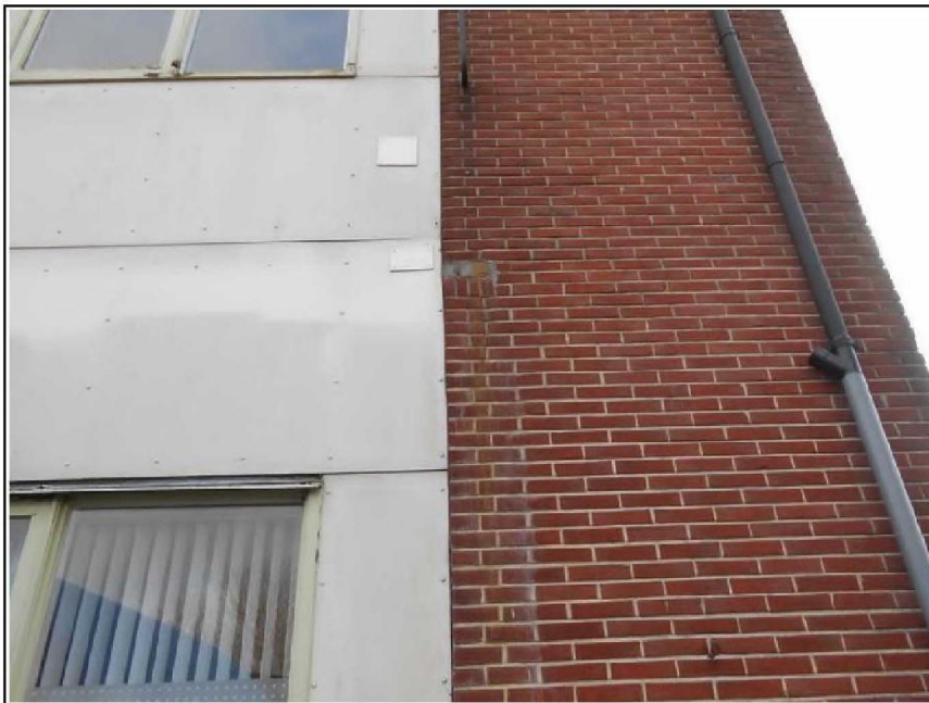
Schade 5, Scheurvorming in metselwerk. (22)
