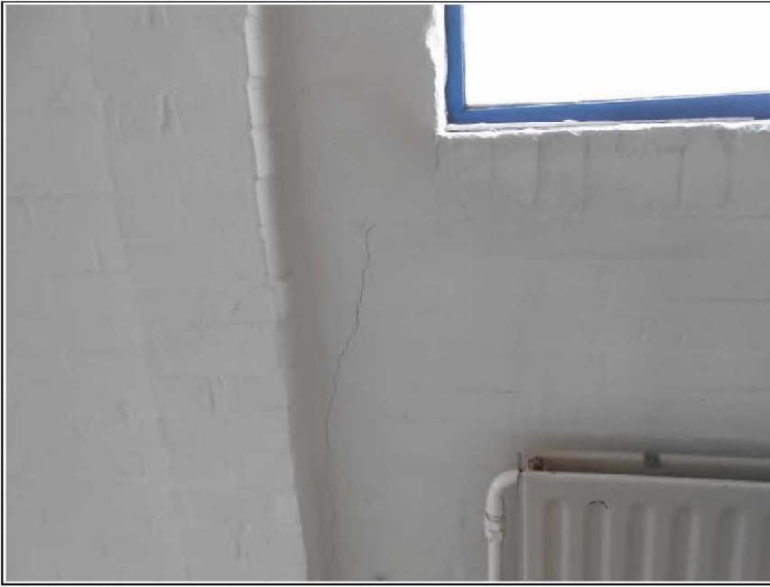
Schade 8, Scheurvorming in metselwerk. (31)
