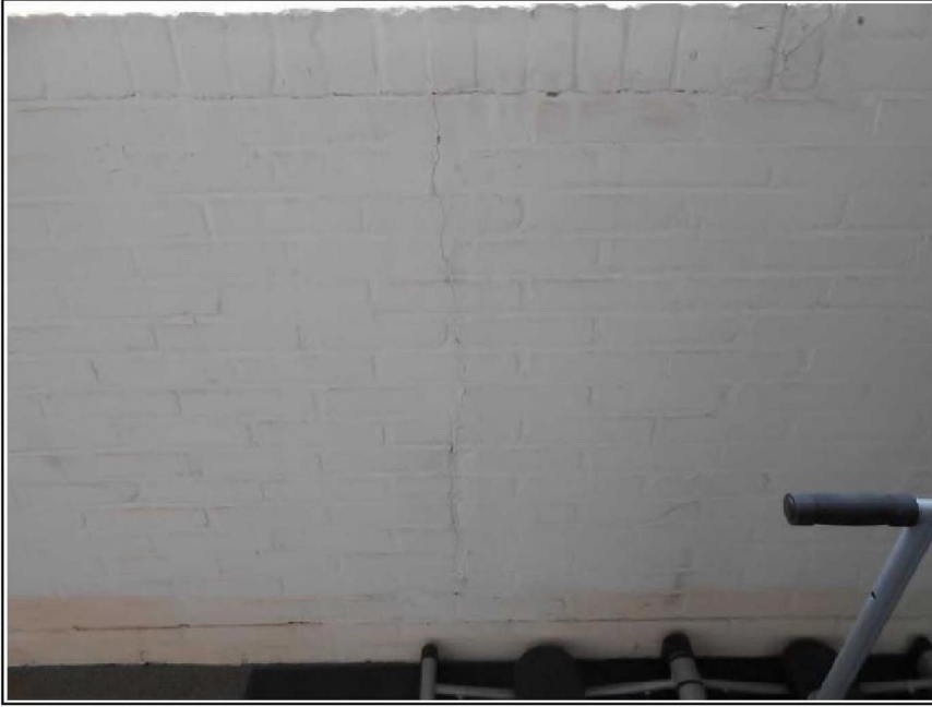
Schade 10, Scheurvorming in metselwerk. (59)
