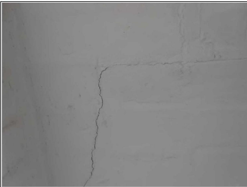
Schade 8, Scheurvorming in metselwerk. (32)
