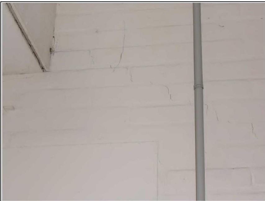
Schade 12, Scheurvorming in metselwerk. (80)
