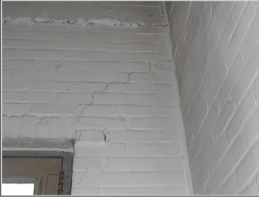
Schade 10, Scheurvorming in metselwerk. (45)
