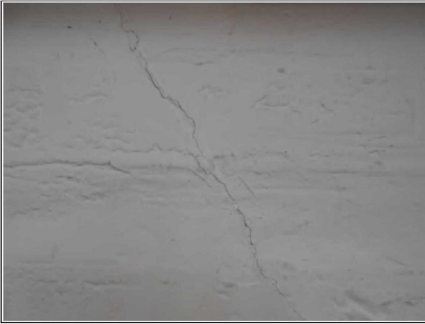
Schade 8, Scheurvorming in metselwerk. (35)
