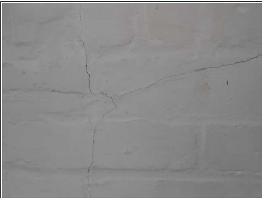
Schade 8, Scheurvorming in metselwerk. (34)
