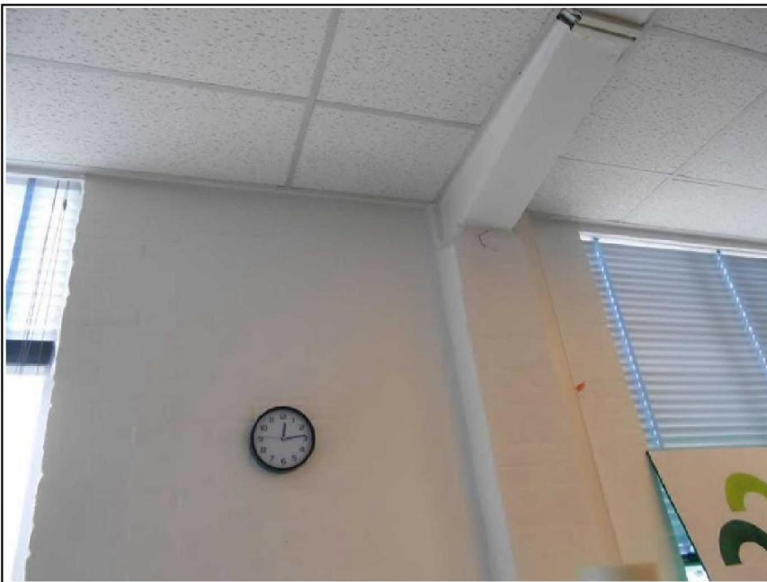
Schade 12, Scheurvorming in metselwerk. (72)
