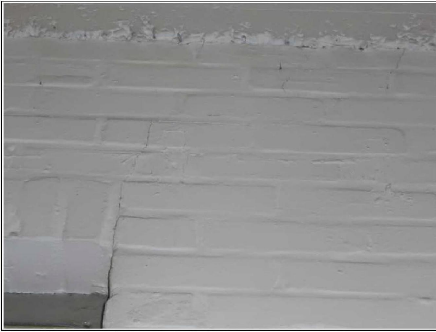
Schade 10, Scheurvorming in metselwerk. (57)
