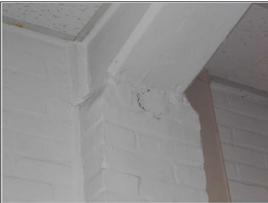
Schade 12, Scheurvorming in metselwerk. (74)
