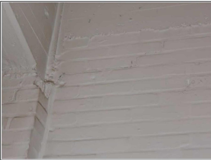
Schade 10, Scheurvorming in metselwerk. (58)
