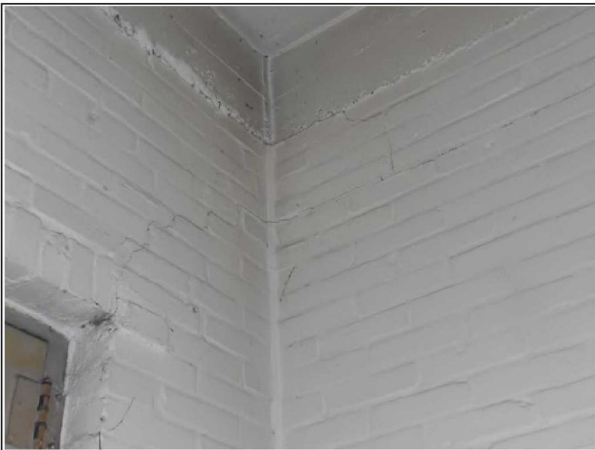
Schade 10, Scheurvorming in metselwerk. (44)
