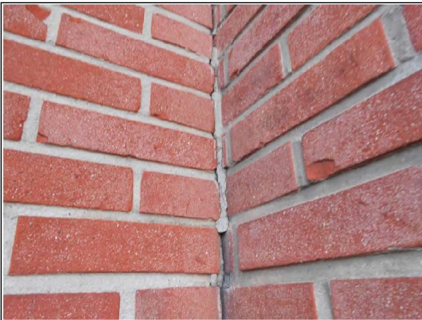
Schade 7, Scheurvorming tussen geveldelen. (30)
