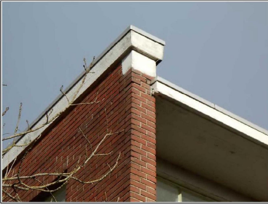
Schade 1, Scheurvorming in metselwerk. (09)
