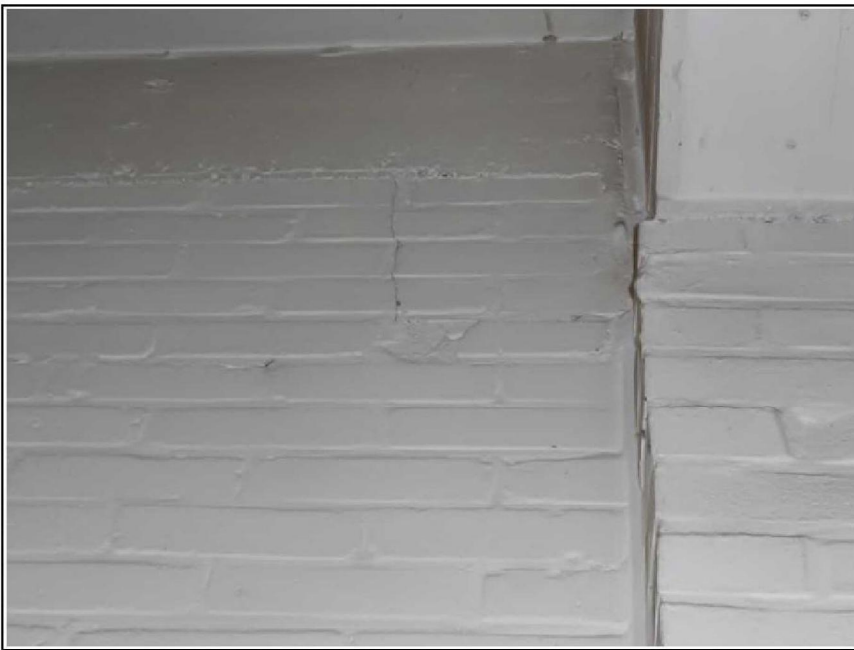
Schade 10, Scheurvorming in metselwerk. (50)
