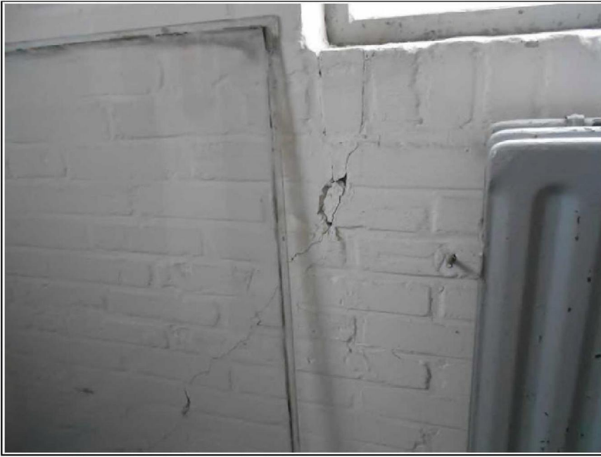
Schade 10, Scheurvorming in metselwerk. (47)
