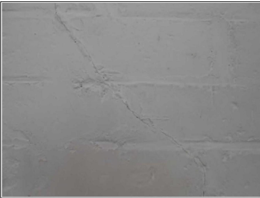
Schade 8, Scheurvorming in metselwerk. (36)
