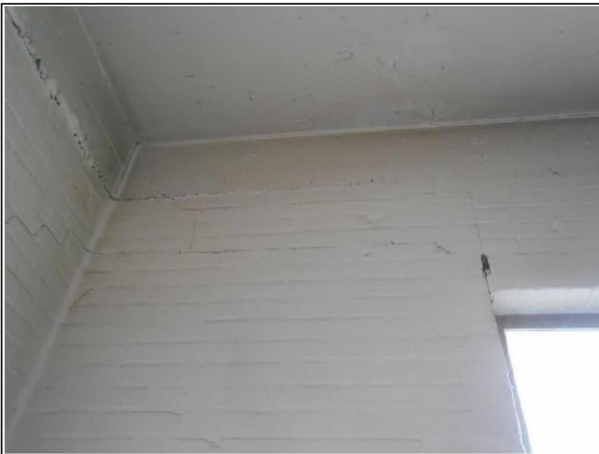
Schade 10, Scheurvorming in metselwerk. (46)
