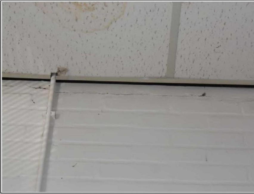
Schade 9, Scheurvorming in metselwerk. (41)
