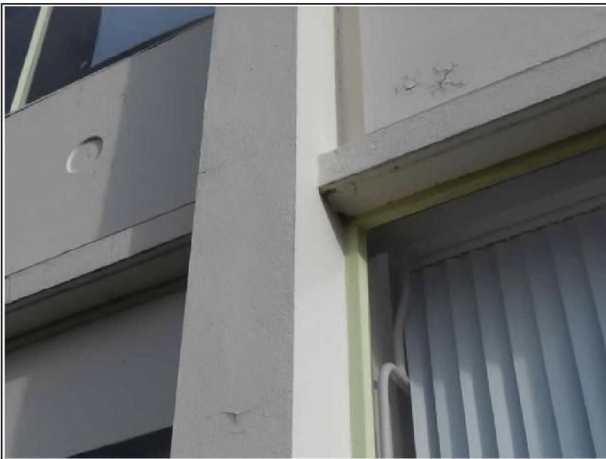
Schade 4, Scheurvorming in beton elementen. (20)
