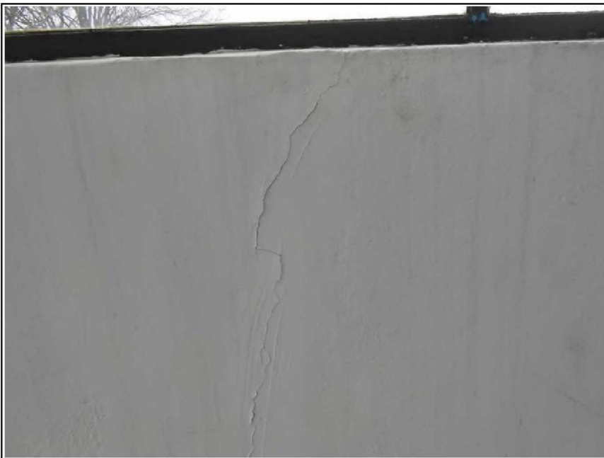
Schade 11, Scheurvorming in pleisterwerk. (70)
