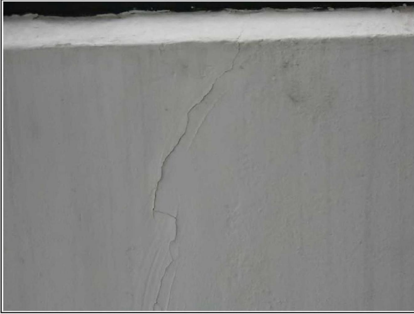
Schade 11, Scheurvorming in pleisterwerk. (69)
