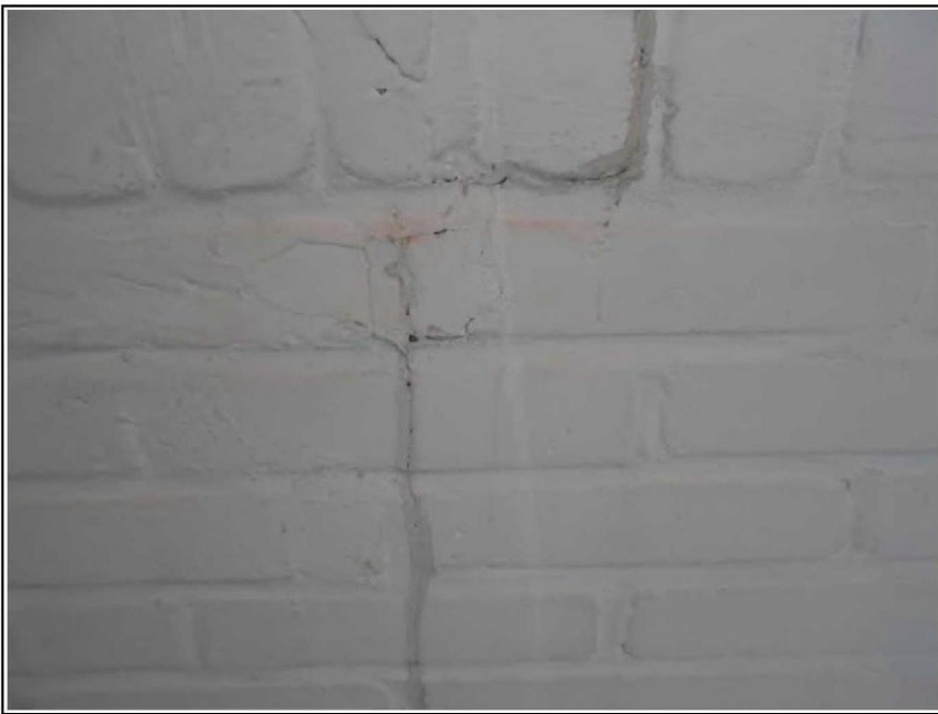
Schade 10, Scheurvorming in metselwerk. (56)
