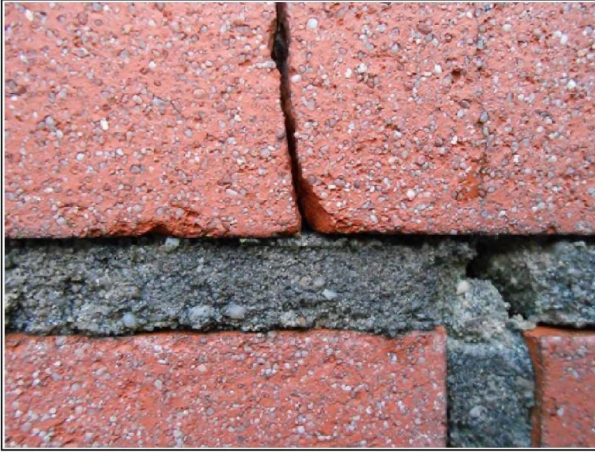
Schade 6, Scheurvorming in metselwerk. (27)
