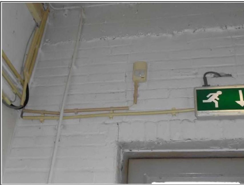
Schade 8, Scheurvorming in metselwerk. (38)
