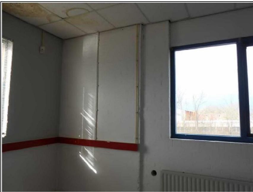
Schade 9, Scheurvorming in metselwerk. (40)
