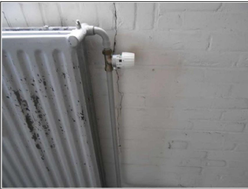
Schade 10, Scheurvorming in metselwerk. (48)
