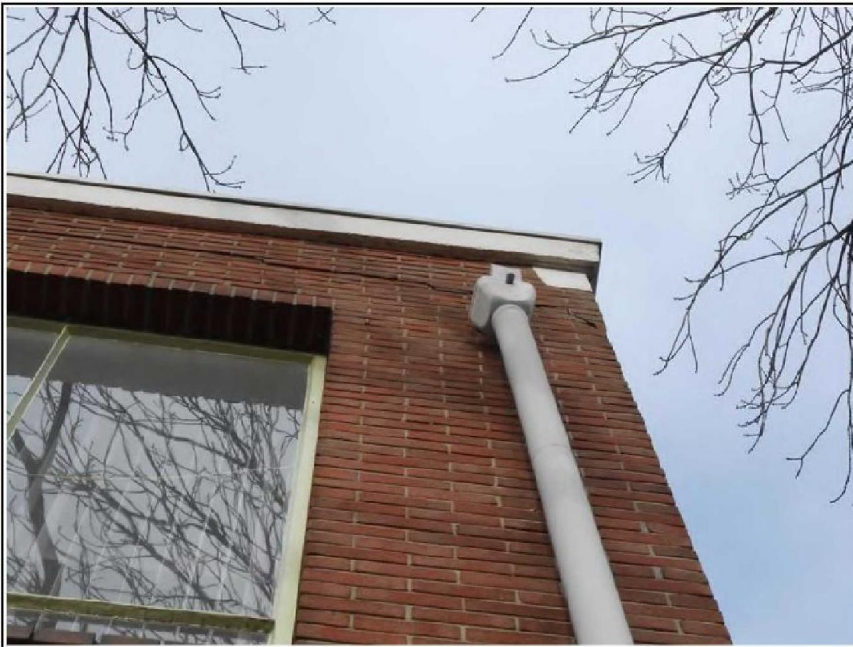
Schade 1, Scheurvorming in metselwerk. (05)
