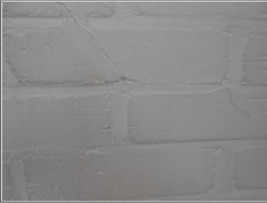
Schade 8, Scheurvorming in metselwerk. (37)
