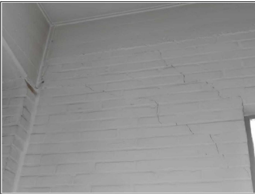
Schade 10, Scheurvorming in metselwerk. (62)
