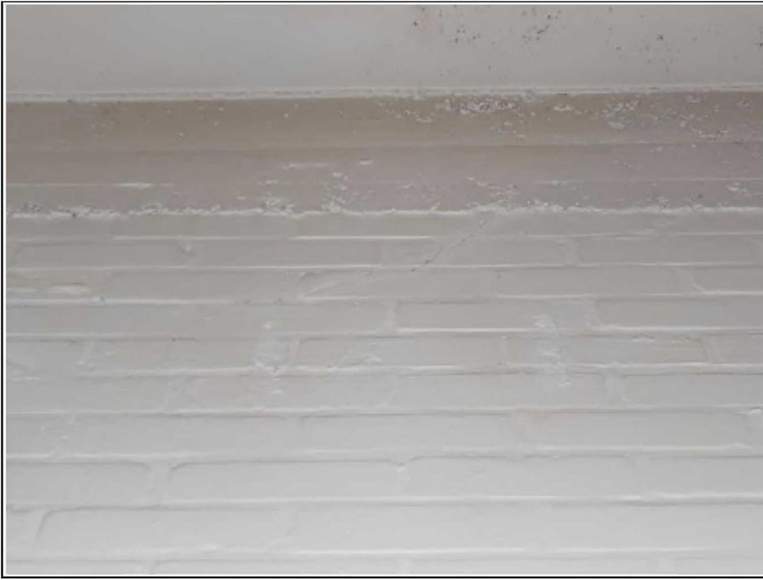
Schade 10, Scheurvorming in metselwerk. (53)
