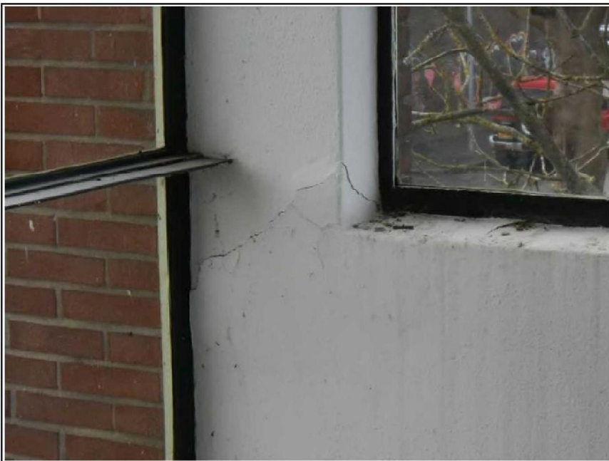
Schade 11, Scheurvorming in pleisterwerk. (66)
