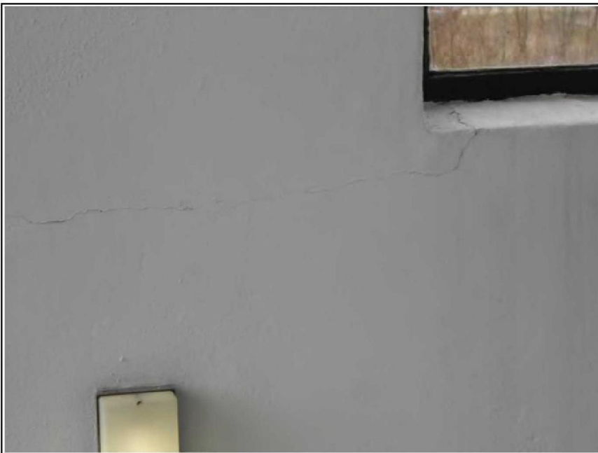
Schade 11, Scheurvorming in pleisterwerk. (68)
