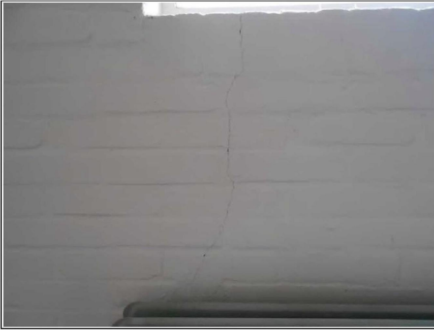
Schade 12, Scheurvorming in metselwerk. (75)
