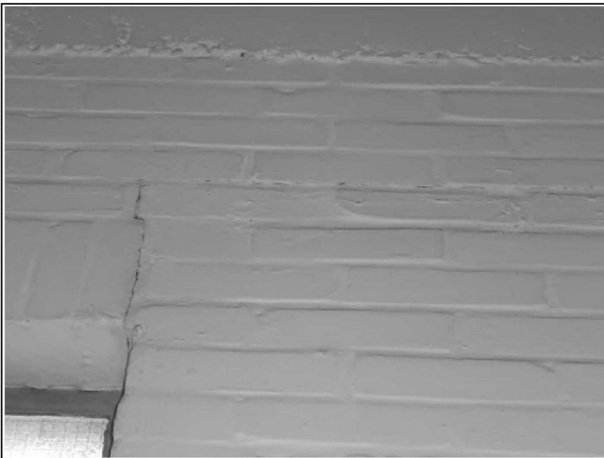
Schade 10, Scheurvorming in metselwerk. (60)
