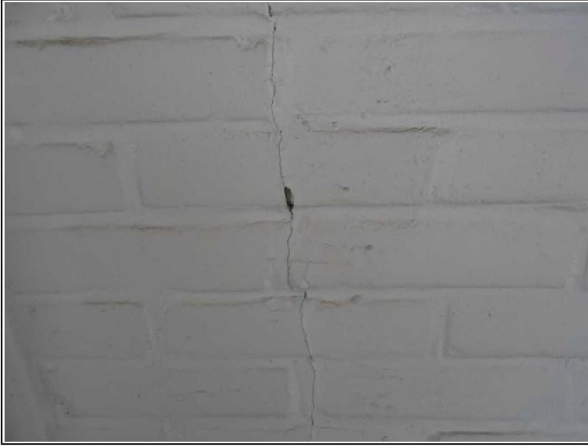
Schade 10, Scheurvorming in metselwerk. (65)
