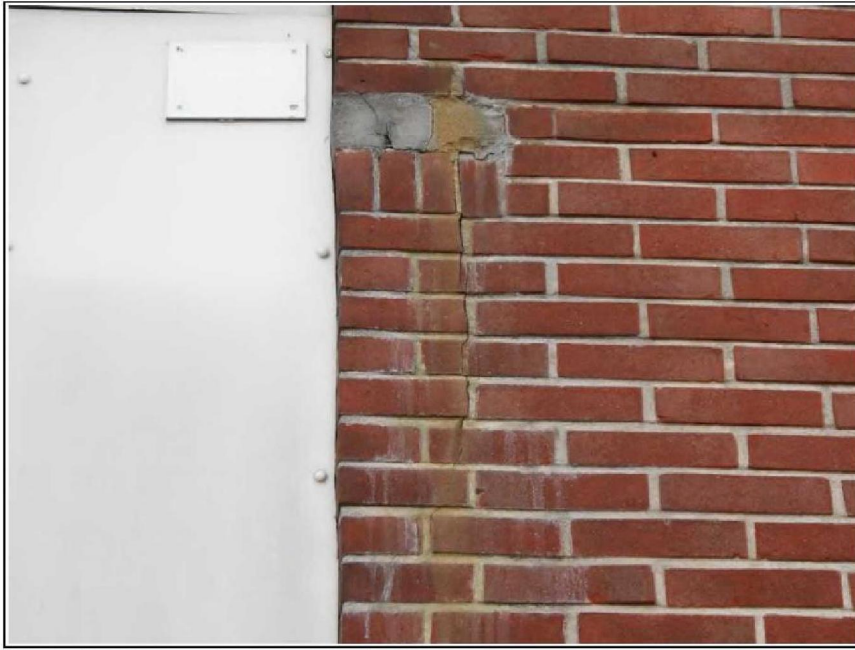
Schade 5, Scheurvorming in metselwerk. (21)
