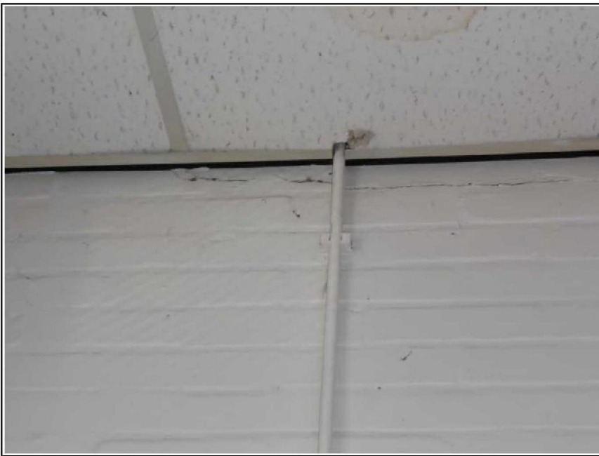
Schade 9, Scheurvorming in metselwerk. (42)
