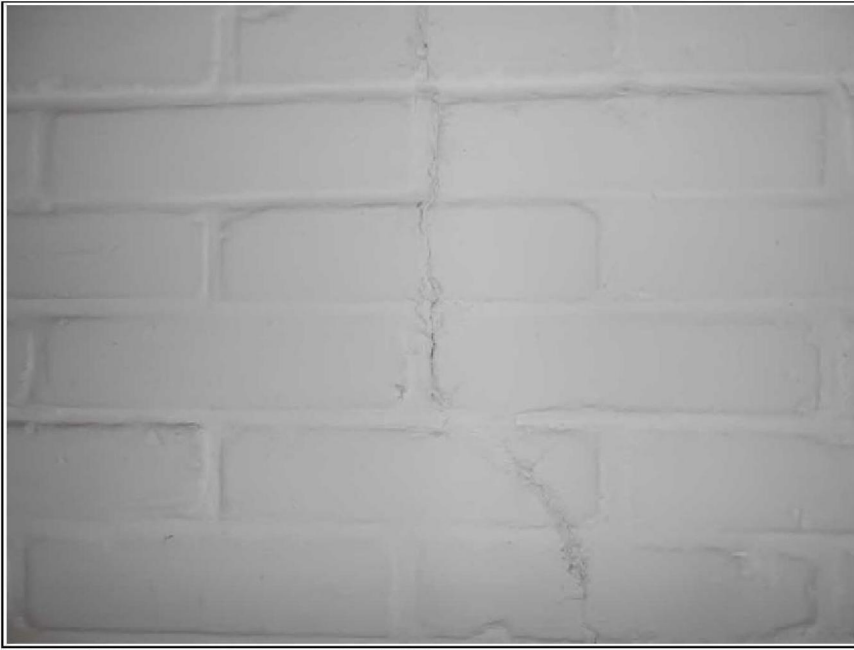
Schade 10, Scheurvorming in metselwerk. (55)
