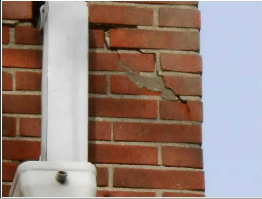
Schade 1, Scheurvorming in metselwerk. (07)
