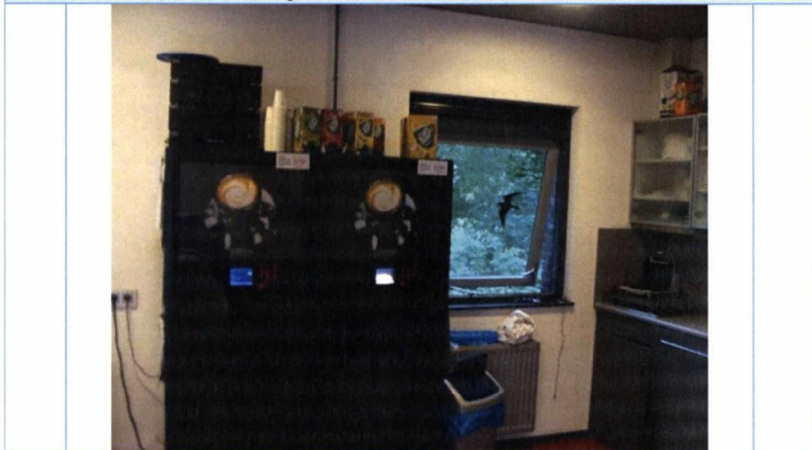
Foto 55. Aanzicht binnenmuur achtergevel. Scheur rechtsonder raam.
