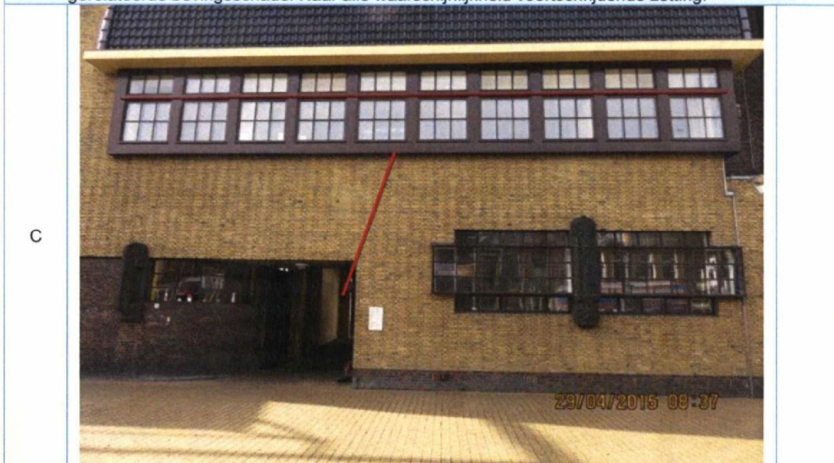
Foto 2. "Oude" scheurvorming in metselwerk, reeds eerder hersteld. Niet significant toegenomen. Geen gerelateerde bevingsschade. Naar alle waarschijnlijkheid voortschrijdende zetting.
