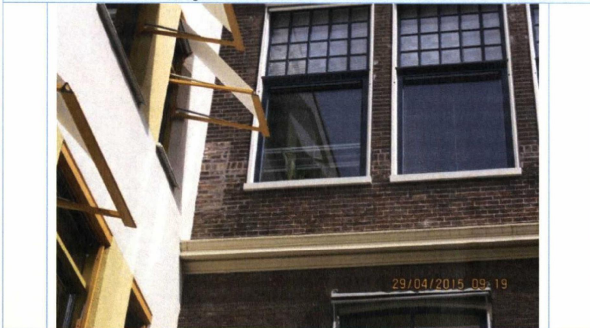
Foto 28. Reeds eerder hersteld, ingeboet metselwerk. Geen waarneembare schade.
