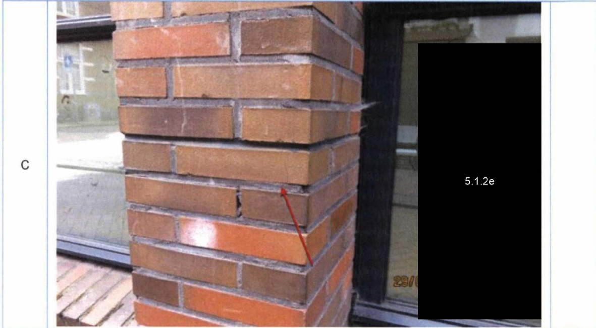
Foto 15. Scheurvorming in voegen, penant 8. Geen gerelateerde bevestigsschade.
