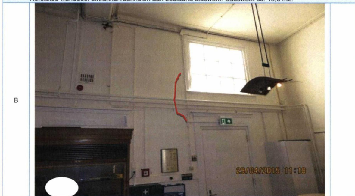
Foto 66. Gang, begane grond (achterzijde). Scheurvorming in stucwerk. Lengte ca. 1,25 meter. Stucwerk t.p.v. scheur verwijderen. Achterliggende scheur diep uitkrabben en herstellen met plastisch blijvend epoxy vulmateriaal. Herstelde wanddeel uitvlakken/aanhelen aan bestaand stucwerk. Sauswerk ca. 15,0 m2.
