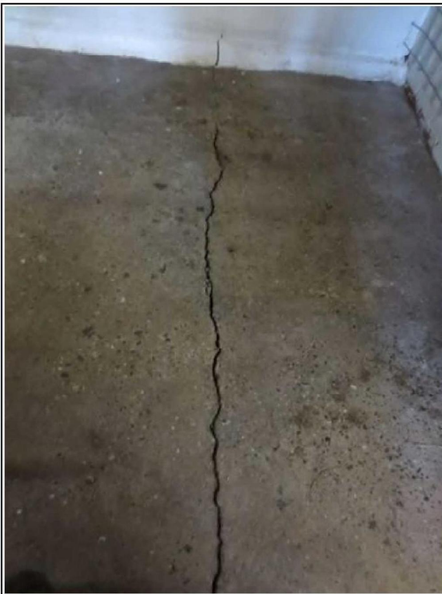
Schade 3, Scheurvorming in betonvloer. (IMG_8255)
