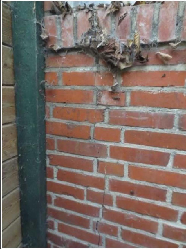
Schade 2, Scheurvorming in gevel metselwerk incl. gebroken stenen. (IMG_8253)
