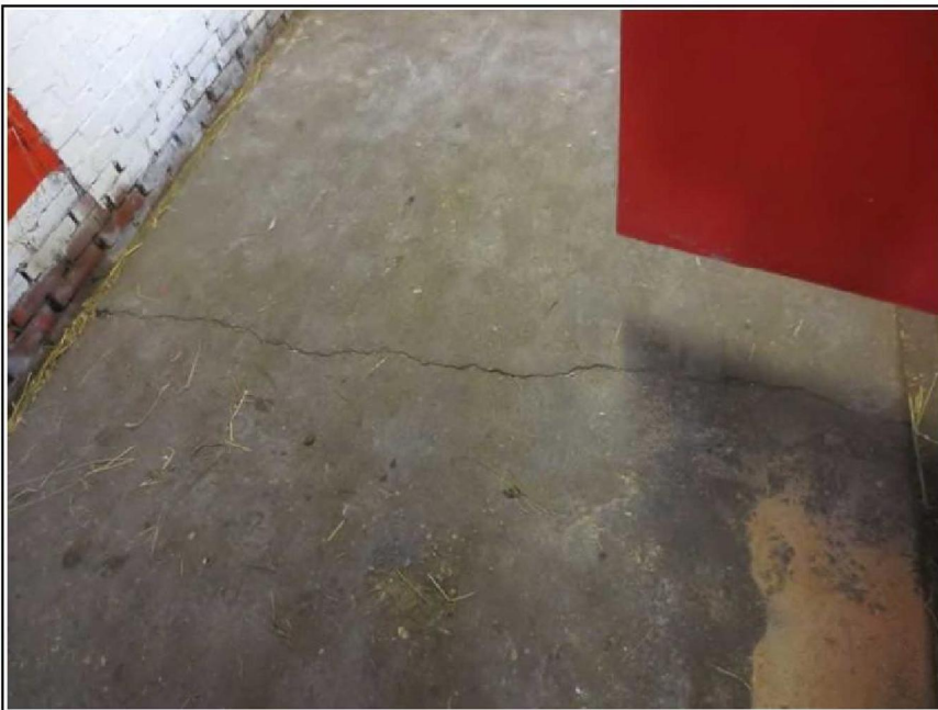
Schade 4, Bestaande scheurvorming in vloer. (IMG_8258)
