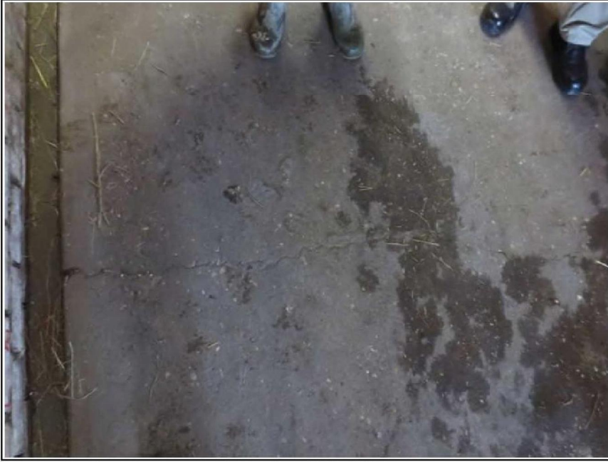
Schade 4, Bestaande scheurvorming in vloer. (IMG_8257)
