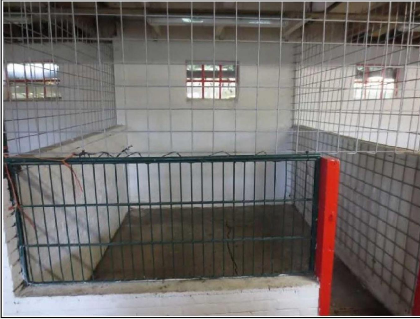
Schade 3, Scheurvorming in betonvloer. (IMG_8256)
