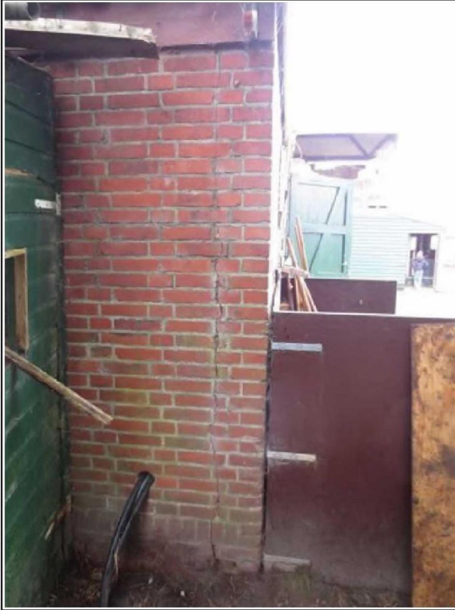
Schade 1, Bestaande scheurvorming in gevel metselwerk (IMG_8251)
