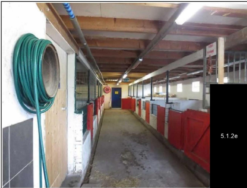
Schade 3, Scheurvorming in betonvloer. (IMG_8259)
