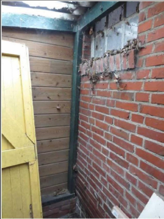
Schade 2, Scheurvorming in gevel metselwerk incl. gebroken stenen. (IMG_8252)
