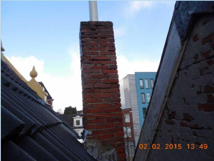
Foto 59.Schoorsteen intact, zie ook foto 6
