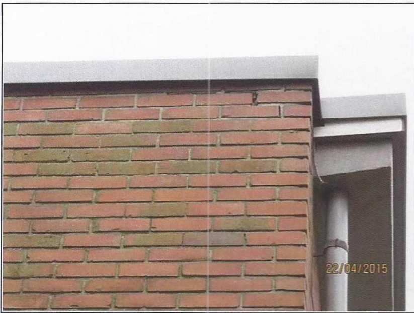
Schade 14, Horizontale scheuren en losse stenen (57784 22-4 (154))
