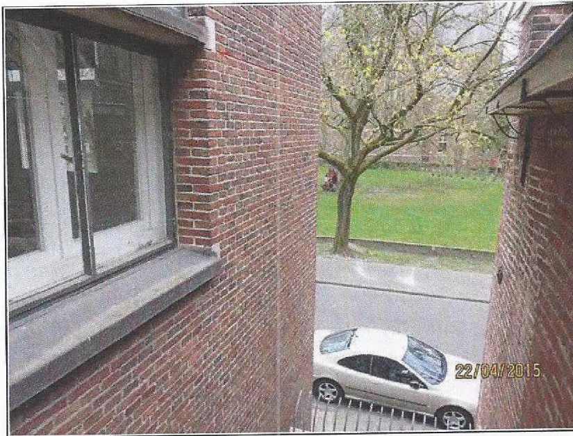
Schade 3, Verticale en horizontale scheuren (57784 22-4 (63))
