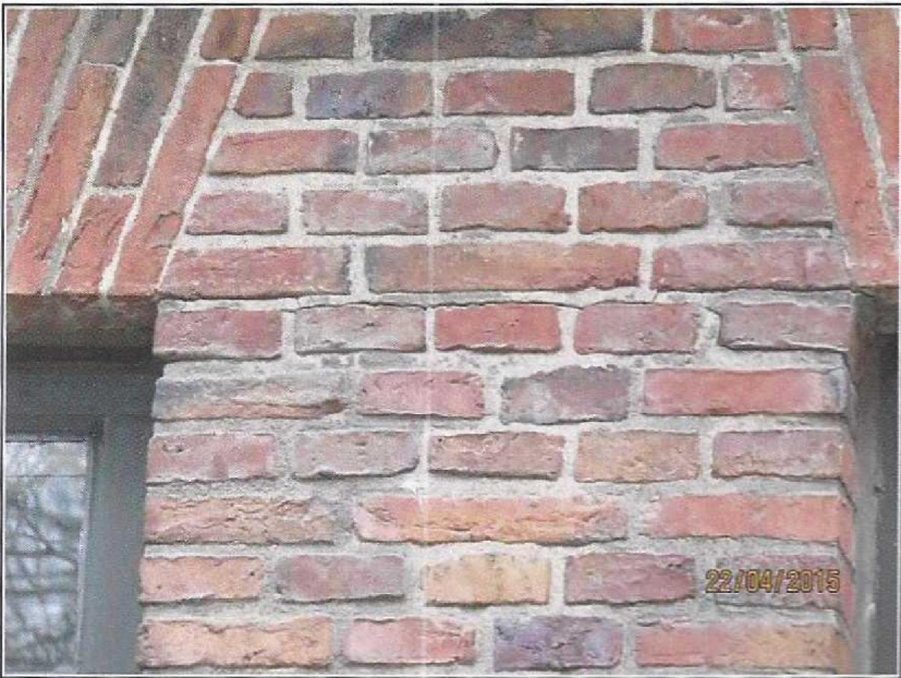
Schade 1, Horizontale scheur in de voeg. (57784 22-4 (19))
