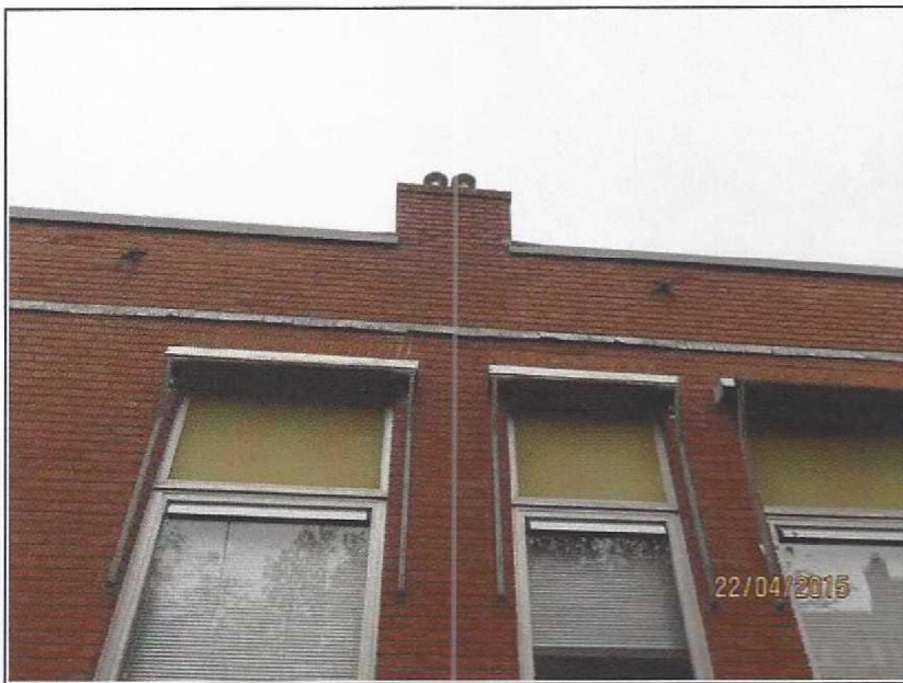
Schade 12, Horizontale scheuren en losse stenen (57784 22-4 (142))
