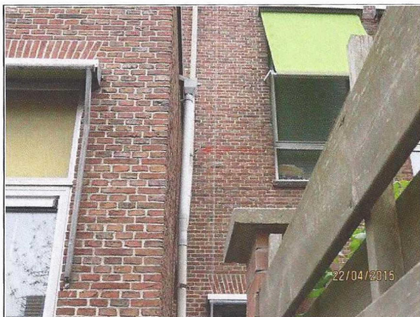
Schade 6, Getrapte scheur. (57784 22-4 (98))
