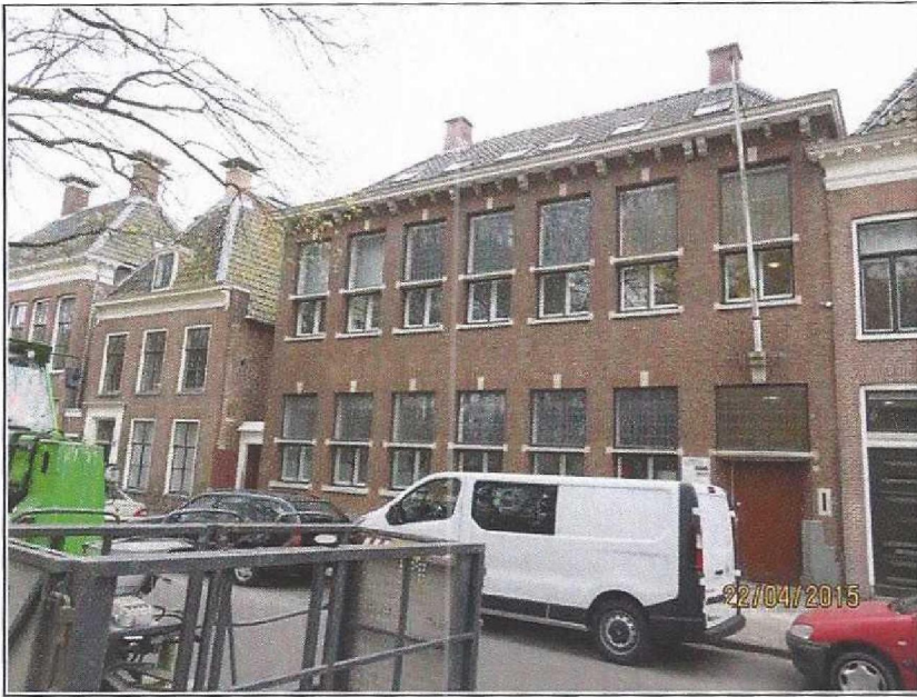
Schade 1, Horizontale scheur in de voeg. (57784 22-4 (4) voorgevel nr 28)
