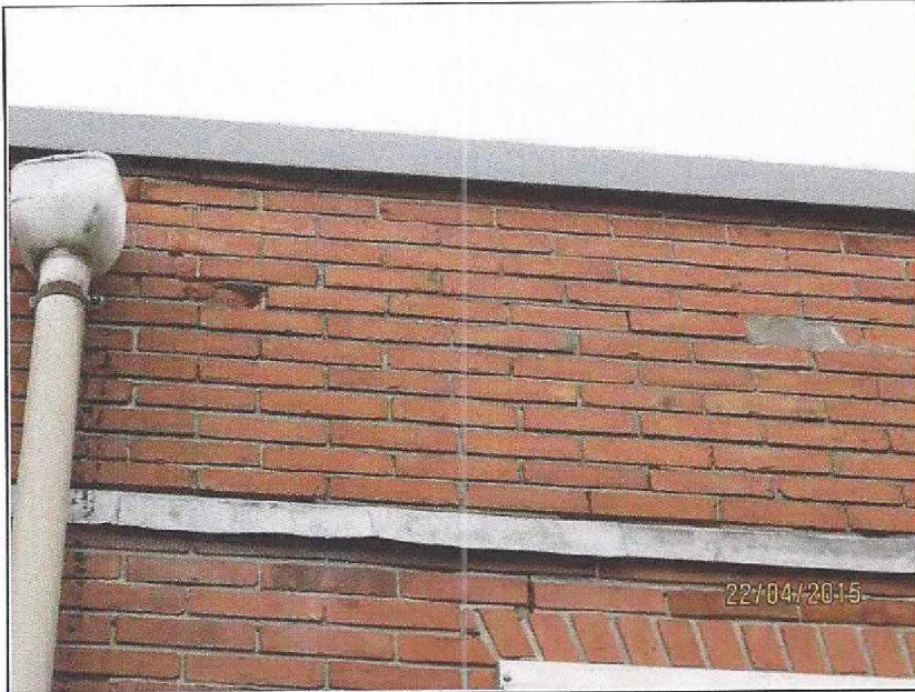
Schade 12, Horizontale scheuren en losse stenen (57784 22-4 (139))
