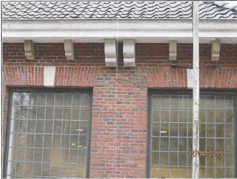
Schade 1, Horizontale scheur in de voeg. (57784 22-4 (10))
