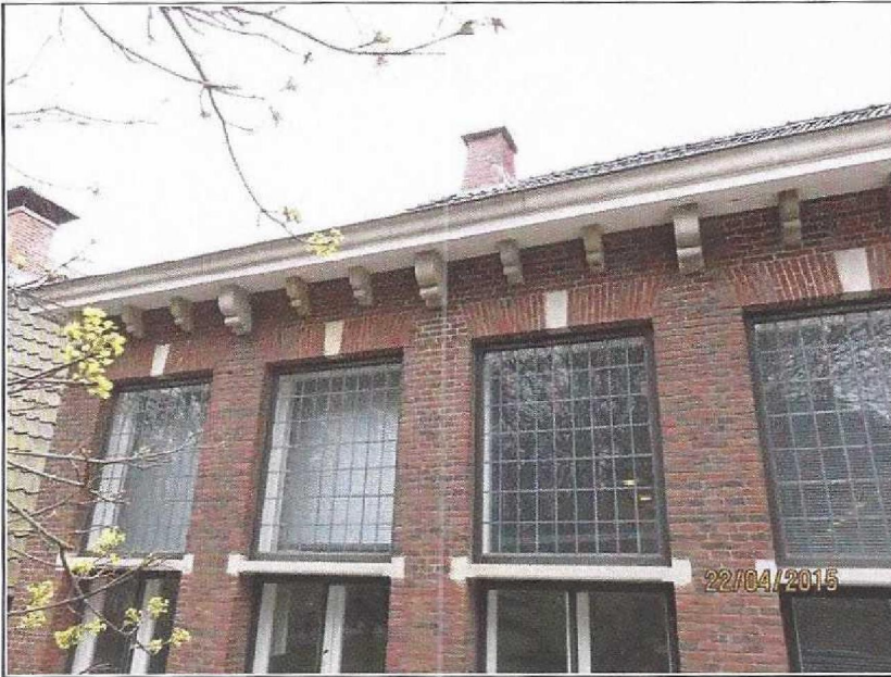
Schade 1, Horizontale scheur in de voeg. (57784 22-4 (34))
