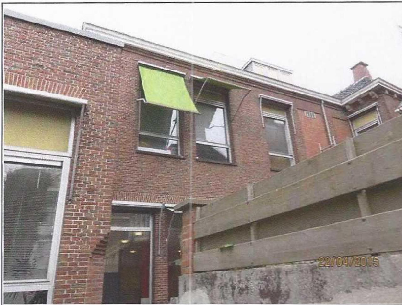
Schade 5, Horizontale scheur in de voeg. (57784 22-4 (89))
