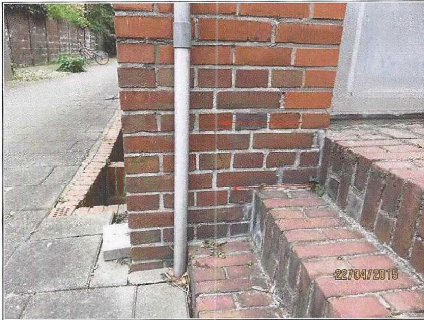
Schade 11, Diverse scheuren in voeg en stenen. (57784 22-4 (128))
