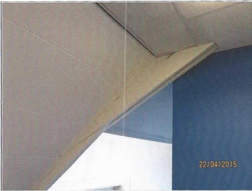
Schade 1, Horizontale scheur in de voeg. (57784 22-4 (204))
