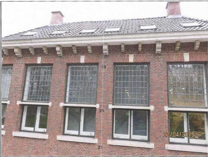
Schade 1, Horizontale scheur in de voeg. (57784 22-4 (17))
