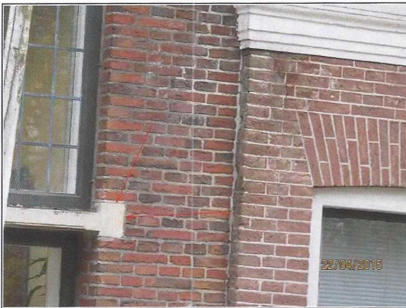
Schade 3, Verticale en horizontale scheuren (57784 22-4 (13))
