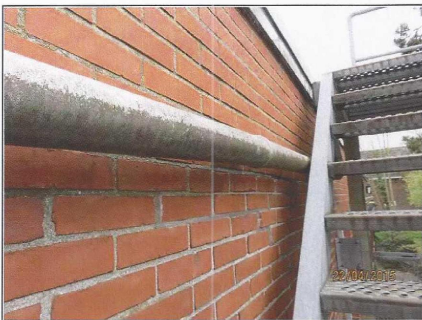
Schade 14, Horizontale scheuren en losse stenen (57784 22-4 (163))
