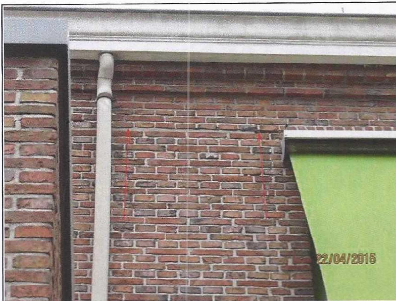
Schade 5, Horizontale scheur in de voeg. (57784 22-4 (91))
