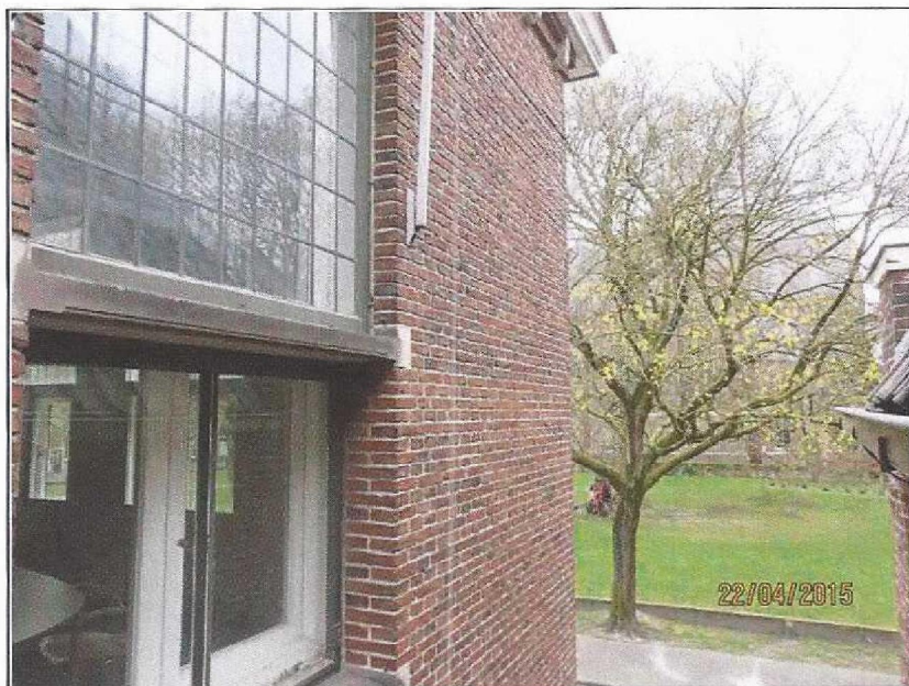
Schade 1, Horizontale scheur in de voeg. (57784 22-4 (62))
