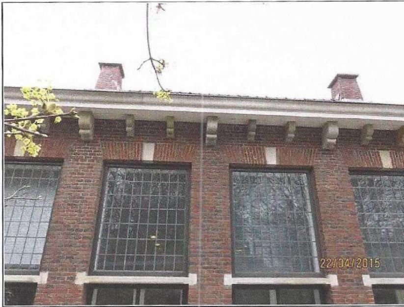
Schade 1, Horizontale scheur in de voeg. (57784 22-4 (30))
