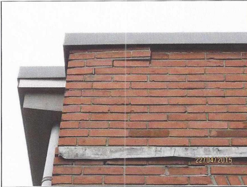
Schade 12, Horizontale scheuren en losse stenen (57784 22-4 (145))
