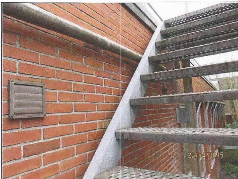
Schade 14, Horizontale scheuren en losse stenen (57784 22-4 (162))
