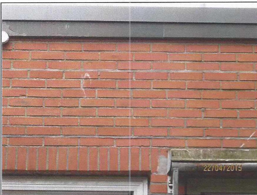
Schade 14, Horizontale scheuren en losse stenen (57784 22-4 (157))
