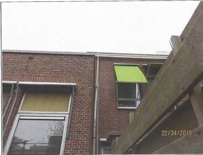
Schade 5, Horizontale scheur in de voeg. (57784 22-4 (90))
