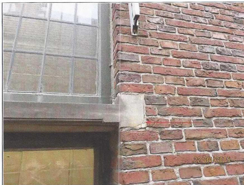
Schade 3, Verticale en horizontale scheuren (57784 22-4 (69))
