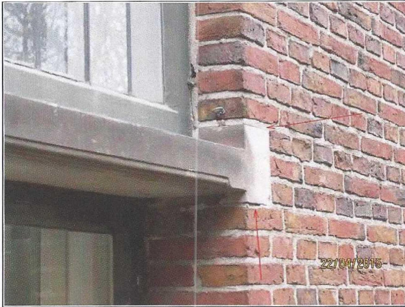
Schade 3, Verticale en horizontale scheuren (57784 22-4 (66))
