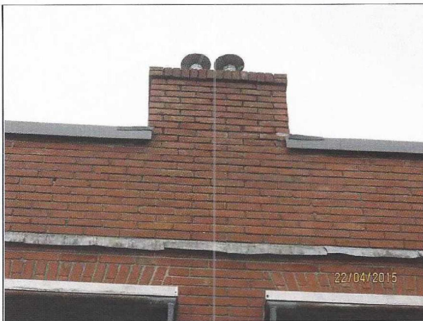
Schade 12, Horizontale scheuren en losse stenen (57784 22-4 (143))
