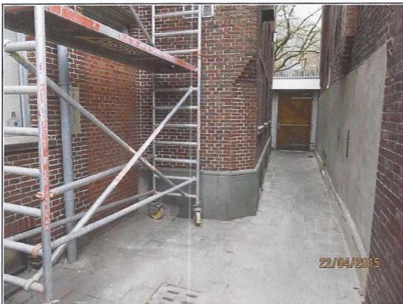
Schade 4, Verticale scheur in natuursteen plint (57784 22-4 (81))
