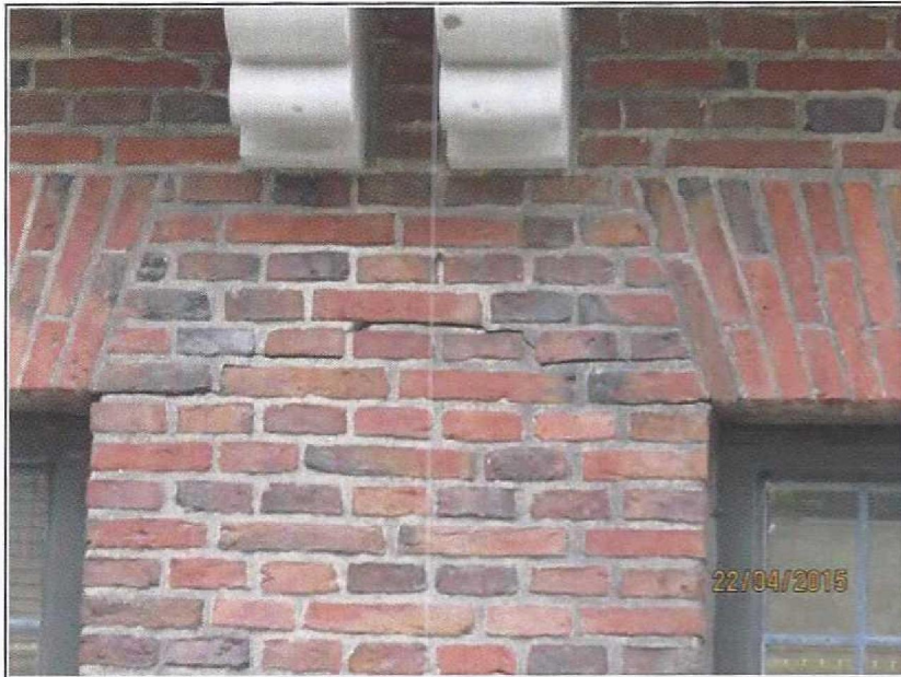
Schade 1, Horizontale scheur in de voeg. (57784 22-4 (11))
