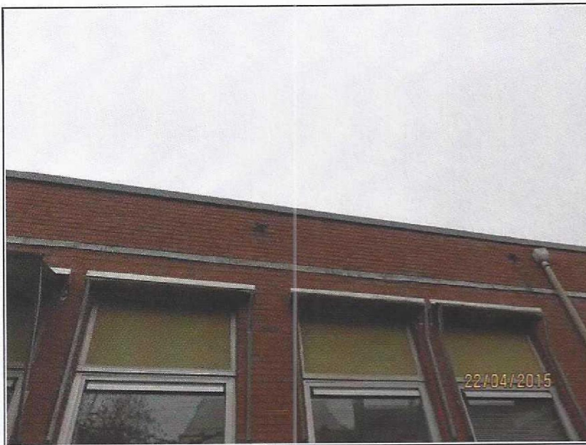
Schade 12, Horizontale scheuren en losse stenen (57784 22-4 (140))
