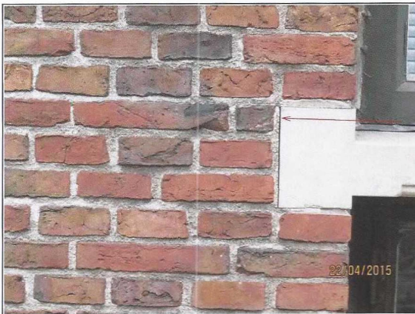
Schade 3, Verticale en horizontale scheuren (57784 22-4 (41))
