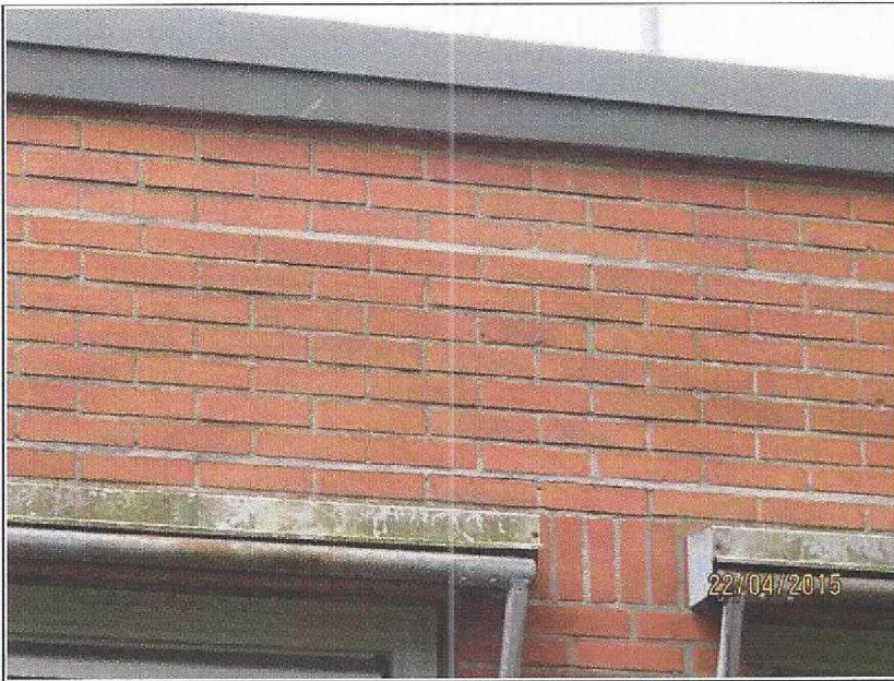
Schade 14, Horizontale scheuren en losse stenen (57784 22-4 (156))
