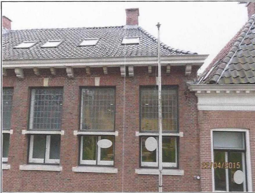
Schade 1, Horizontale scheur in de voeg. (57784 22-4 (5))
