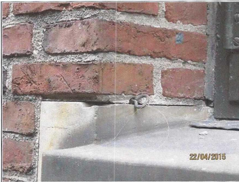
Schade 3, Verticale en horizontale scheuren (57784 22-4 (75))
