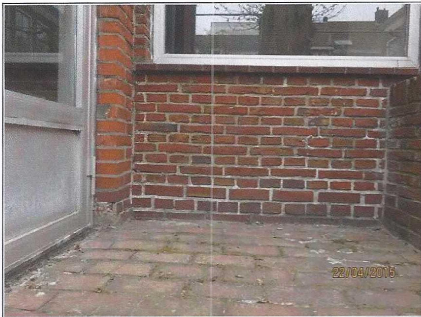
Schade 11, Diverse scheuren in voeg en stenen. (57784 22-4 (129))
