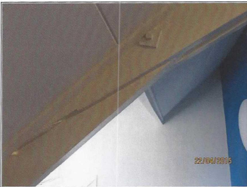
Schade 1, Horizontale scheur in de voeg. (57784 22-4 (205))
