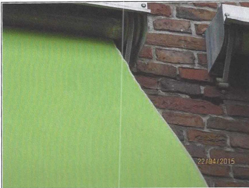
Schade 5, Horizontale scheur in de voeg. (57784 22-4 (93))
