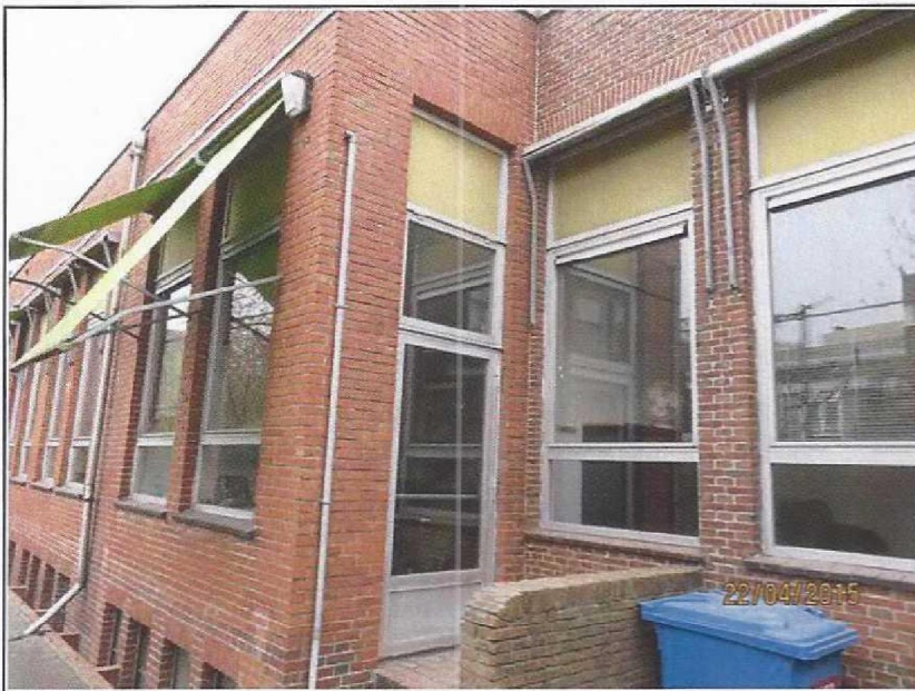
Schade 11, Diverse scheuren in voeg en stenen. (57784 22-4 (127))
