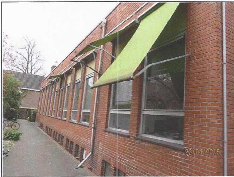
Schade 12, Horizontale scheuren en losse stenen (57784 22-4 (135))
