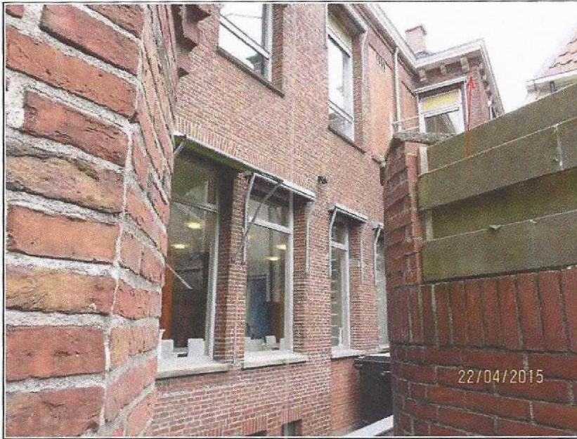
Schade 1, Horizontale scheur in de voeg. (57784 22-4 (88))
