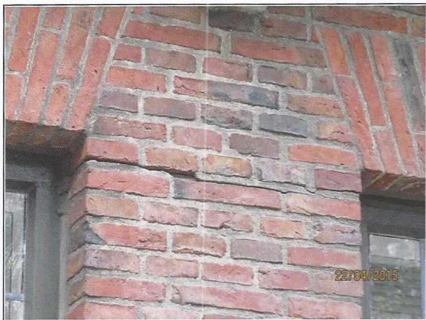
Schade 1, Horizontale scheur in de voeg. (57784 22-4 (39))
