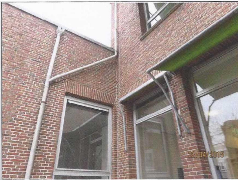
Schade 10, Verticale scheur in hoek aansluiting (57784 22-4 (119))
