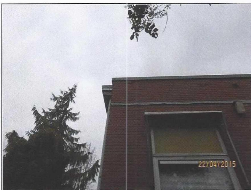
Schade 12, Horizontale scheuren en losse stenen (57784 22-4 (144))
