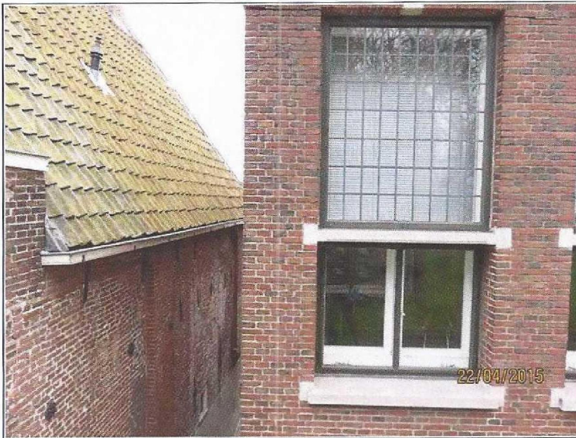
Schade 3, Verticale en horizontale scheuren (57784 22-4 (40))
