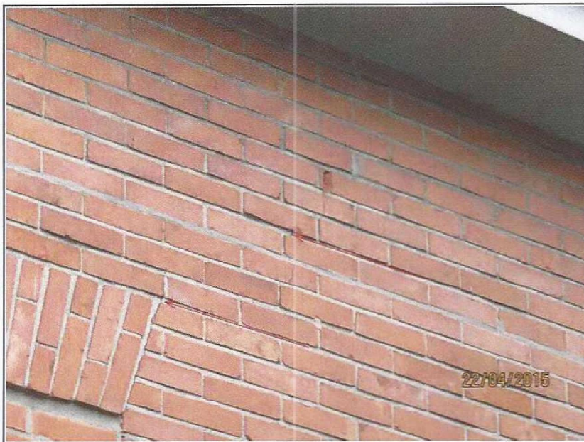
Schade 13, Verticale scheur door voegen en stenen (57784 22-4 (150))
