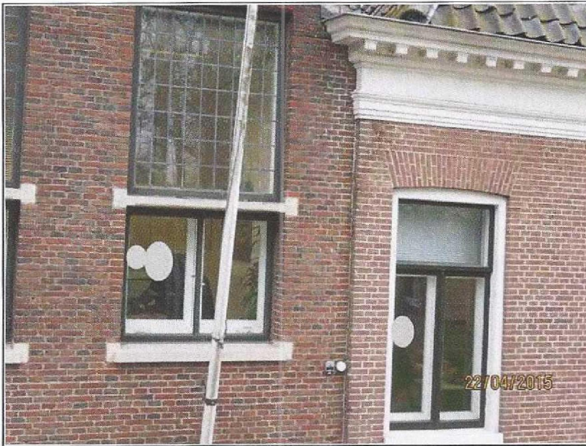
Schade 3, Verticale en horizontale scheuren (57784 22-4 (12))
