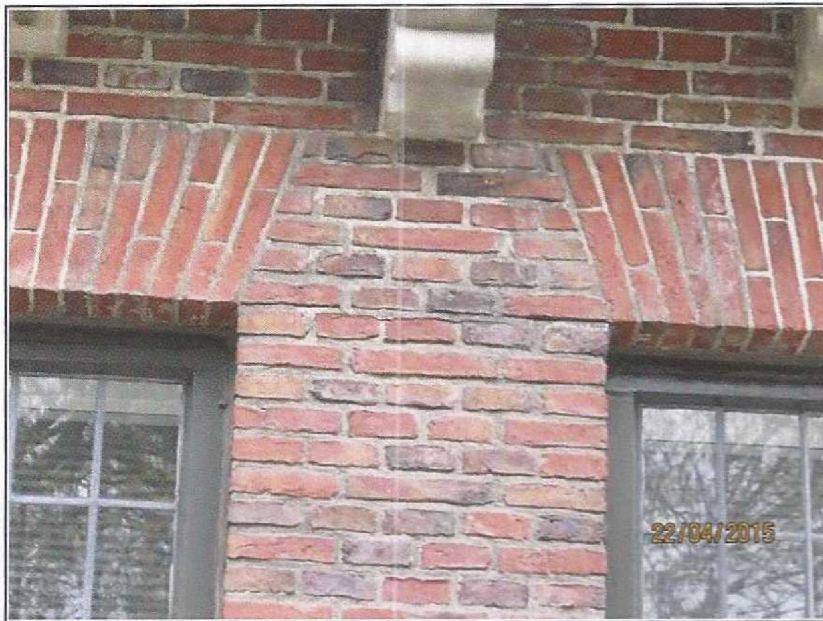
Schade 1, Horizontale scheur in de voeg. (57784 22-4 (31))
