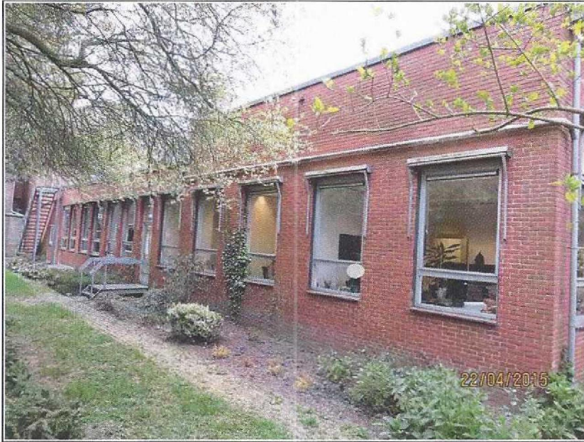
Schade 14, Horizontale scheuren en losse stenen (57784 22-4 (152))
