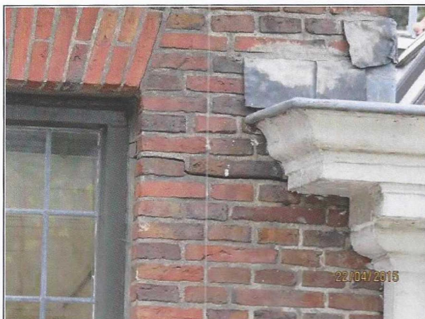
Schade 1, Horizontale scheur in de voeg. (57784 22-4 (7))
