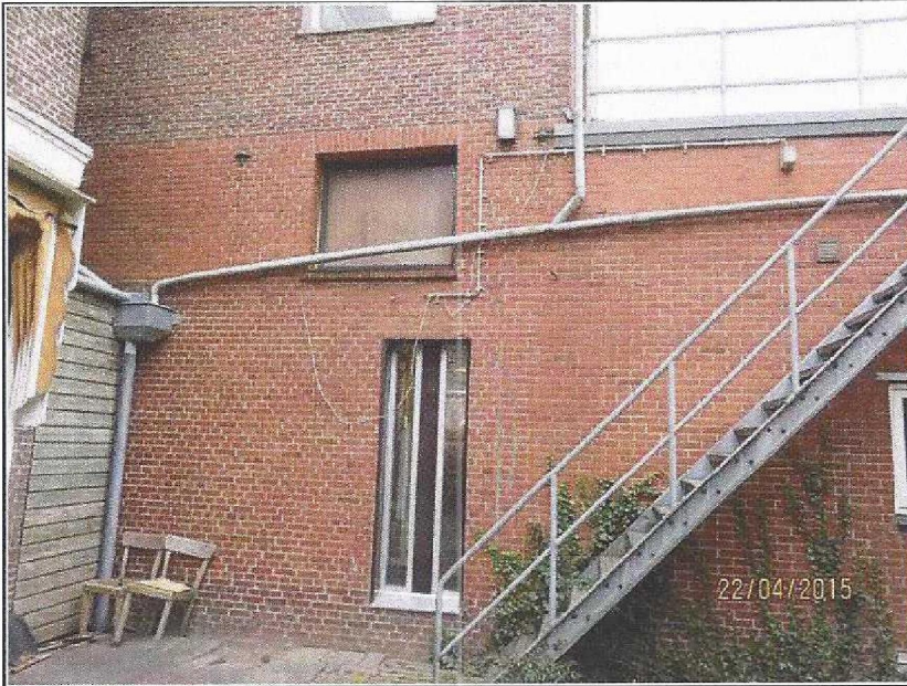
Schade 15, Verticale scheur door stenen en voegen (57784 22-4 (158))
