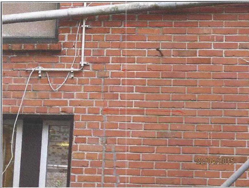
Schade 15, Verticale scheur door stenen en voegen (57784 22-4 (159))
