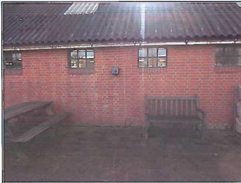
Schade 7, Scheurvorming in dilatatie. (IMG_1151)
