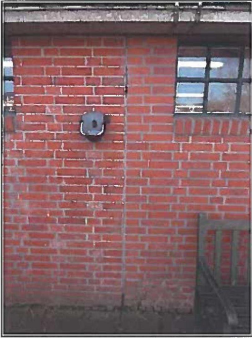
Schade 7, Scheurvorming in dilatatie. (IMG_1152)
