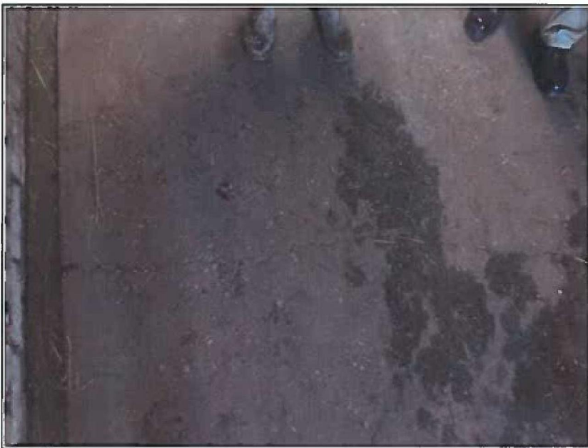
Schade 4, Bestaande scheurvorming in vloer. (IMG_8257)
