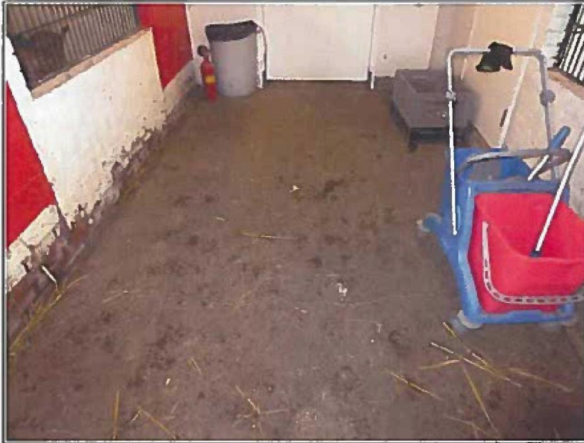
Schade 5, Scheurvorming in betonvloer. (IMG_1148)
