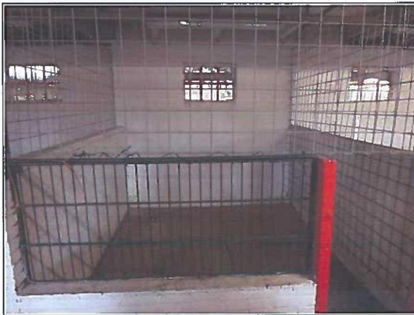
Schade 3, Scheurvorming in betonvloer. (IMG_8256)
