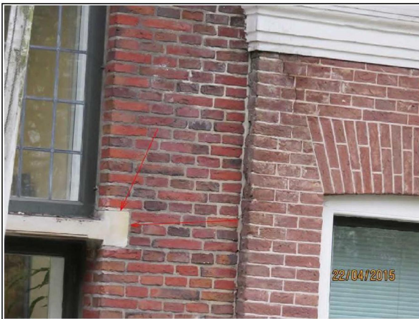
Schade 3, Verticale en horizontale scheuren (57784 22-4 (13))
