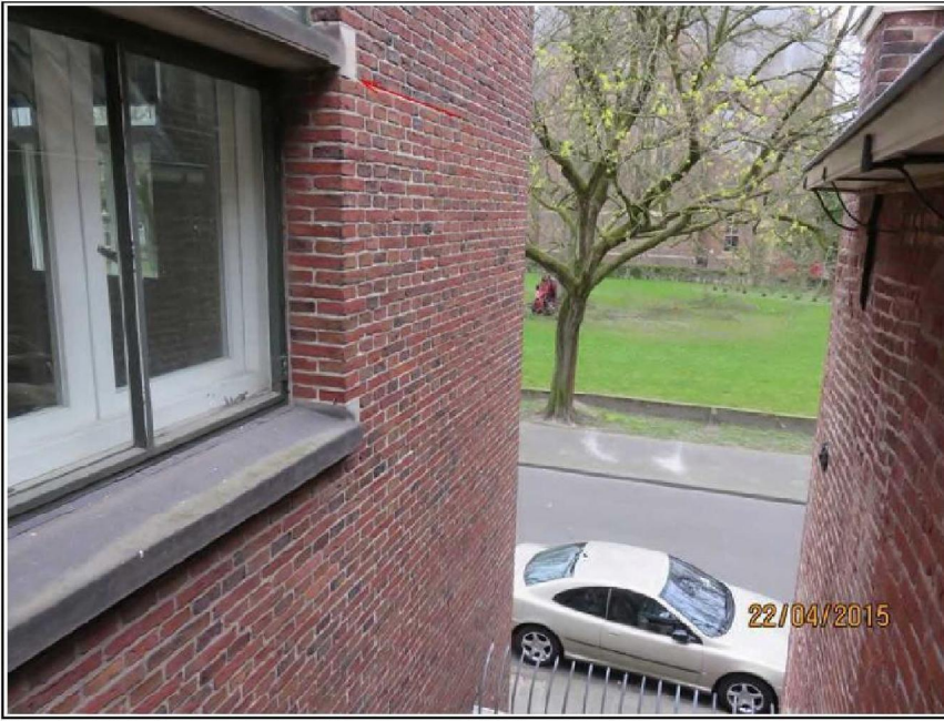
Schade 3, Verticale en horizontale scheuren (57784 22-4 (63))
