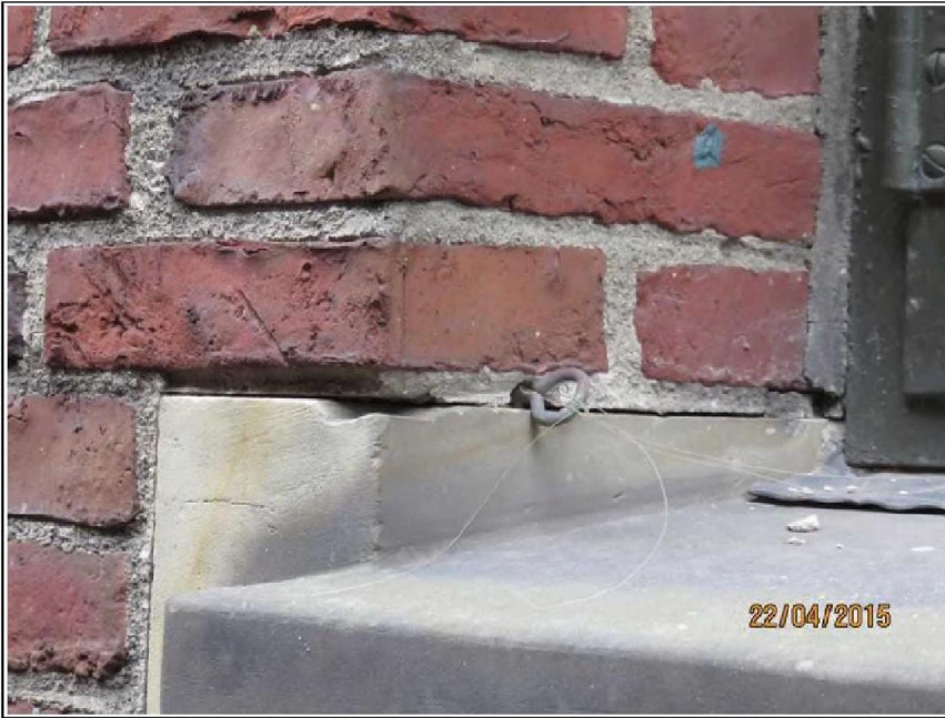
Schade 3, Verticale en horizontale scheuren (57784 22-4 (75))
