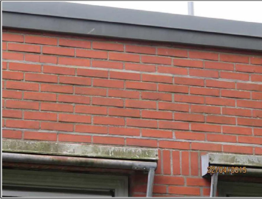
Schade 14, Horizontale scheuren en losse stenen (57784 22-4 (156))
