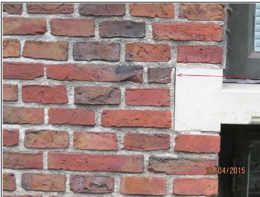
Schade 3, Verticale en horizontale scheuren (57784 22-4 (41))
