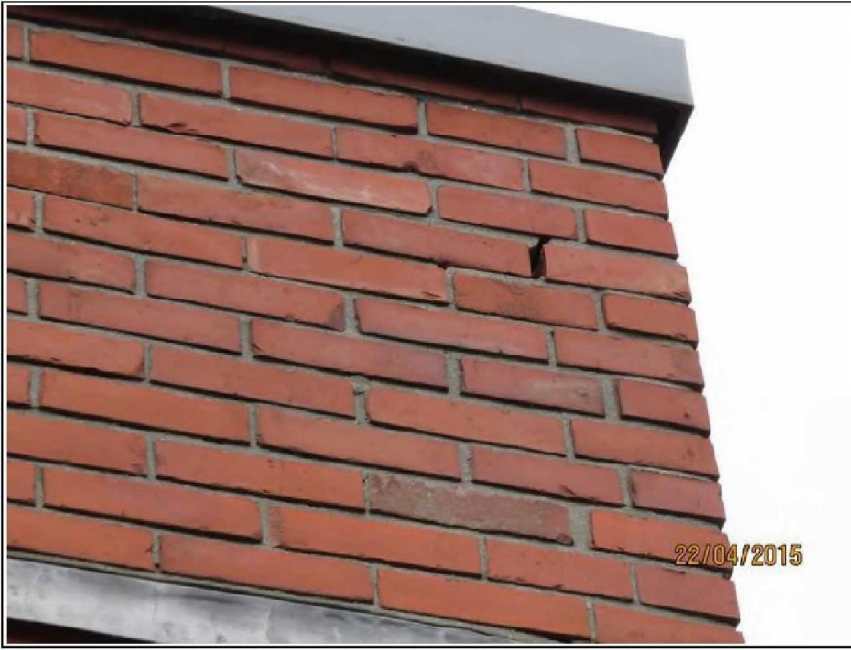
Schade 12, Horizontale scheuren en losse stenen (57784 22-4 (137))
