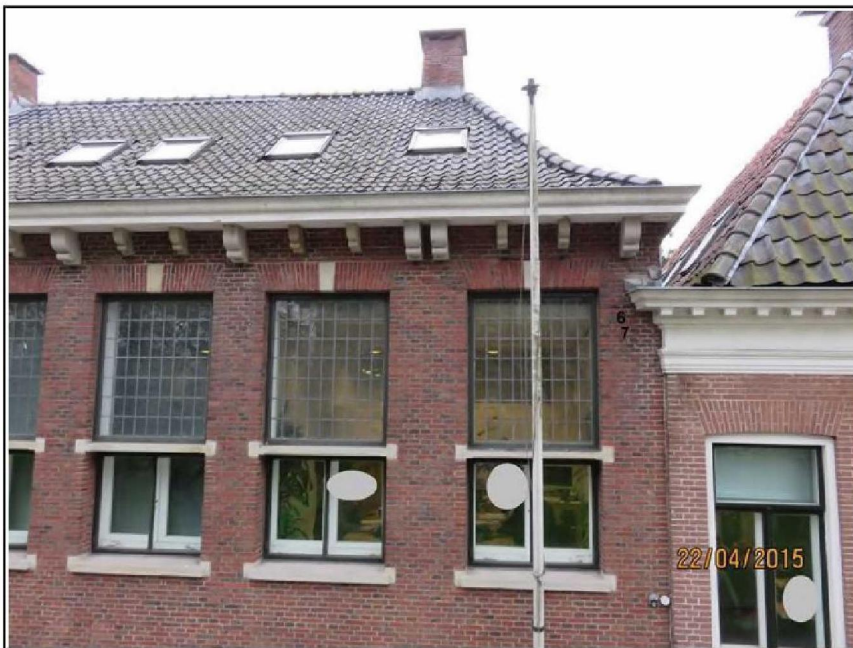
Schade 1, Horizontale scheur in de voeg. (57784 22-4 (5))
