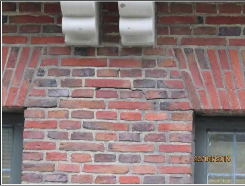
Schade 1, Horizontale scheur in de voeg. (57784 22-4 (11))
