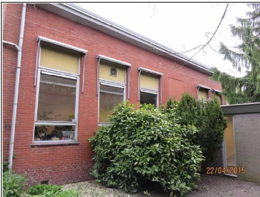
Schade 13, Verticale scheur door voegen en stenen (57784 22-4 (148))
