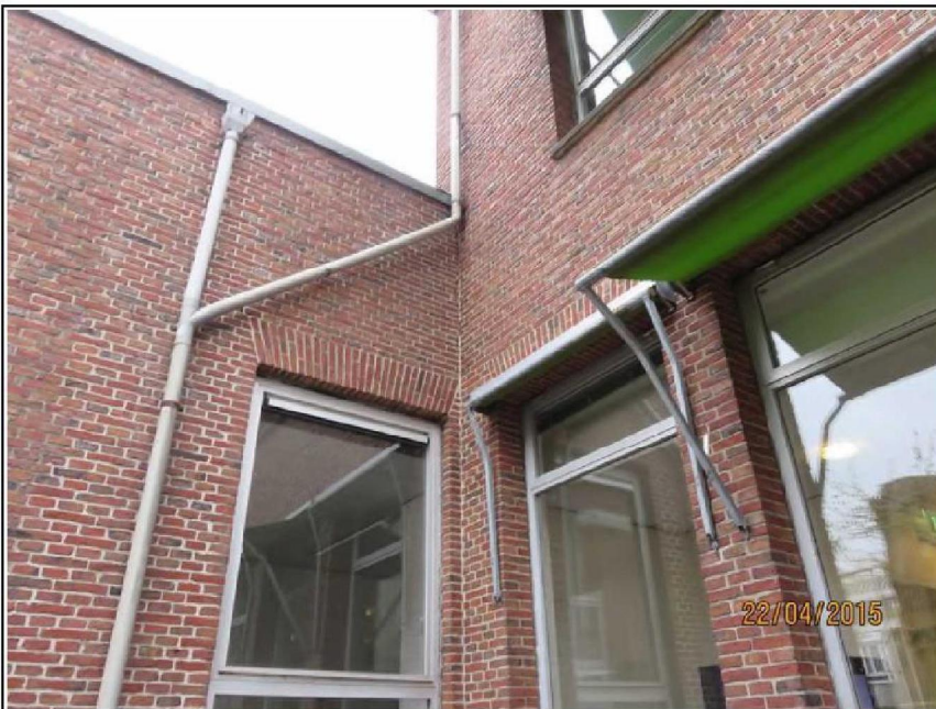
Schade 10, Verticale scheur in hoek aansluiting (57784 22-4 (119))
