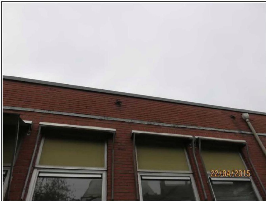
Schade 12, Horizontale scheuren en losse stenen (57784 22-4 (140))
