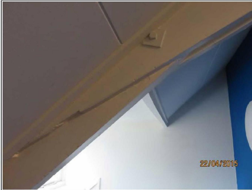
Schade 1, Horizontale scheur in de voeg. (57784 22-4 (205))
