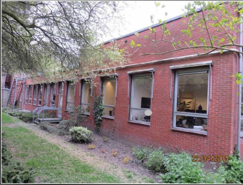
Schade 14, Horizontale scheuren en losse stenen (57784 22-4 (152))
