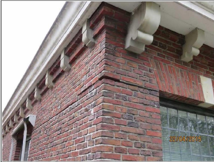
Schade 1, Horizontale scheur in de voeg. (57784 22-4 (48))
