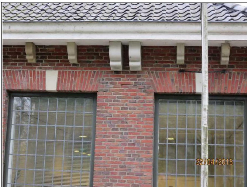
Schade 1, Horizontale scheur in de voeg. (57784 22-4 (10))
