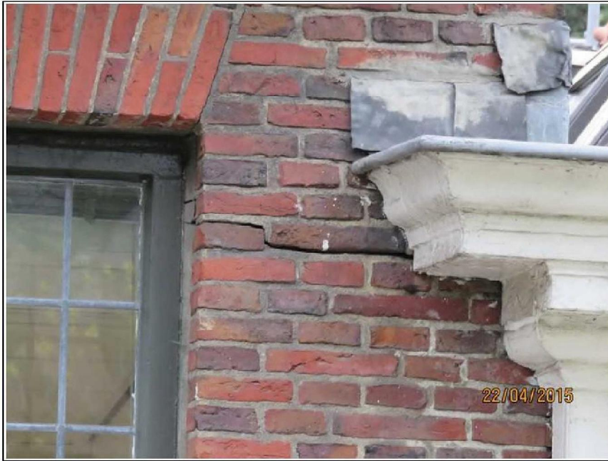
Schade 1, Horizontale scheur in de voeg. (57784 22-4 (7))
