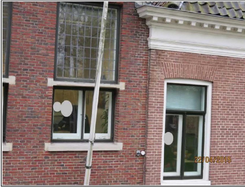
Schade 3, Verticale en horizontale scheuren (57784 22-4 (12))
