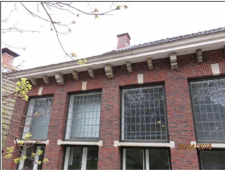
Schade 1, Horizontale scheur in de voeg. (57784 22-4 (34))
