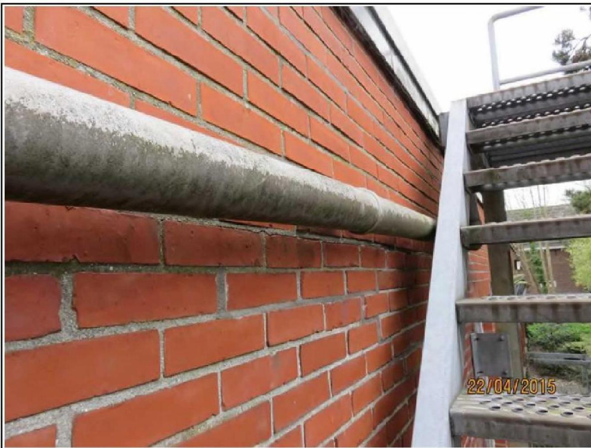
Schade 14, Horizontale scheuren en losse stenen (57784 22-4 (163))
