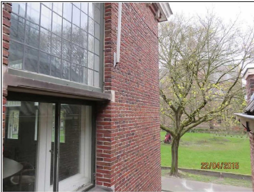
Schade 1, Horizontale scheur in de voeg. (57784 22-4 (62))
