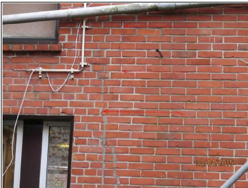
Schade 15, Verticale scheur door stenen en voegen (57784 22-4 (159))
