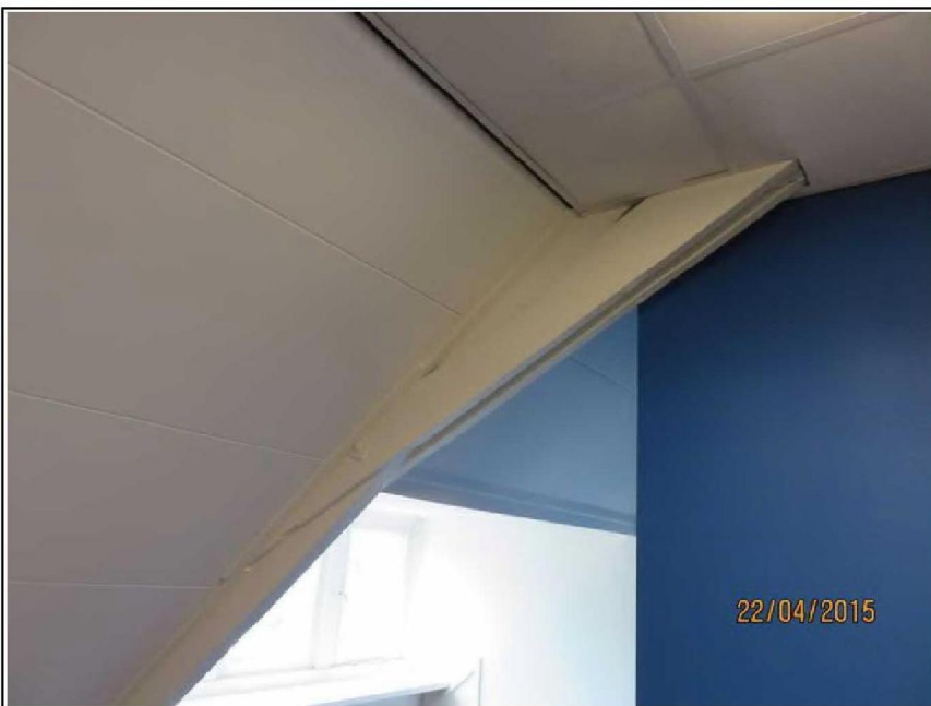
Schade 1, Horizontale scheur in de voeg. (57784 22-4 (204))
