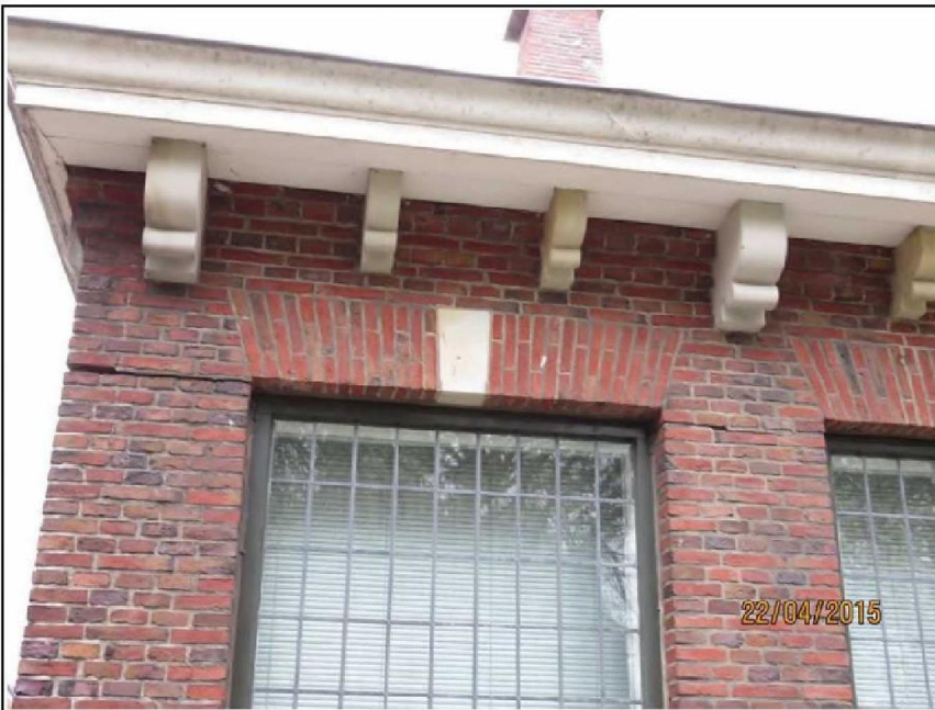
Schade 1, Horizontale scheur in de voeg. (57784 22-4 (37))
