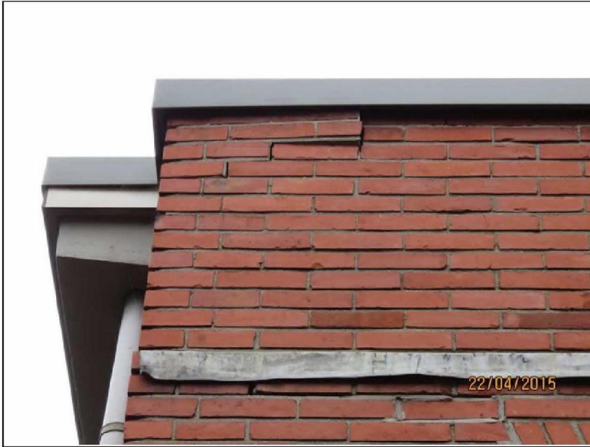
Schade 12, Horizontale scheuren en losse stenen (57784 22-4 (145))
