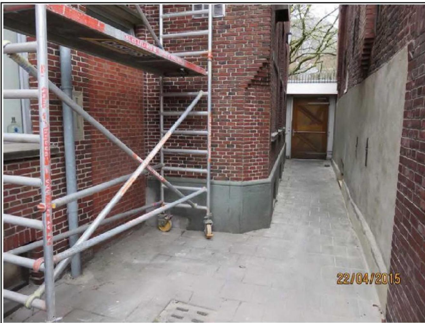
Schade 4, Verticale scheur in natuursteen plint (57784 22-4 (81))
