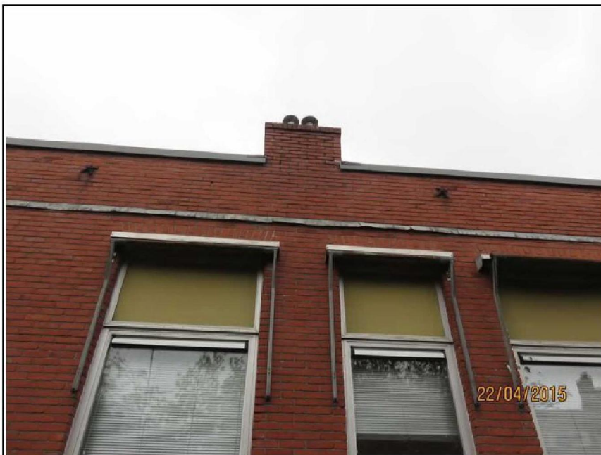
Schade 12, Horizontale scheuren en losse stenen (57784 22-4 (142))
