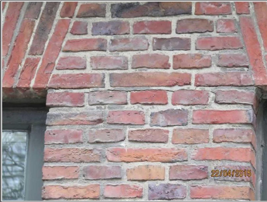
Schade 1, Horizontale scheur in de voeg. (57784 22-4 (19))
