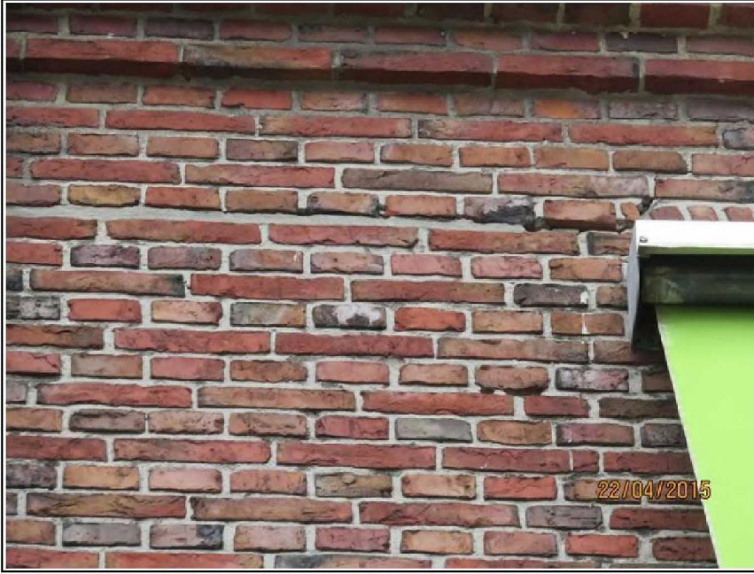
Schade 5, Horizontale scheur in de voeg. (57784 22-4 (92))
