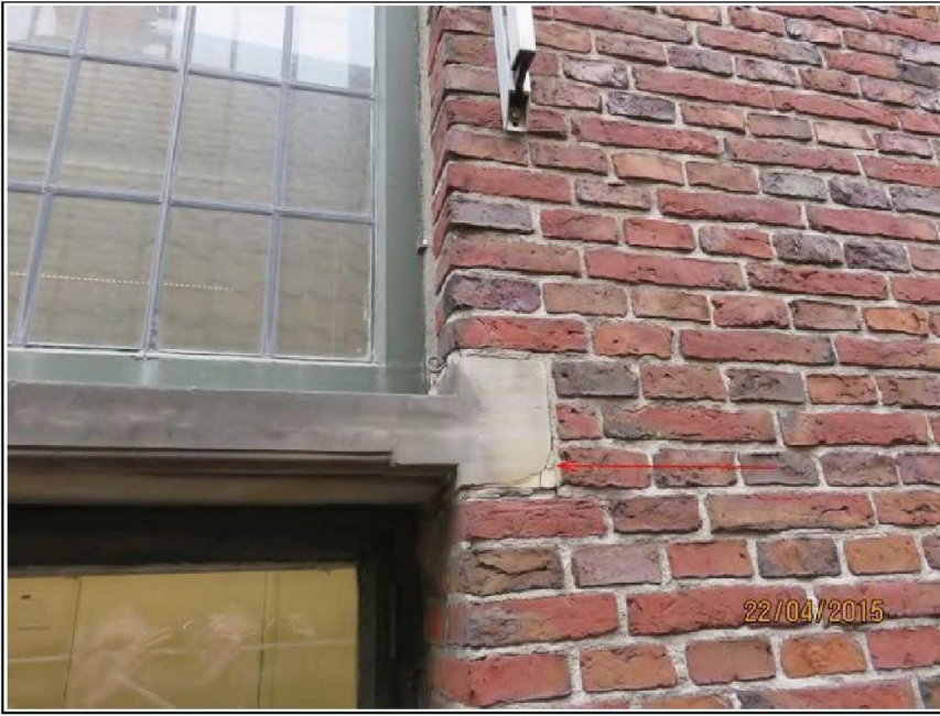
Schade 3, Verticale en horizontale scheuren (57784 22-4 (69))
