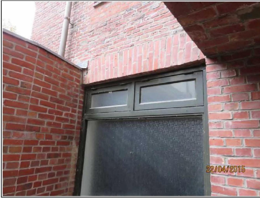
Schade 8, Scheurvorming in metselwerk (57784 22-4 (108))
