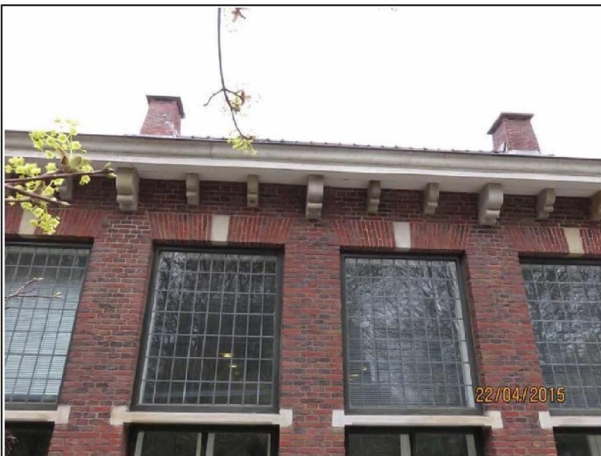
Schade 1, Horizontale scheur in de voeg. (57784 22-4 (30))
