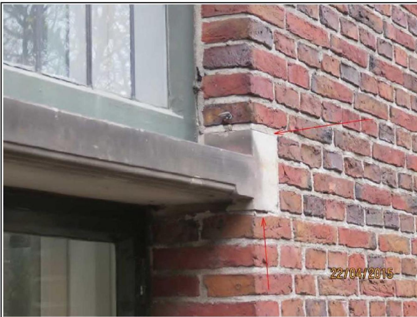
Schade 3, Verticale en horizontale scheuren (57784 22-4 (66))
