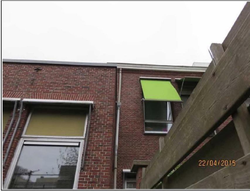
Schade 5, Horizontale scheur in de voeg. (57784 22-4 (90))
