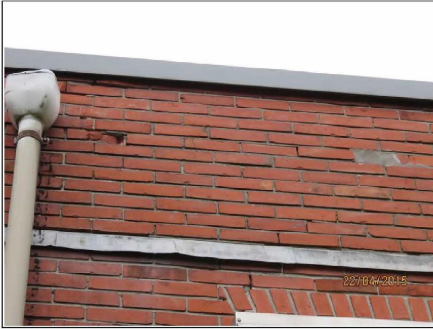
Schade 12, Horizontale scheuren en losse stenen (57784 22-4 (139))
