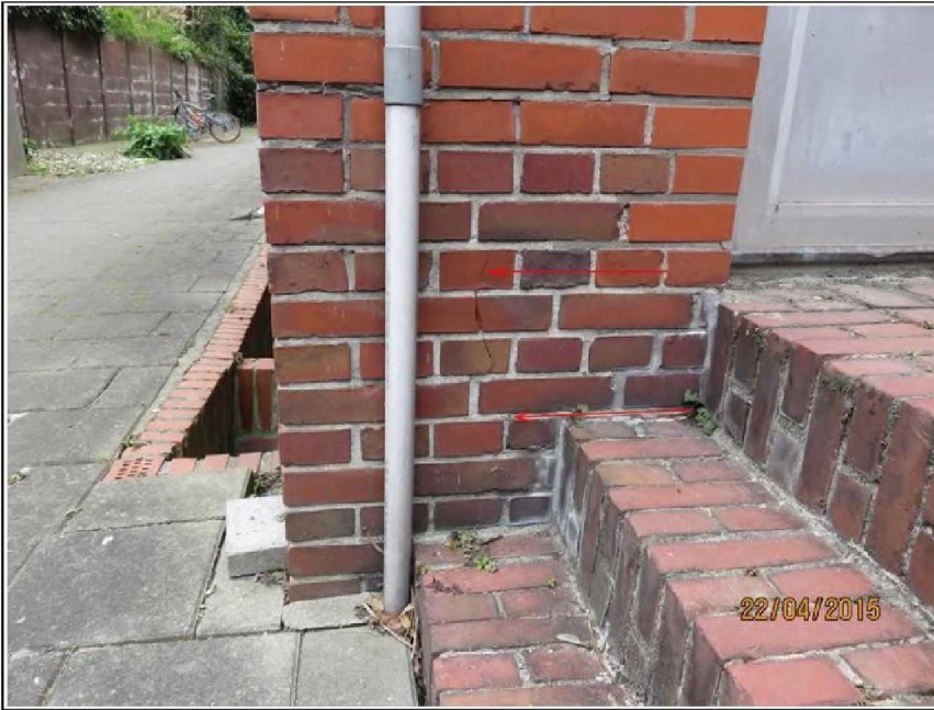
Schade 11, Diverse scheuren in voeg en stenen. (57784 22-4 (128))
