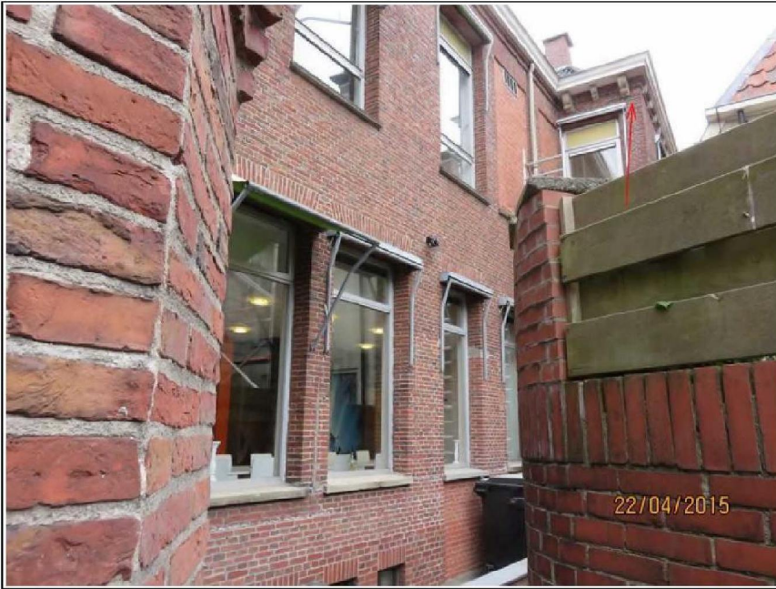
Schade 1, Horizontale scheur in de voeg. (57784 22-4 (88))
