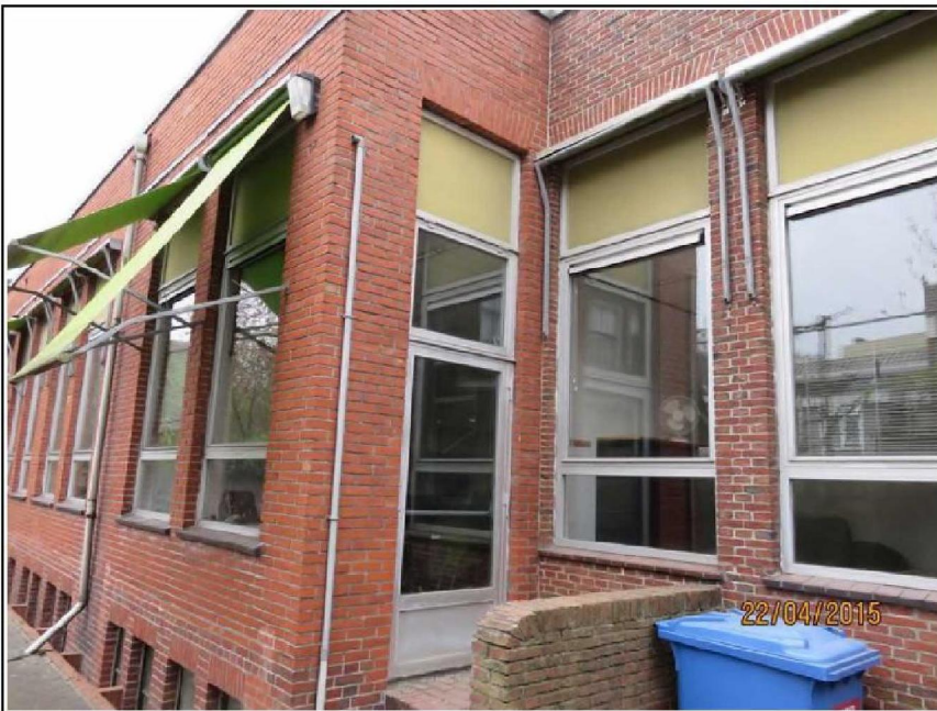
Schade 11, Diverse scheuren in voeg en stenen. (57784 22-4 (127))
