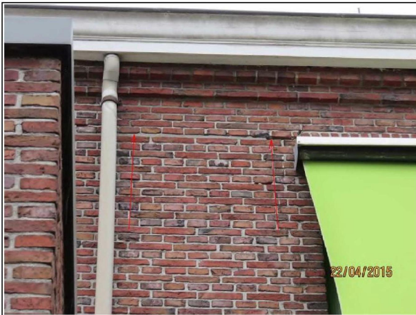
Schade 5, Horizontale scheur in de voeg. (57784 22-4 (91))
