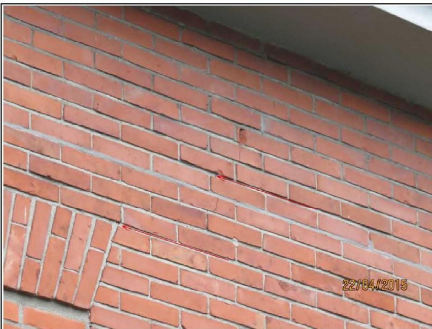
Schade 13, Verticale scheur door voegen en stenen (57784 22-4 (150))
