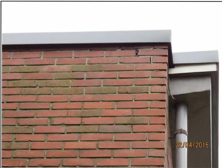
Schade 14, Horizontale scheuren en losse stenen (57784 22-4 (154))
