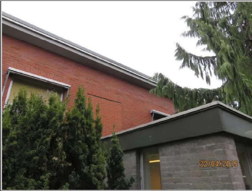
Schade 13, Verticale scheur door voegen en stenen (57784 22-4 (149))
