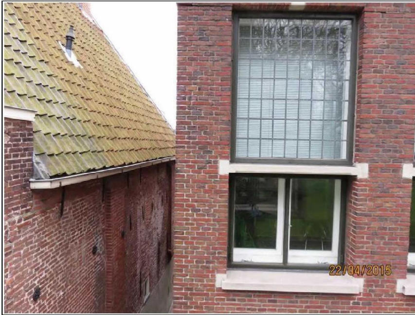
Schade 3, Verticale en horizontale scheuren (57784 22-4 (40))
