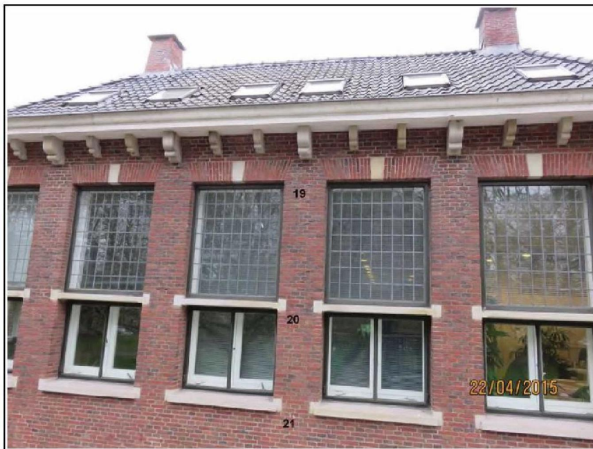
Schade 1, Horizontale scheur in de voeg. (57784 22-4 (17))
