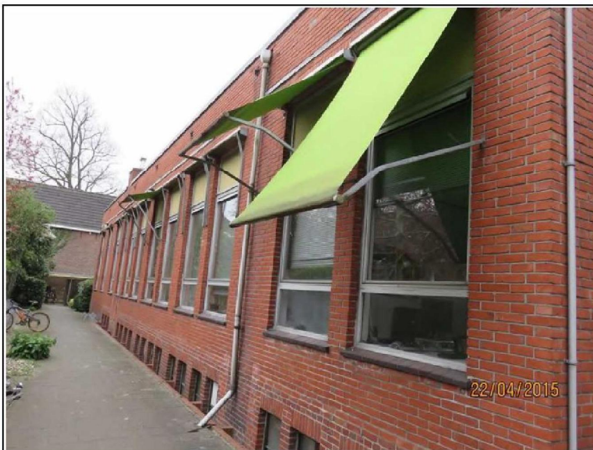
Schade 12, Horizontale scheuren en losse stenen (57784 22-4 (135))
