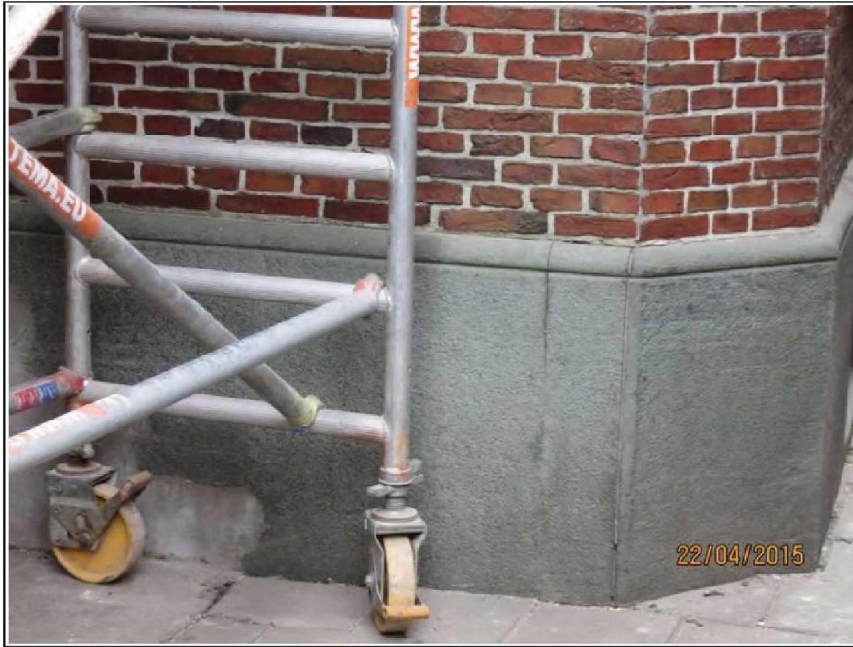
Schade 4, Verticale scheur in natuursteen plint (57784 22-4 (82))
