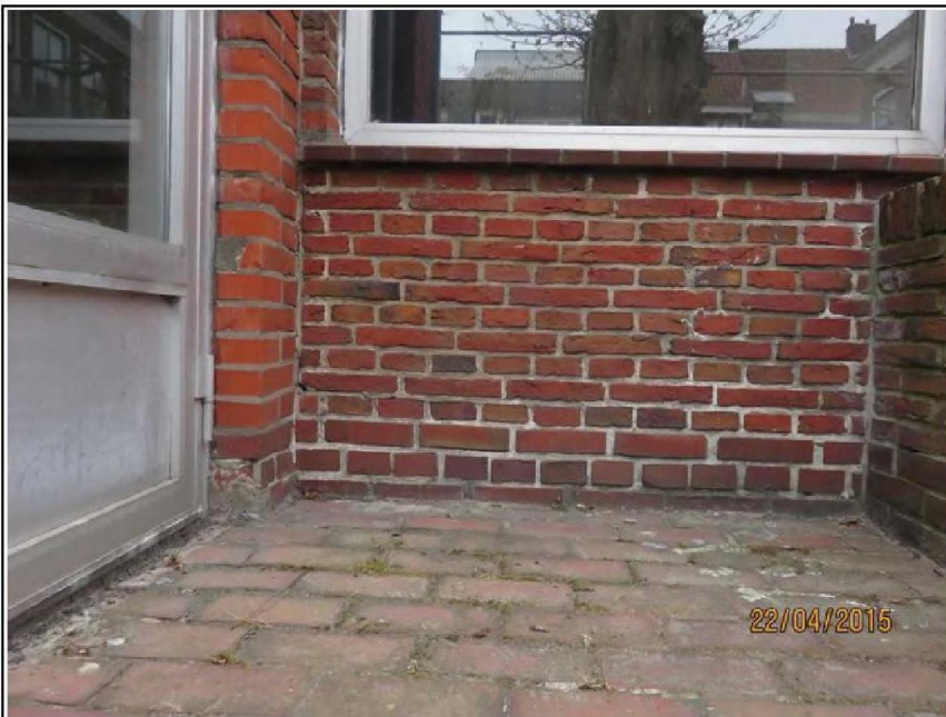
Schade 11, Diverse scheuren in voeg en stenen. (57784 22-4 (129))
