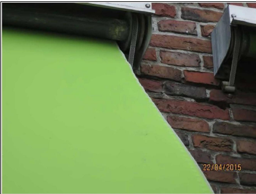
Schade 5, Horizontale scheur in de voeg. (57784 22-4 (93))
