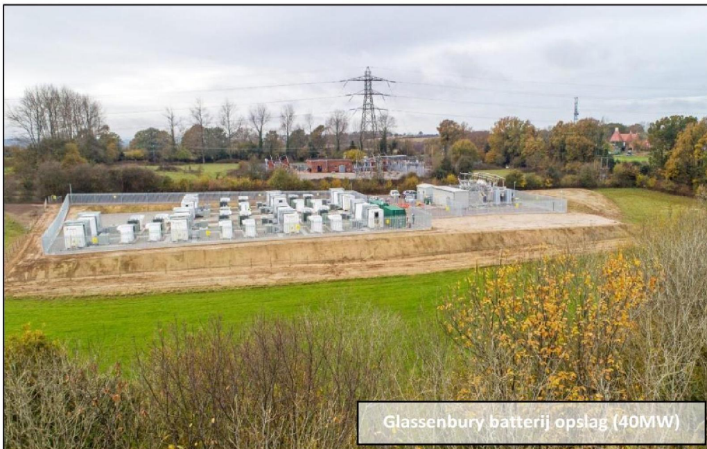
Afbeelding 6. De grootschalige batterij opslag bij Glassenbury; de foto is direct na de aanleg genomen. De opslag is nog niet landschappelijk ingepast.
